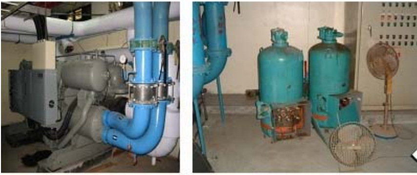
圖2 臺中榮民總醫院嘉義分院建築節能改善—改善前後冰水主機調整
