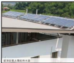
屋頂設置太陽能熱水器
