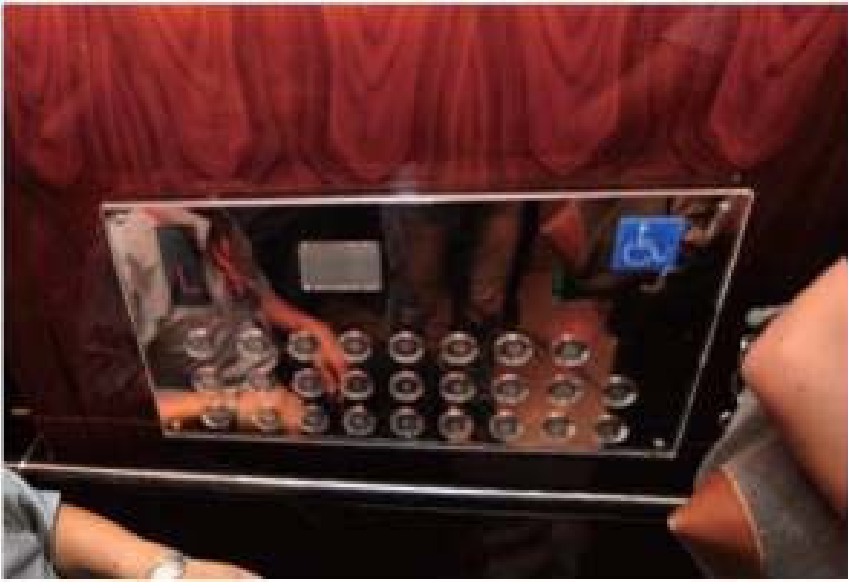
圖2 無障礙電梯之操作面板及扶手
