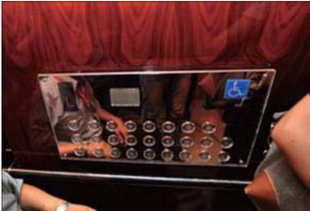
圖1 無障礙電梯之操作面板及扶手
