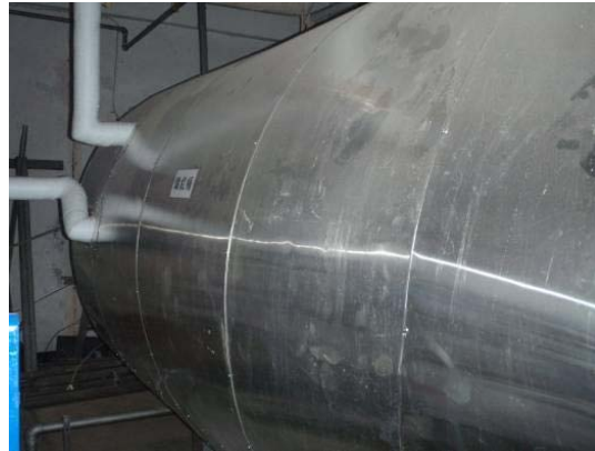
圖4 熱泵系統之儲熱水槽設備
