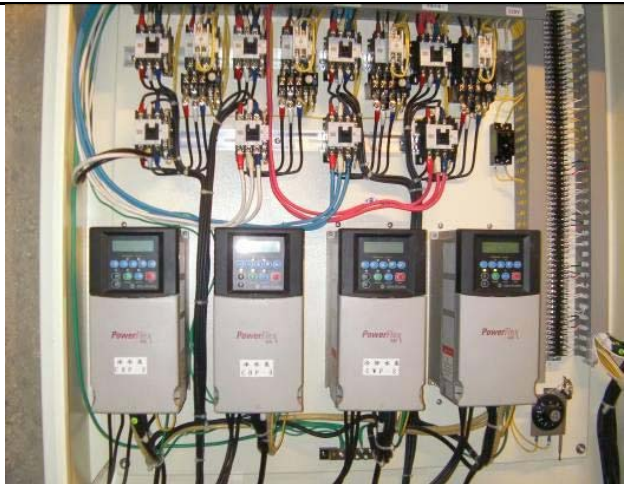
新設之變頻器
