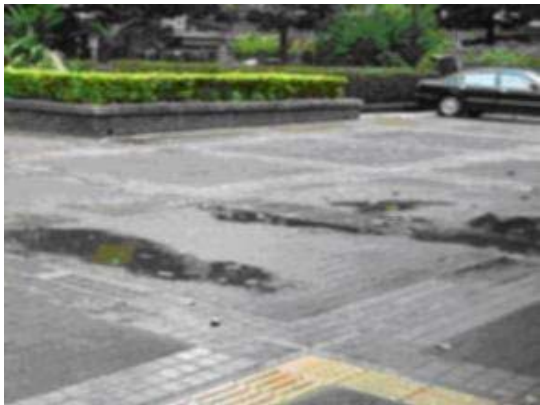
鋪面不平整遇雨常積水
