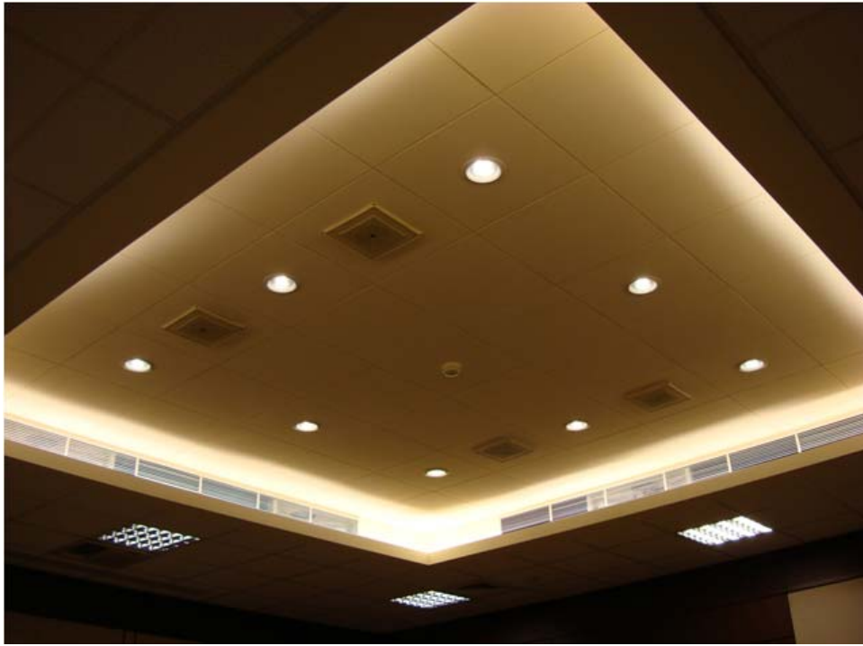
圖3 277會議室照明節能改善
