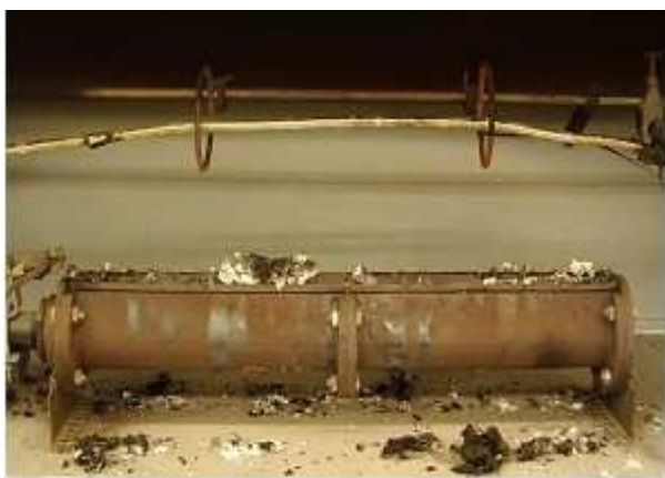
圖3 絕緣層剝落遮蔽燃燒器噴口
