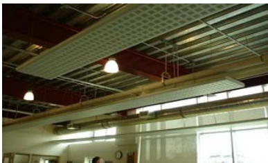
圖3 地熱交換室內熱交換設備
