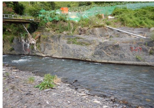
Y-29 斷面左岸為岩盤，右岸則有土砂堆積
