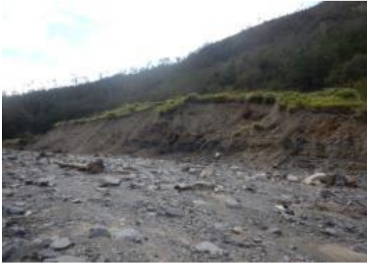
右岸土砂堆置處有滑落情形
