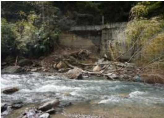
近護岸河岸崩塌，且護岸裂縫產生
