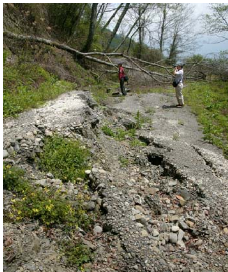
照片 4.43 路面階梯狀塌陷多發生於路面較窄之填方路段。
