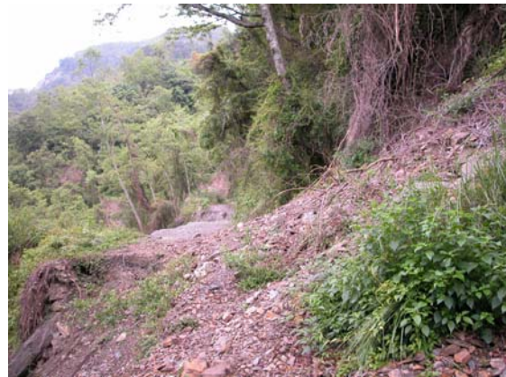
照片 3.106 上坡崩塌受損路段— 基岩崩塌。(3.1.20)
