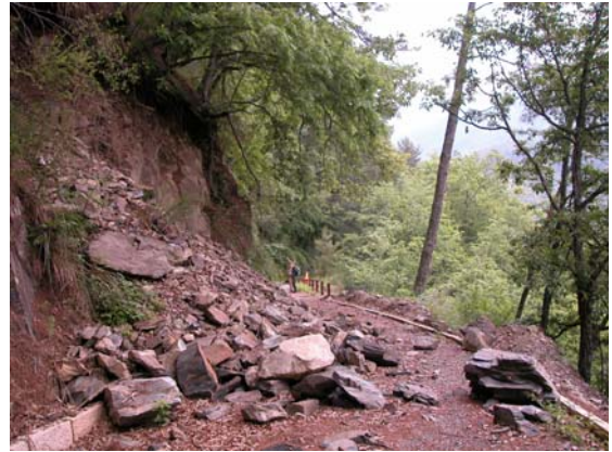
照片 3.109 上坡崩塌受損路段— 基岩崩塌。(3.1.22)
