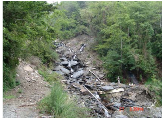
照片 3.79 溝谷口受損路段— 路面淤積。(4.2.7)
