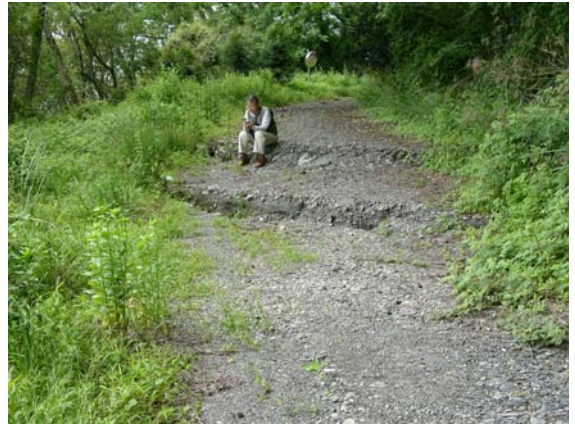
照片 3.38 路面受損路段— 路面龜裂。(2.1.3)
