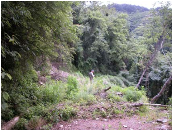
照片 3.121 上坡崩塌受損路段— 基岩崩塌。(3.1.27)
