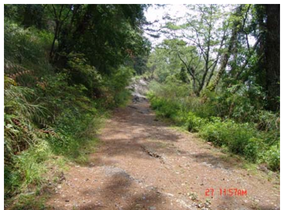
照片 3.47 路面受損路段一 路面龜裂。(2.1.4)
