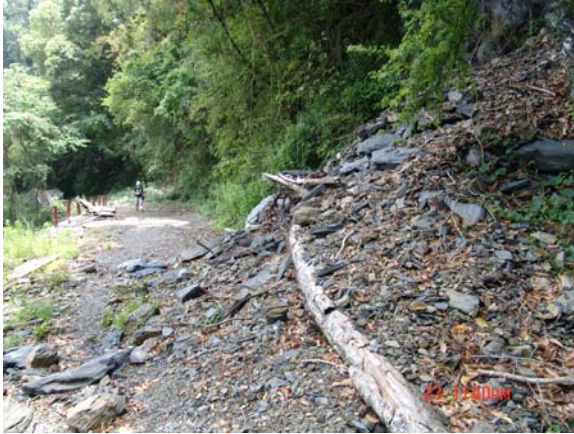
照片 2.6 基岩崩塌受損路段。
