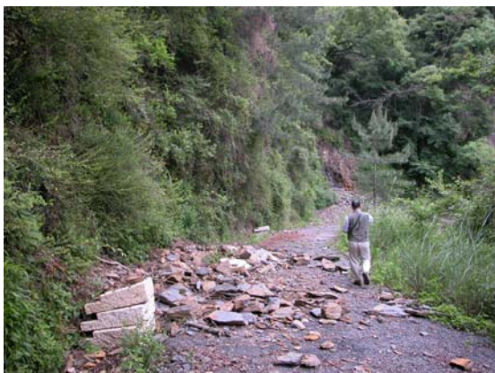
照片 3.91 上坡崩塌受損路段— 基岩崩塌。(3.1.17)
