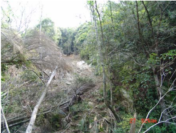
照片 2.8 岩屑滑落受損路段。
