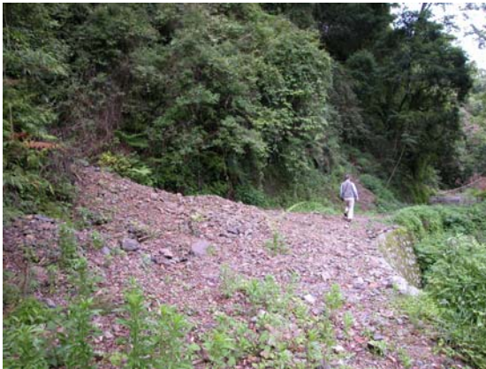
照片 3.99 溝谷口受損路段— 路面淤積。(4.2.14)
