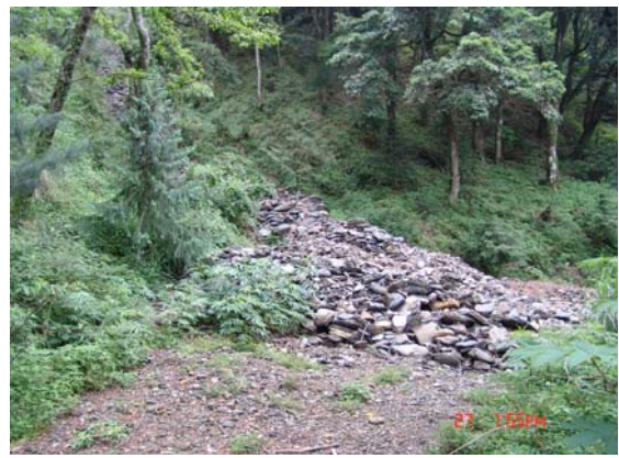
照片 3.62 溝谷口受損路段— 路面淤積。(4.2.3)
