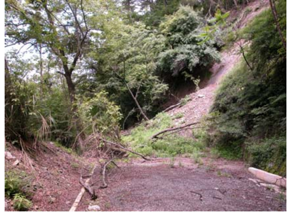
照片 3.122 上坡崩塌受損路段— 基岩崩塌。(3.1.28)
