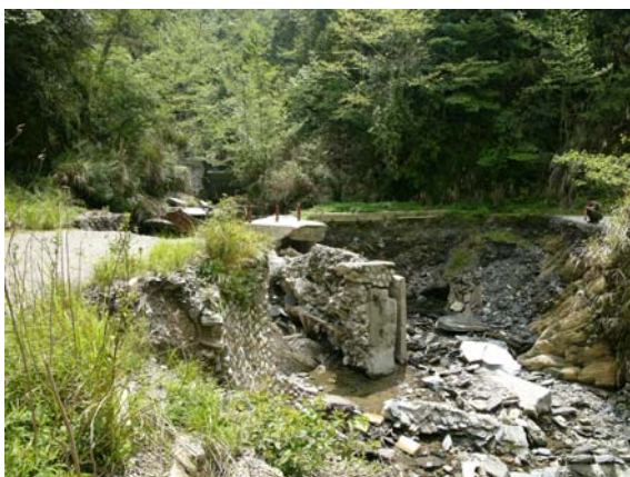
照片 3.26 溝谷口受損路段— 路基沖失。(4.1.1)
