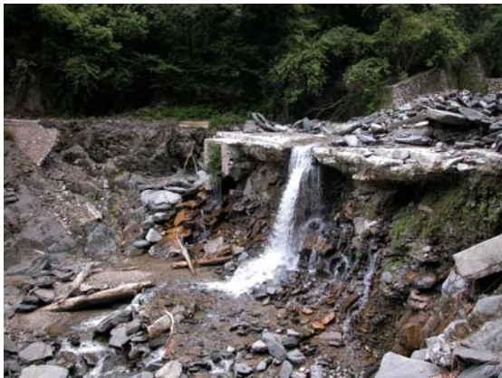
照片 3.133 溝谷口受損路段— 路基沖失。(4.1.9)
