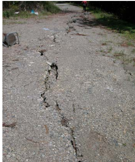
照片 4.40 道路 0—0.5K 寬闊路面龜裂情況。
