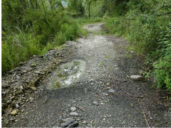
照片 4.19 路面逕流匯集於低窪處，並入滲路基而掣動其崩塌。
