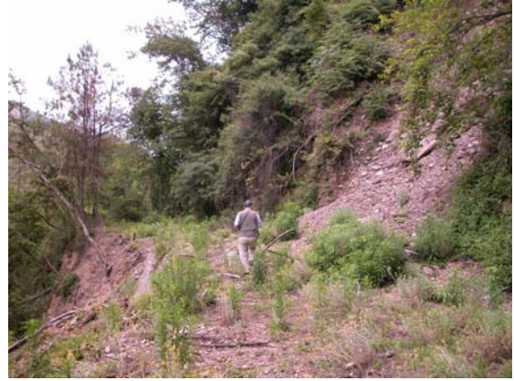
照片 3.120 上坡崩塌受損路段— 基岩崩塌。(3.1.26)
