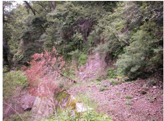
照片 3.100 溝谷口受損路段— 路面淤積。(4.2.15)
