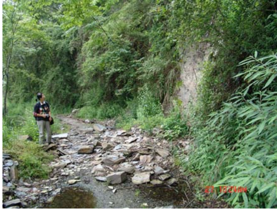
照片 3.33 上坡崩塌受損路段—基岩崩塌。(3.1.6)
