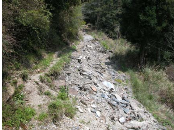
照片 4.47 陡峻下邊坡為路面龜裂和塌陷之地形特徵。
