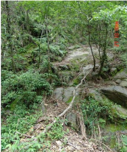
照片 3.30 上坡崩塌受損路段—基岩崩塌。(3.1.4)
