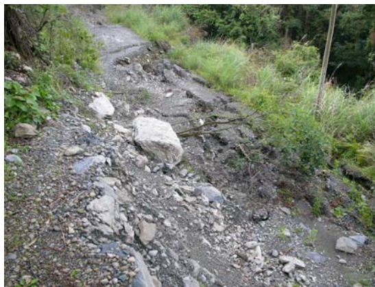
照片 4.46 路面塌陷區路面外側崩裂土塊漸趨零亂，乃土壤吸水軟化流動所生之現象。
