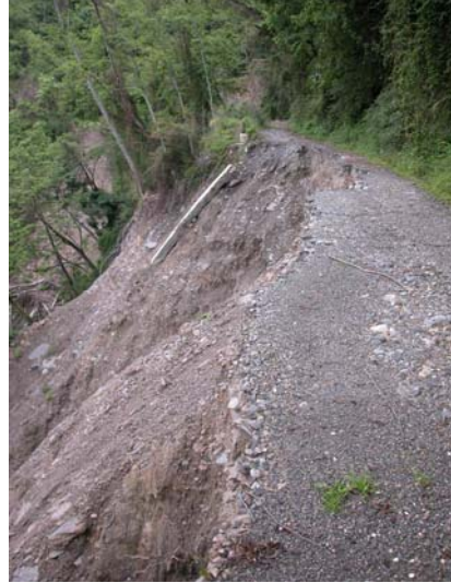
照片 5.19 弧型路面崩塌，由路面集中逕流引起。
