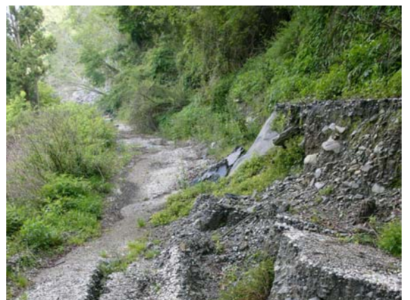
照片 3.9 路面受損路段— 路面塌陷。(2.3.3)
