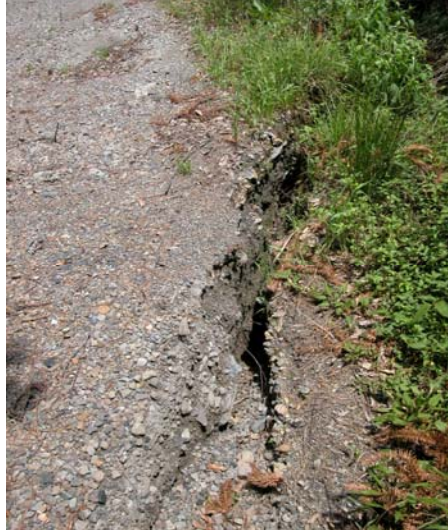
照片 4.42 路面龜裂落差在路緣較大。
