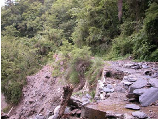
照片 3.114 溝谷口受損路段— 路基沖失。(4.1.7)
