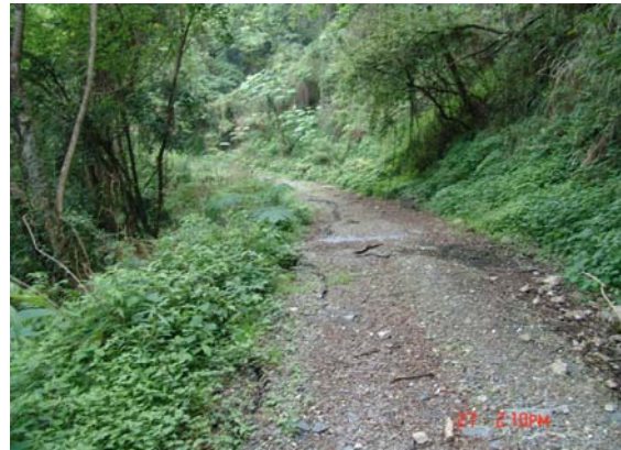
照片 3.64 路面受損路段— 外側滑落。(2.2.5)
