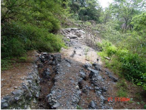
照片 3.48 路面受損路段—路面塌陷。 (2.3.8)
