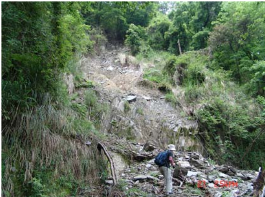
照片 3.72 上坡崩塌受損路段— 基岩崩塌。(3.1.12)
