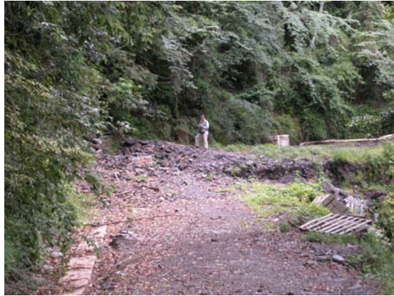
照片 3.98 溝谷口受損路段—路基沖失。(4.1.6)
