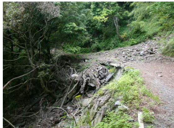
照片 3.69 溝谷口受損路段— 路面淤積。(4.2.4)
