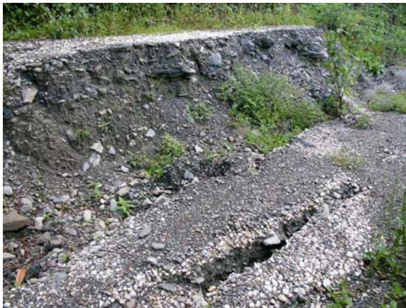
照片 3.8 路面受損路段— 路面塌陷。(2.3.2)
