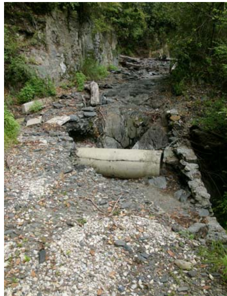
照片 4.37 谷口排水涵管多無作用。
