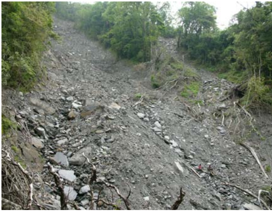
照片 3.39 路面受損路段— 長邊坡路基崩失。(2.4.2)
