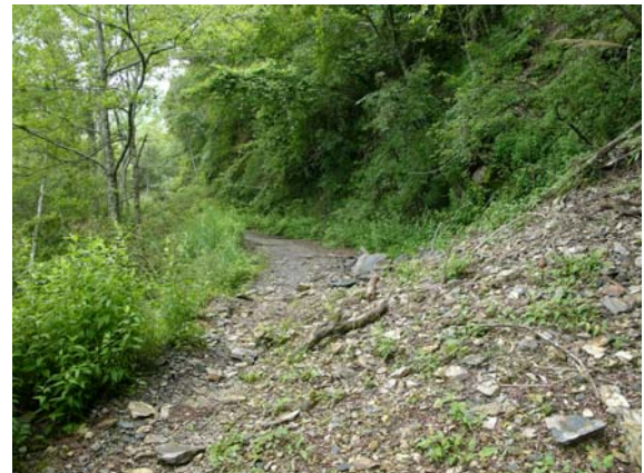
照片 3.32 上坡崩塌受損路段— 基岩崩塌。(3.1.5)
