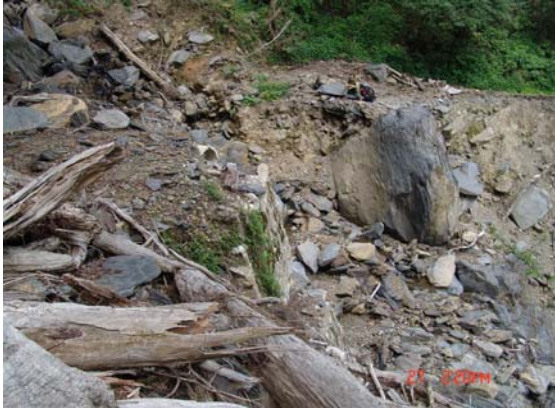
照片 3.65 溝谷口受損路段— 路基沖失。(4.1.4)
