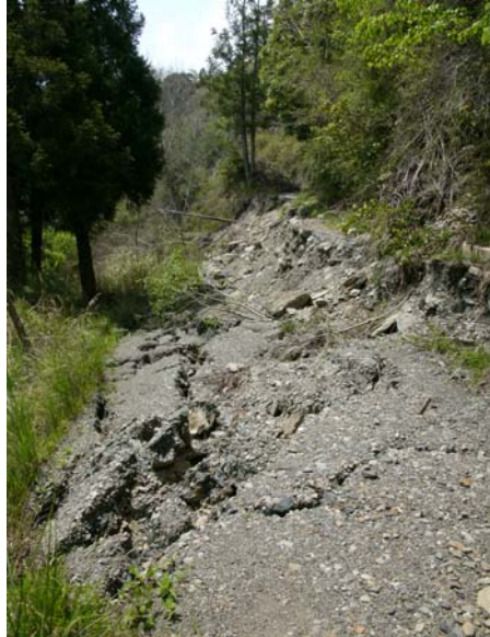
照片 5.40 狹窄填方路基之前傾塌陷。
