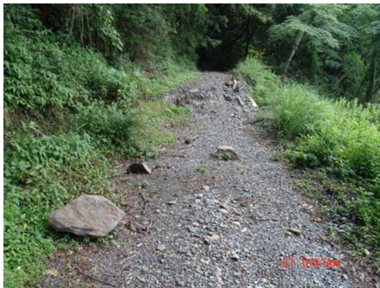
照片 3.36 路面受損路段—路面塌陷。(2.3.7)
