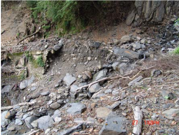
照片 2.10 路基沖失受損路段。
