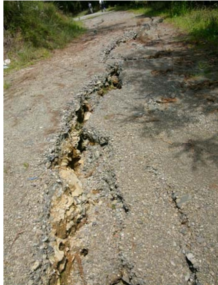
照片 5.38 寬大路基龜裂，填補並於外側設置擋土設施。
