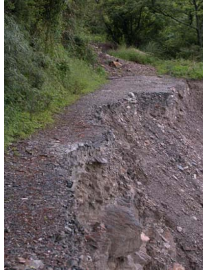
照片 4.17 路緣圓弧形崩塌，前有土石崩積路面，阻擋並轉移路面逕流溢過路緣，乃崩塌之誘因。
