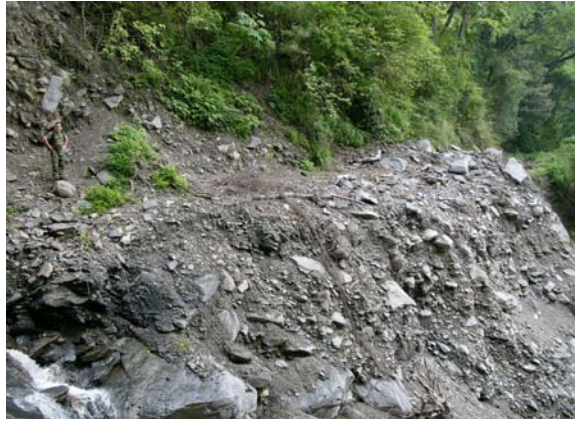
照片 4.36 谷口道路填方路基，穩定度差。
