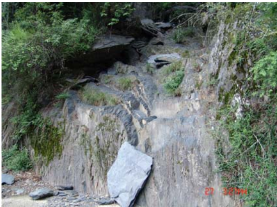
照片 3.78 上坡崩塌受損路段— 基岩崩塌。(3.1.13)
