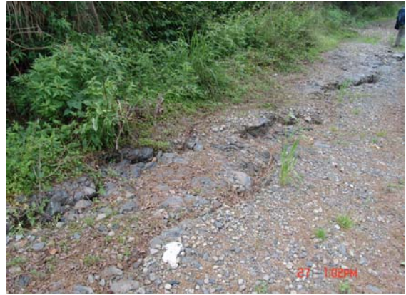
照片 3.54 路面受損路段— 路面龜裂。(2.1.5)
