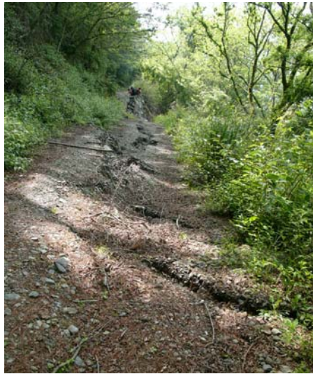
照片 4.44 路面塌陷區之路寬狹窄，下臨陡坡。
