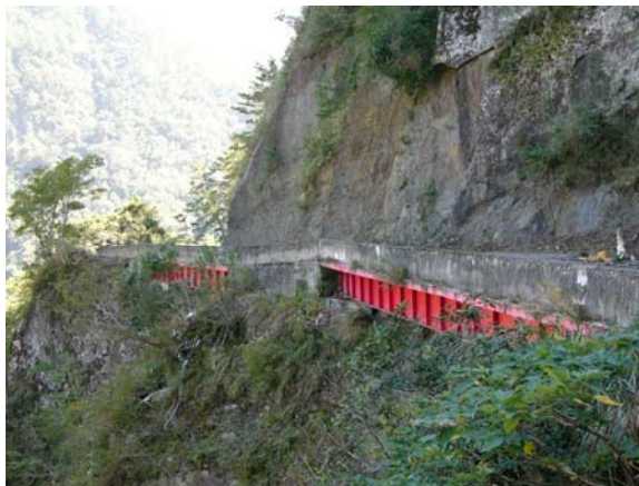
照片 5.25 以半邊橋跨越路基崩失路段。
