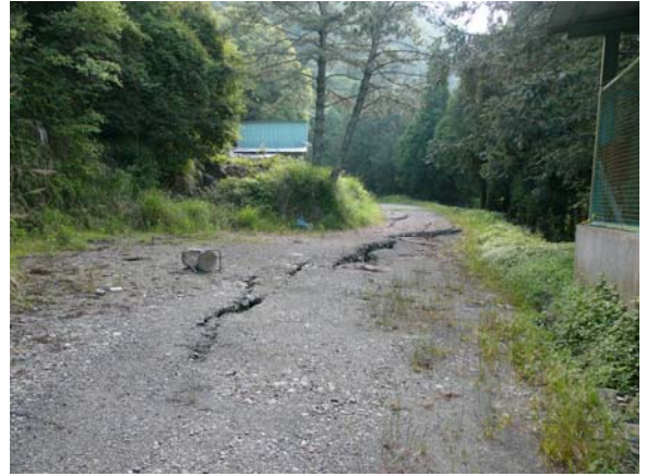
照片 3.2 路面受損路段— 路面龜裂。(2.1.1)
