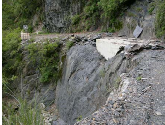
照片 4.50 岩盤路基段少見龜裂與塌陷之現象。
