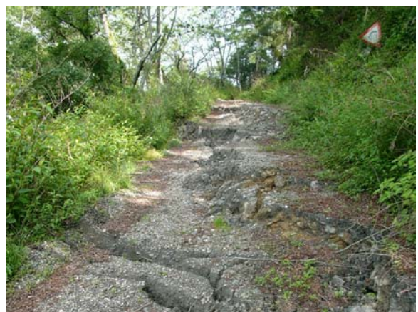
照片 3.17 路面受損路段— 路面塌陷。(2.3.6)
