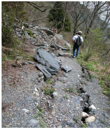
照片 4.45 狹窄路面向陡下坡作前傾階梯狀之塌陷。
