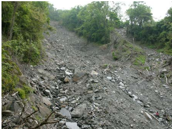
照片 4.27 通過全坡面崩塌區之路基全段崩失。(道路 5.5K 處)
