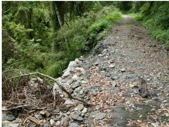
照片 5.20 路面逕流引起之沖刷與駁坎之破壞。
