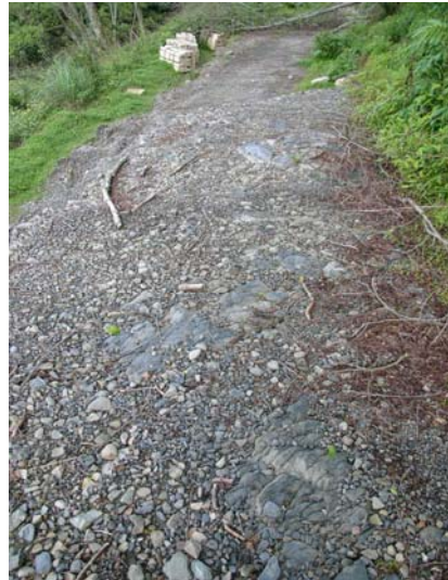
照片 5.17 基岩分佈區路緣之線狀崩塌。
