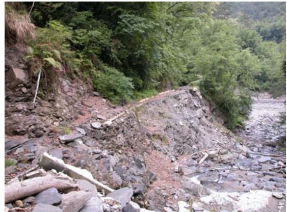
照片 3.128 路面受損路段— 路基崩失。(2.4.7)
