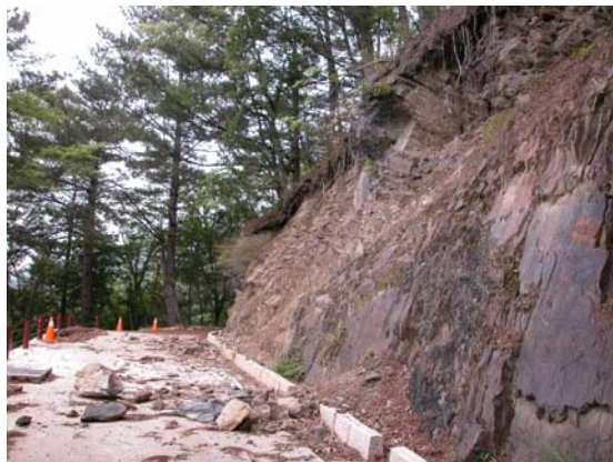
照片 3.107 上坡崩塌受損路段—基岩崩塌。(3.1.21)
