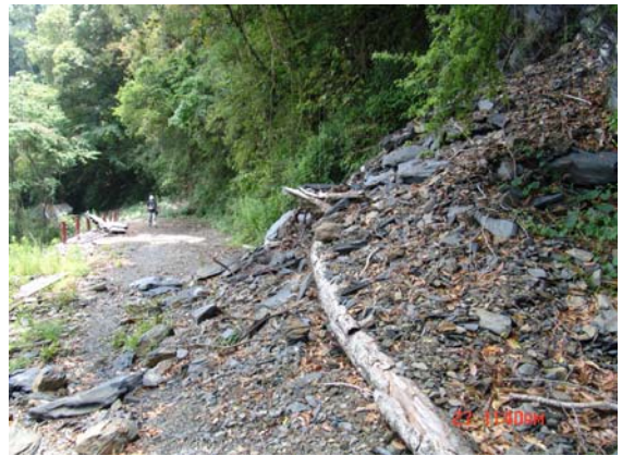
照片 3.45 上坡崩塌受損路段一 基岩崩塌。(3.1.10)
