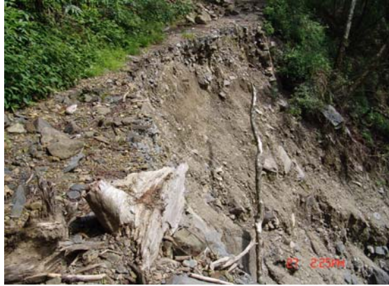
照片 3.66 溝谷口受損路段— 路基沖失。(4.1.5)
