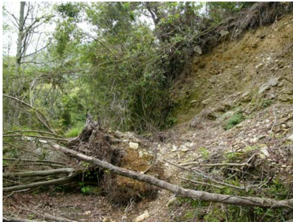
照片 4.12 人工上邊坡風化岩層滑落路面阻擋交通而未傷及路基。
