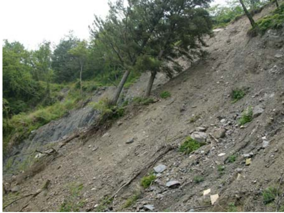
照片 4.26 通過全坡面崩塌區之路基全段崩失。(道路 7.5K 處)
