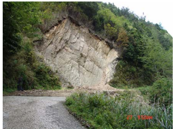
照片 3.25 上坡崩塌受損路段— 基岩崩塌。(3.1.3)
