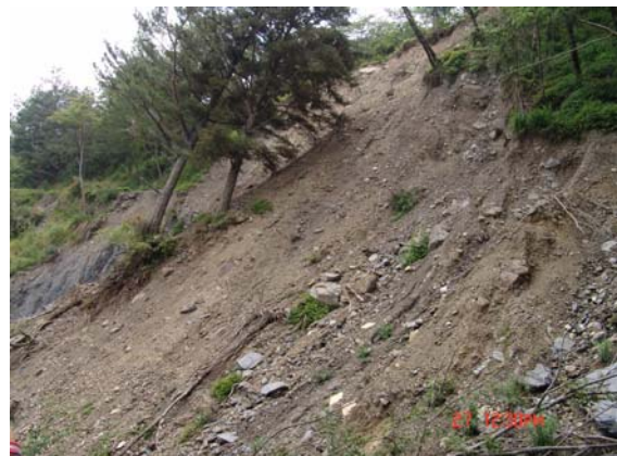
照片 3.52 路面受損路段—路基崩失。(2.4.3) 上坡崩塌受損路段—岩屑滑落。(3.3.3)
