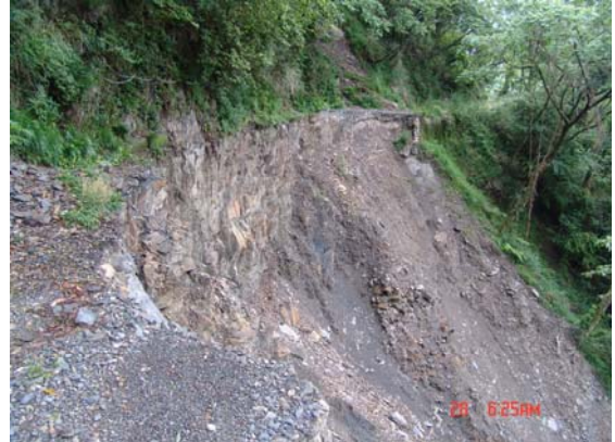
照片 3.81 路面受損路段— 路基崩失。(2.4.4)
