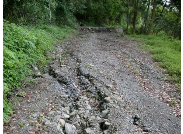
照片 3.7 路面受損路段— 路面龜裂。(2.1.2)
