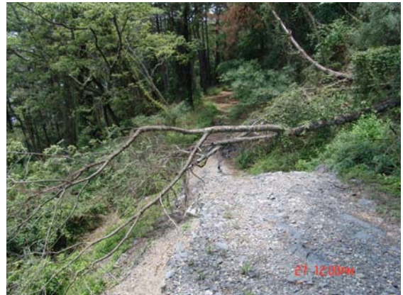
照片 3.50 路面受損路段—外側滑落。 (2.2.3)
