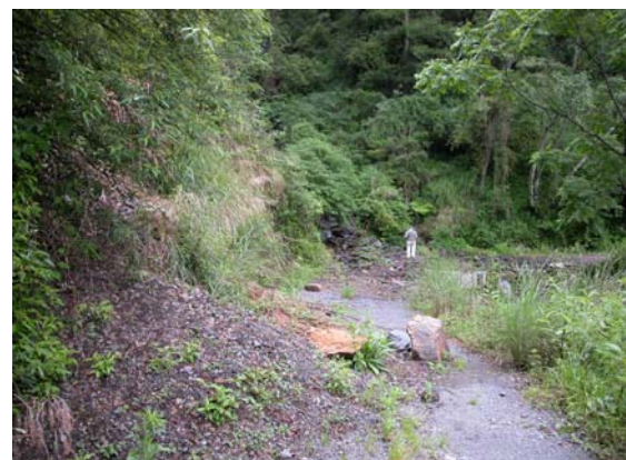
照片 3.87 上坡崩塌受損路段— 基岩崩塌。(3.1.15)
