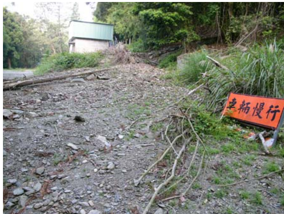
照片 3.5 上坡崩塌受損路段—土砂淤積。(3.4.1)
