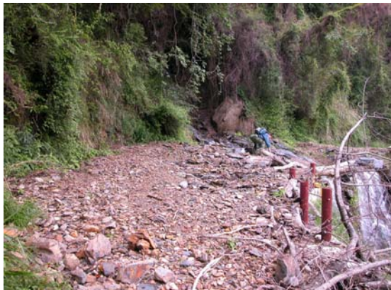
照片 3.84 溝谷口受損路段— 路面淤積。(4.2.8)
