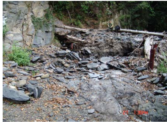
照片 3.60 溝谷口受損路段— 路面淤積。(4.2.2)
