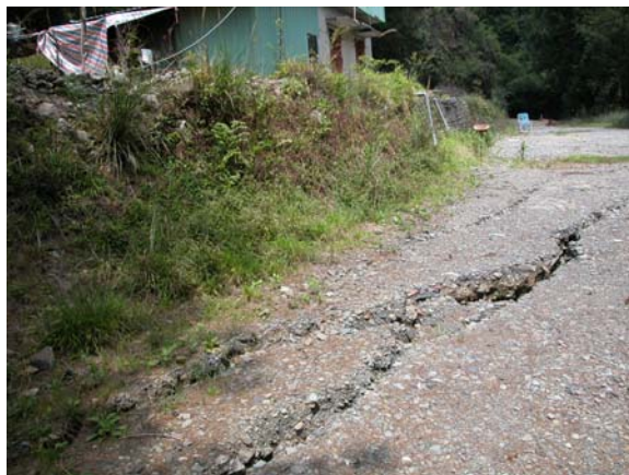
照片 4.41 道路向外側陡坡逐段下陷，落差十公分上下。
