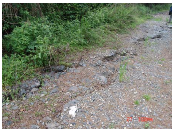
照片 2.2 路面龜裂受損路段。
