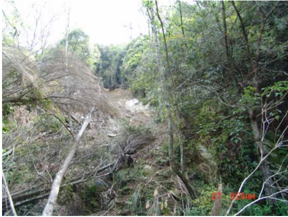
照片 3.22 上坡崩塌受損路段— 岩屑滑落。(3.3.1)
