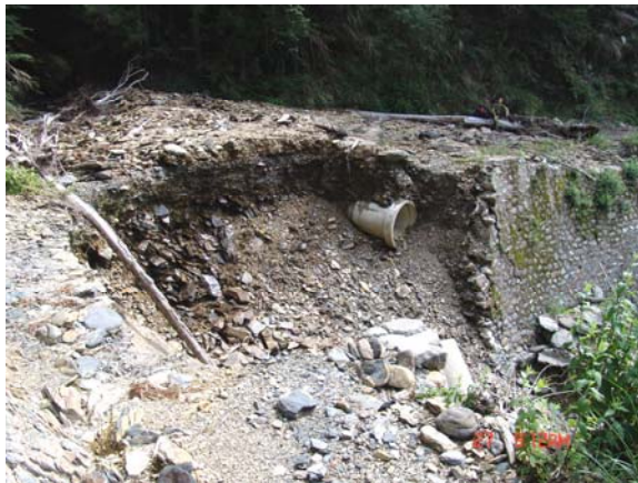
照片 4.31 山洪沖毀填土方路基。所埋之涵管早被杜塞而無排除水、土功能。
