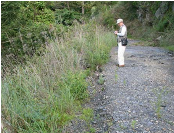
照片 3.3 路面受損路段— 外側滑落。(2.2.1)
