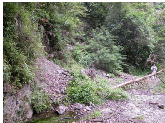
照片 3.102 上坡崩塌受損路段— 基岩崩塌。(3.1.19)
