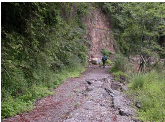
照片 3.80 路面受損路段— 外側滑落。(2.2.6)
