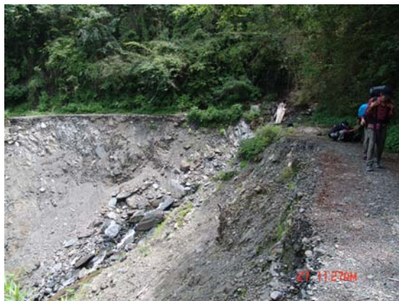
照片 3.41 溝谷口受損路段—路基沖失。(4.1.2)
