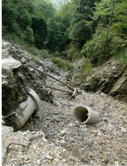
照片 5.35 路基阻擋谷山洪，涵管設計卻以尋常逕流為對象。
