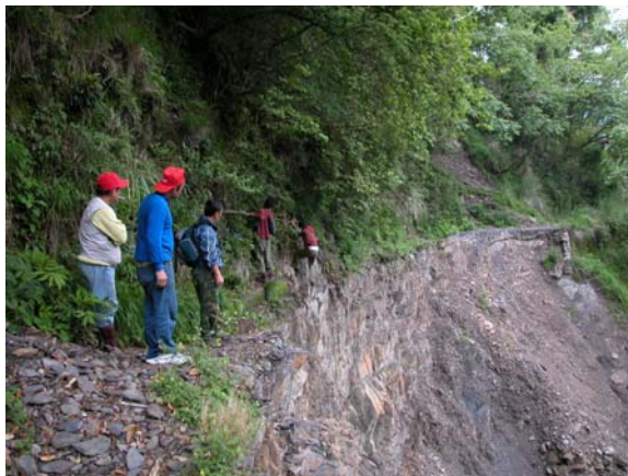
照片 4.25 垂直基岩面與風化層之界面為路基崩塌之滑動面。
