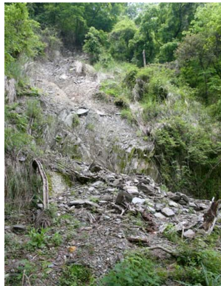
照片 5.8 上邊坡岩石滑落路面，可建擋土牆加防落石網。
