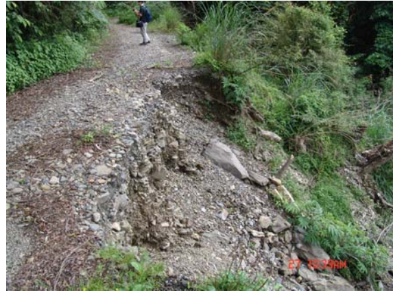
照片 3.35 路面受損路段—外側滑落。 (2.2.2)
