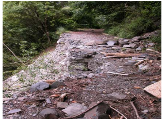
照片 3.117 路面受損路段— 外側滑落。(2.2.7)
