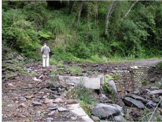
照片 3.88 溝谷口受損路段—路面淤積。(4.2.10)
