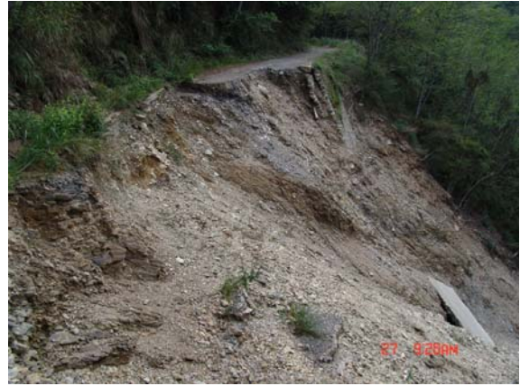
照片 3.23 路面受損路段— 路基崩失。(2.4.1)
