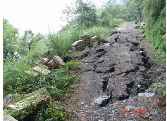
照片 3.77 路面受損路段— 路面塌陷。(2.3.10)
