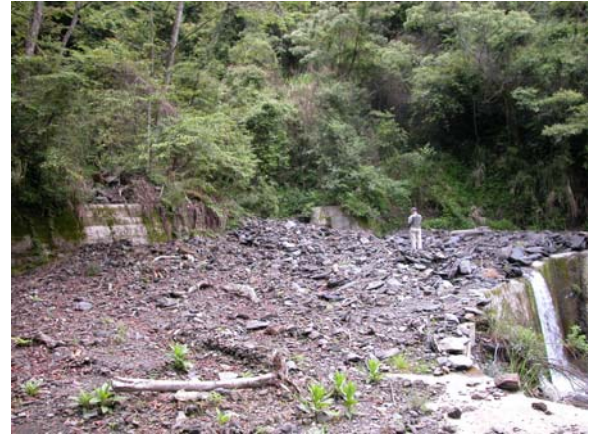
照片 2.11 路面淤積受損路段。
