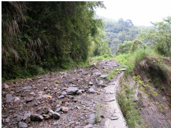
照片 4.34 來自坑溝之土石漫積路面，並使山洪沿路漫流，沖刷路緣和路基。
