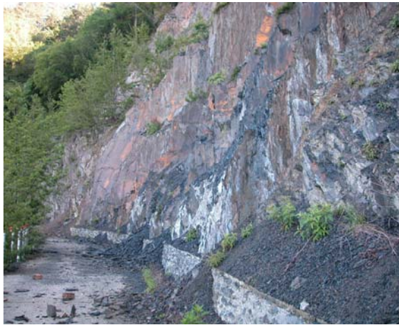
照片 4.5 道路人工上邊坡產生垂直節理面之崩落自由面，而誘發崩塌。
