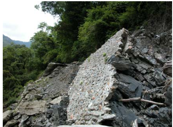
照片 3.111 路面受損路段— 路基崩失 (2.4.6)。
