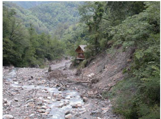
照片 3.134 溝谷口受損路段— 路基沖失。(4.1.10)
