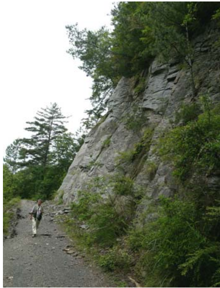
照片 5.3 道路直上方高大峭壁於突發地震之際，容易落石傷人。
