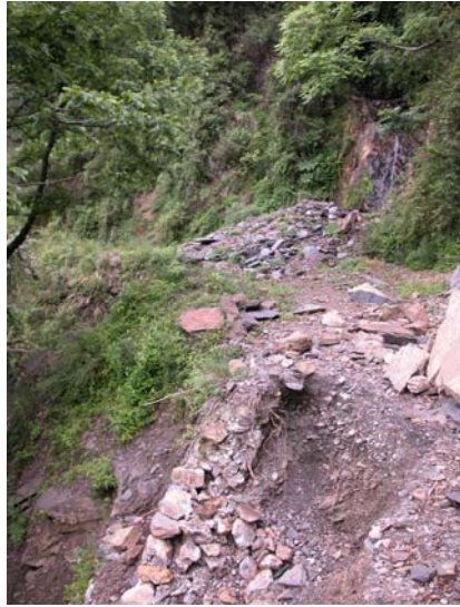
照片 4.21 路面堆積崩塌土石，妨礙逕流排除而造成集中溢流沖刷路緣。
