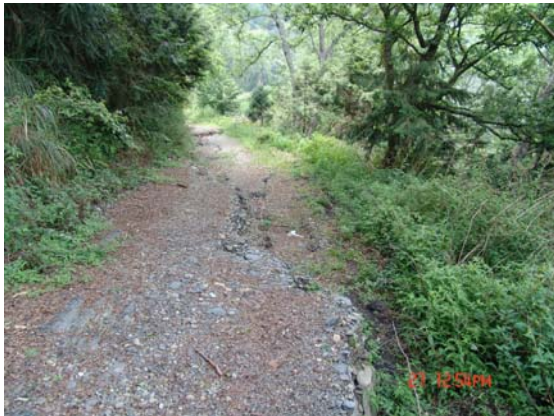
照片 3.55 路面受損路段— 路面塌陷。(2.3.9)
