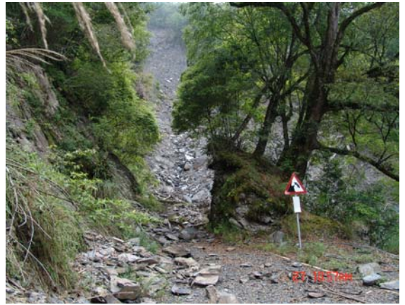
照片 3.40 上坡崩塌受損路段— 岩屑滑落。(3.3.3a)
