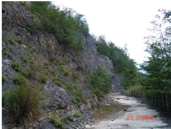
照片 4.1 道路上邊坡新鮮變質硬頁岩之平行坡面之垂直節理發達，易於地震和豪雨時，崩落路面，直接威脅行旅安全。
