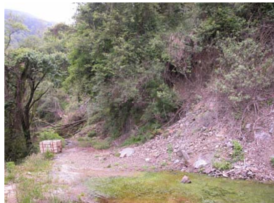
照片 3.97 上坡崩塌受損路段— 基岩崩塌。(3.1.18)
