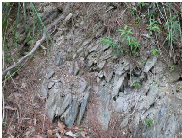
照片 5.7 鬆動岩壁，可建擋土牆加防落石網。(道路 15K)
