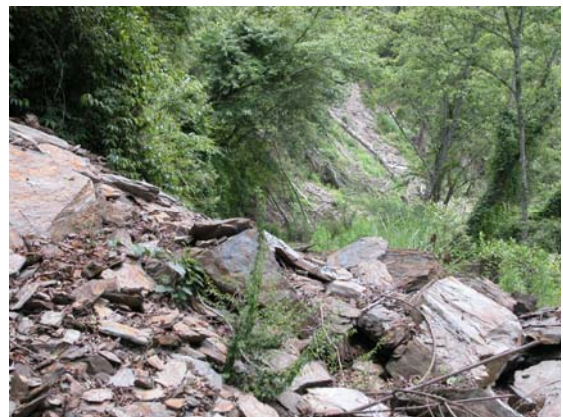
照片 3.130 上坡崩塌受損路段— 基岩崩塌。(3.1.33)
