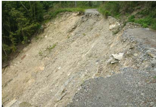
照片 4.15 道路外緣呈圓弧形之崩塌，其滑動面露出風化板岩層理。
