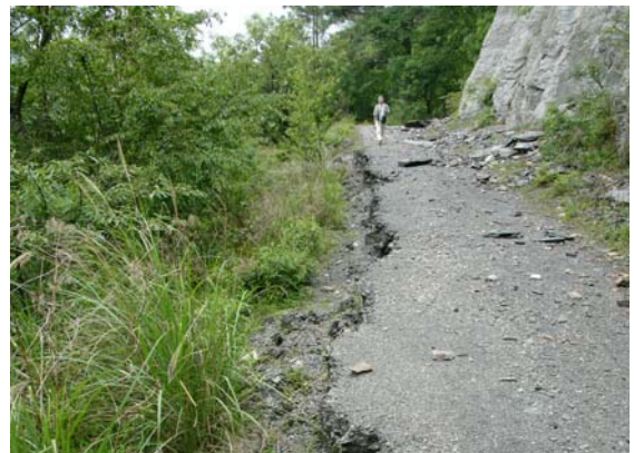
照片 3.58 路面受損路段— 路面龜裂。(2.2.4)
