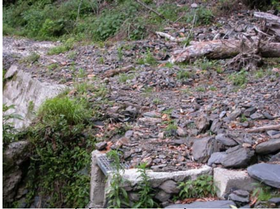
照片 4.33 山洪沖下土石、流木堆積路面阻塞交通。所設方型排水溝小而被土石壅塞而無排除土石、流木之功能。
