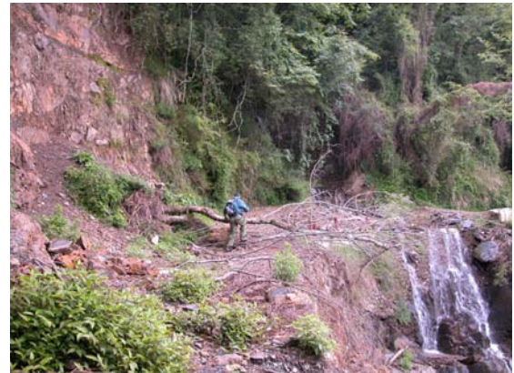
照片 3.83 上坡崩塌受損路段— 基岩崩塌。(3.1.14)
