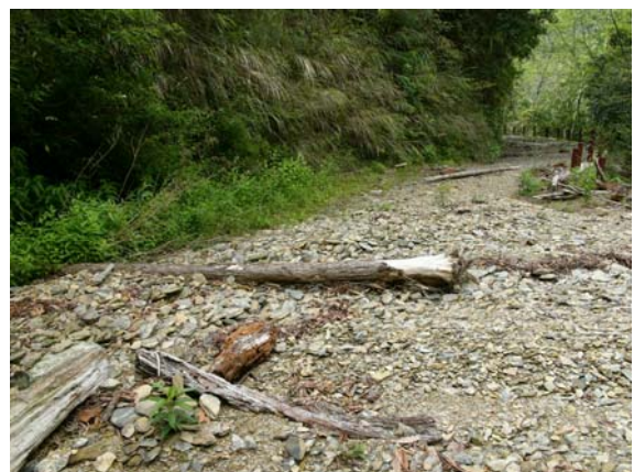
照片 3.27 溝谷口受損路段— 路面淤積。(4.2.1)
