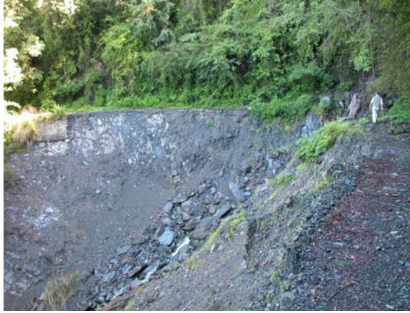
照片 4.38 山洪沖刷峽谷兩岸坡腳而引起路基崩塌。
