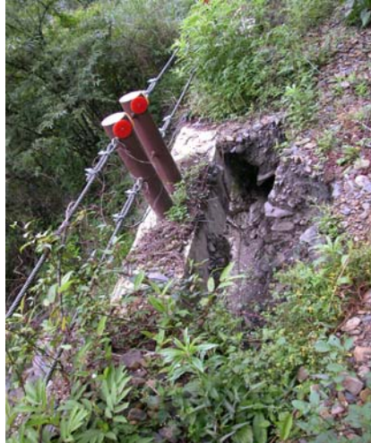
照片 4.23 路緣混凝土構造物之護坡，因填土不實與構造物未至實土，而難敵路面逕流之破壞力。
