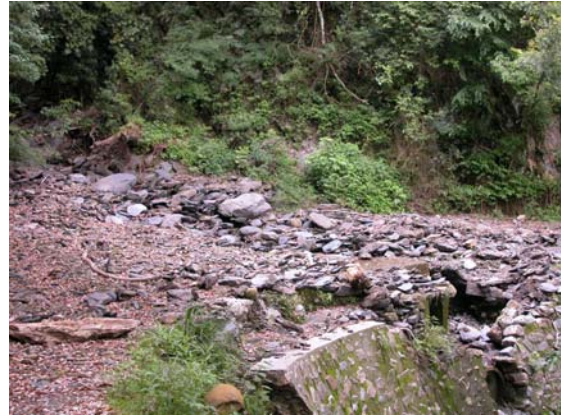
照片 3.104 溝谷口受損路段— 路面淤積。(4.2.17)
