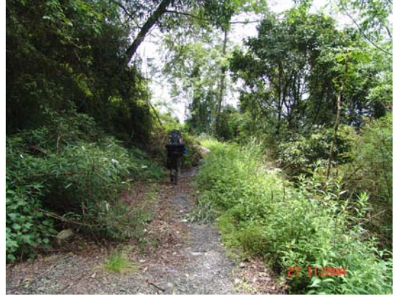
照片 3.43 上坡崩塌受損路段一 基岩崩塌。(3.1.8)
