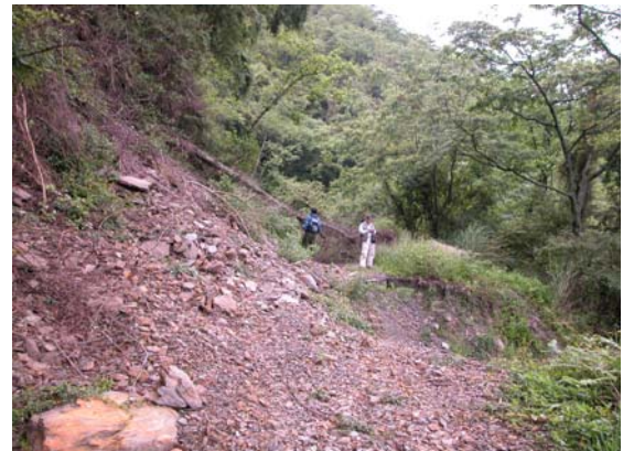
照片 3.85 溝谷口受損路段— 路面淤積。(4.2.9)
