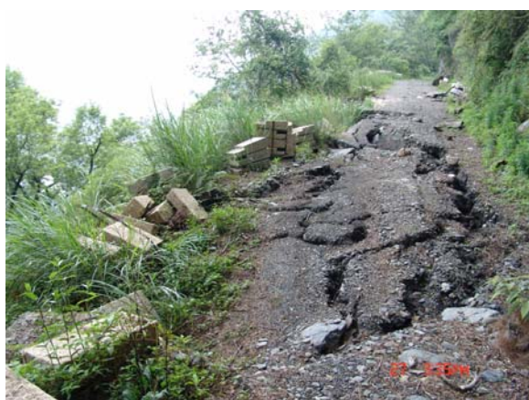
照片 2.4 路面塌陷受損路段。
