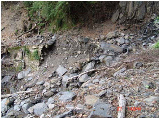
照片 3.59 溝谷口受損路段— 路基崩失。(4.1.3)
