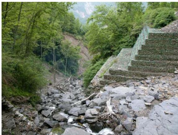
照片 4.39 溪岸工程有改變溪流流心至左岸，而引起坡腳沖蝕。
