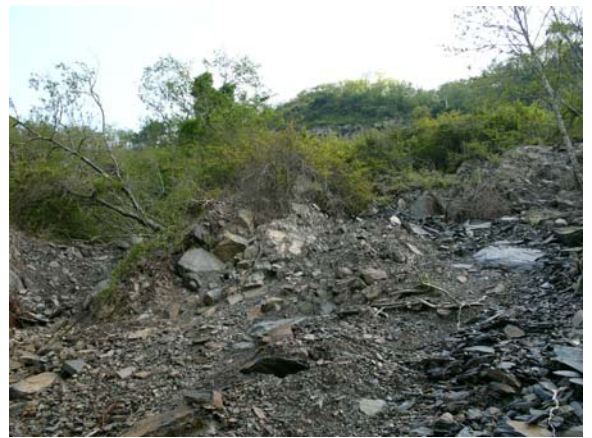
照片 3.11 上坡崩塌受損路段— 崖錐岩板滑落。(3.2.1)
