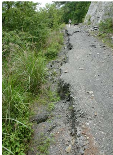
照片 4.16 平行於路緣之線狀崩塌，係沿基岩界面發生。
