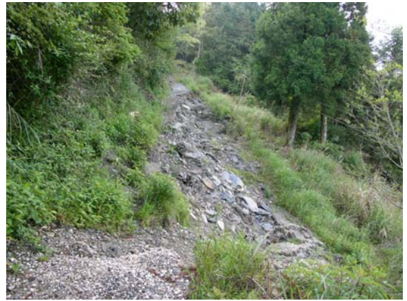
照片 3.4 路面受損路段— 路面塌陷。(2.3.1)
