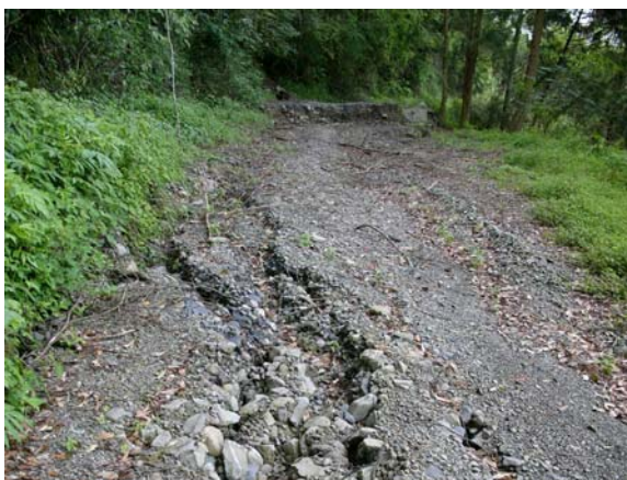
照片 3.10 路面受損路段— 路面塌陷。(2.3.4)
