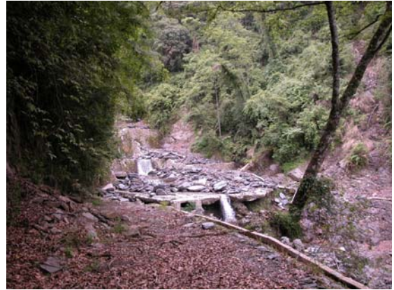
照片 3.132 溝谷口受損路段— 路基沖失。(4.1.8)
