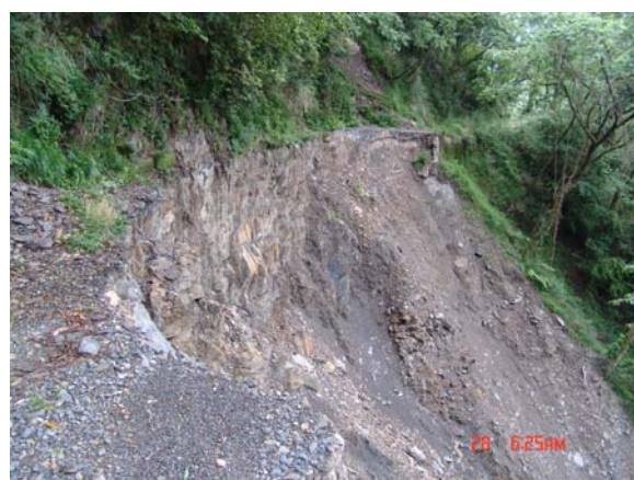
照片 2.5 路基崩失受損路段。
