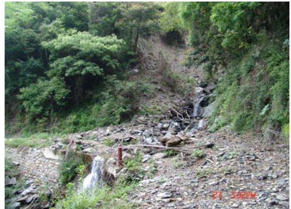
照片 3.73 溝谷口受損路段— 路面淤積。(4.2.5)
