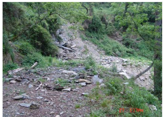
照片 3.75 溝谷口受損路段— 路面淤積。(4.2.6)
