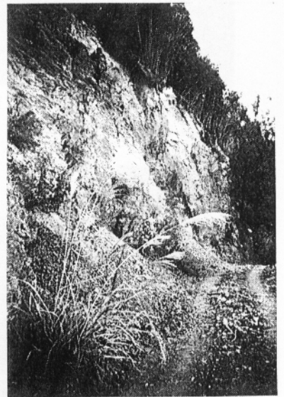
照片11. 司馬限林道有四處人工上邊坡崩塌地，屬「一不小心就危險」的第四級路段。
