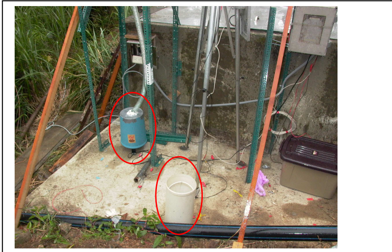
圖 13：20cm 傾斗式雨量筒於觀霧實際安裝運作情形
