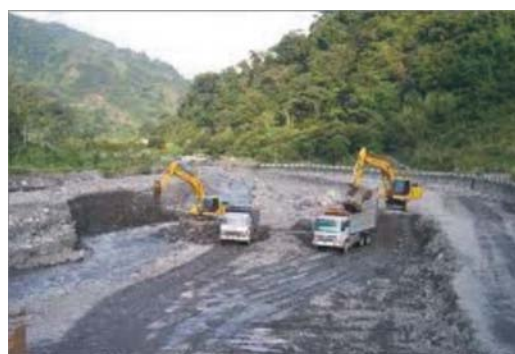
921地震烏石坑溪受災情形
