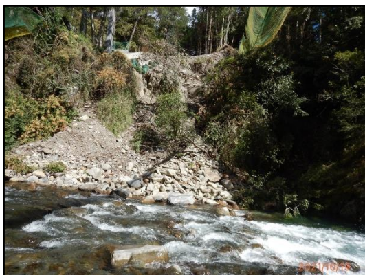
桃山西溪 6-5 斷面左岸崩塌
