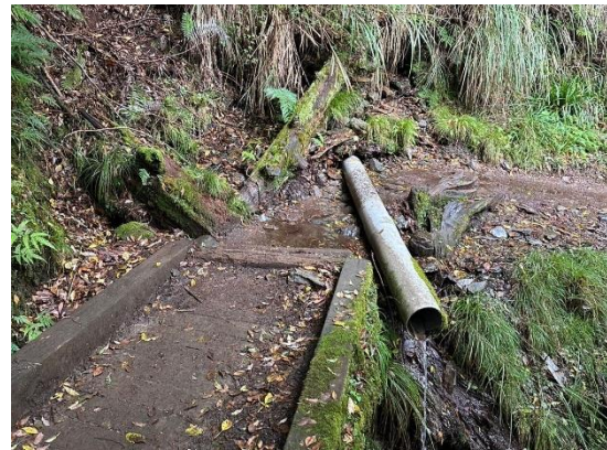
設施毀損影響道路通行
