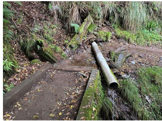
設施毀損影響道路通行
