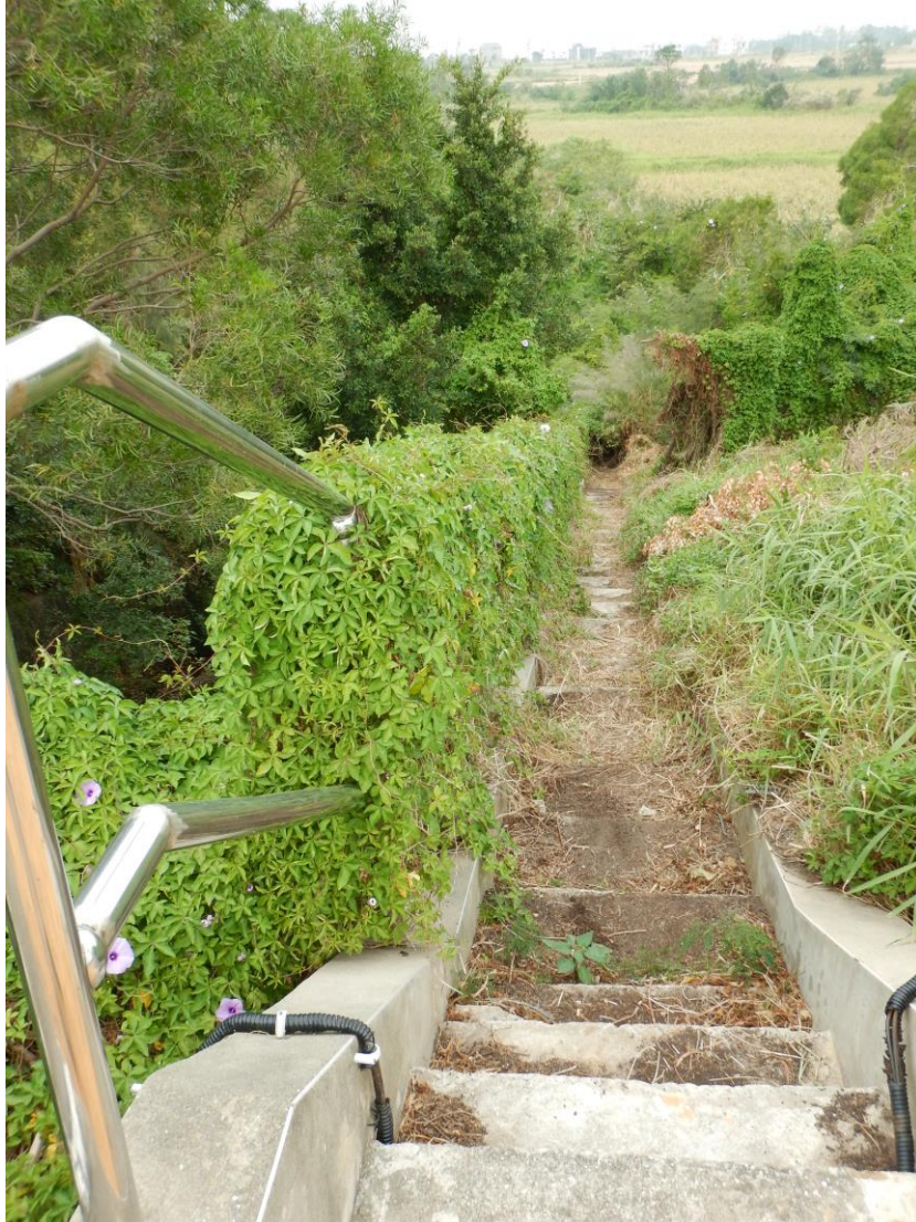
圖 3-38、溢洪道旁步梯經持續清理超過半年後狀況
