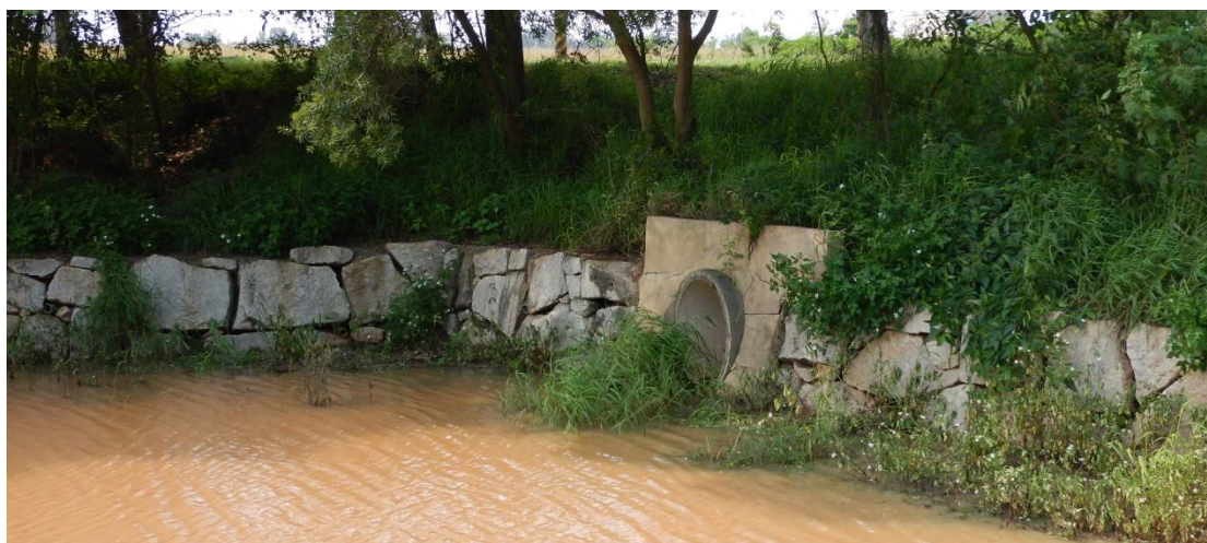
圖 3-6、涵管管徑過小，水位較高時可能會導致管內水流急速，氣室空間減少
