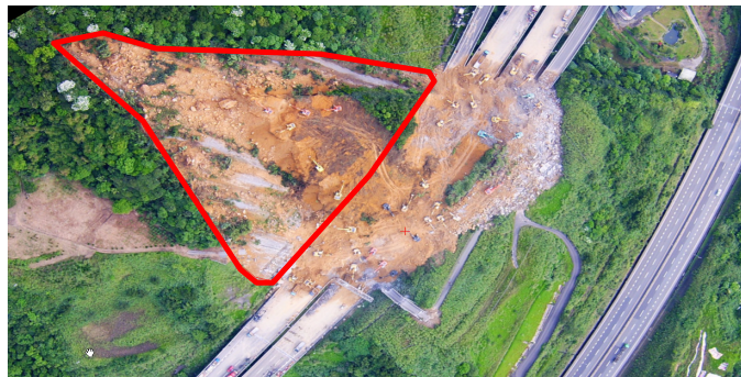
圖12 崩塌區域邊界圖
