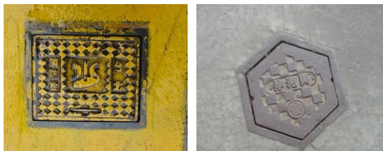
圖 1-5 公用管線孔蓋之消防栓（左）及排泥閥（右）
