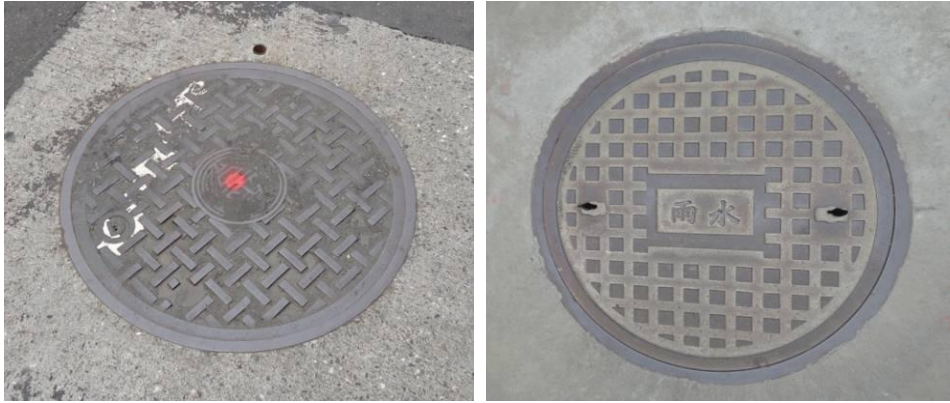
圖 3-45 台電人手孔（左）及區公所雨水人手孔（右）
