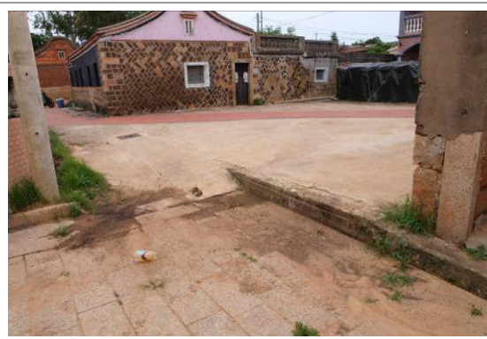
進入 111 號民宿前的入口雨天常積水
