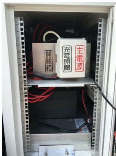
圖 3-93 左側機櫃擺設
