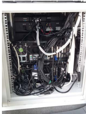
圖 3-89 右側機櫃擺設
