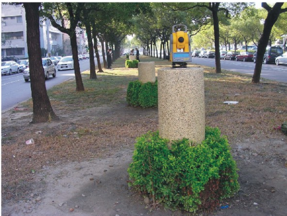
圖4-82 黎明固定基樁式基線場
