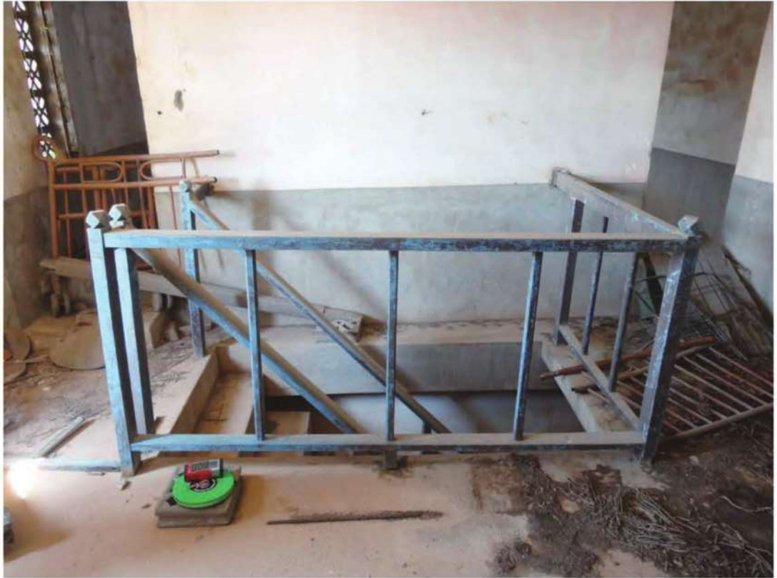
二樓左房樓梯-修復前
