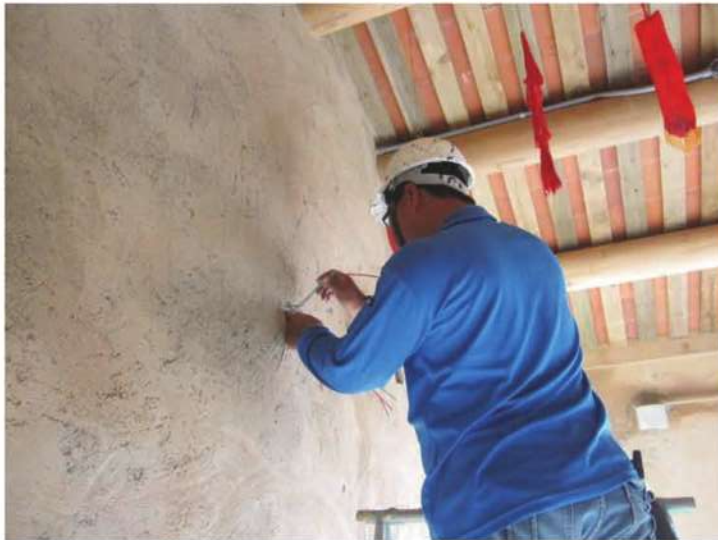
照片- 314：燈具管路配線
