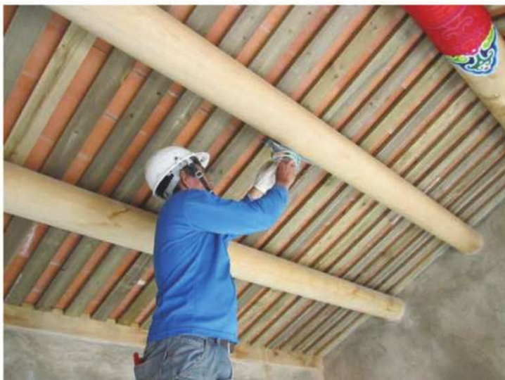
照片- 315：燈具管路配線
