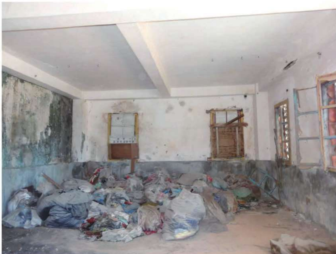
二樓左房-修復前
