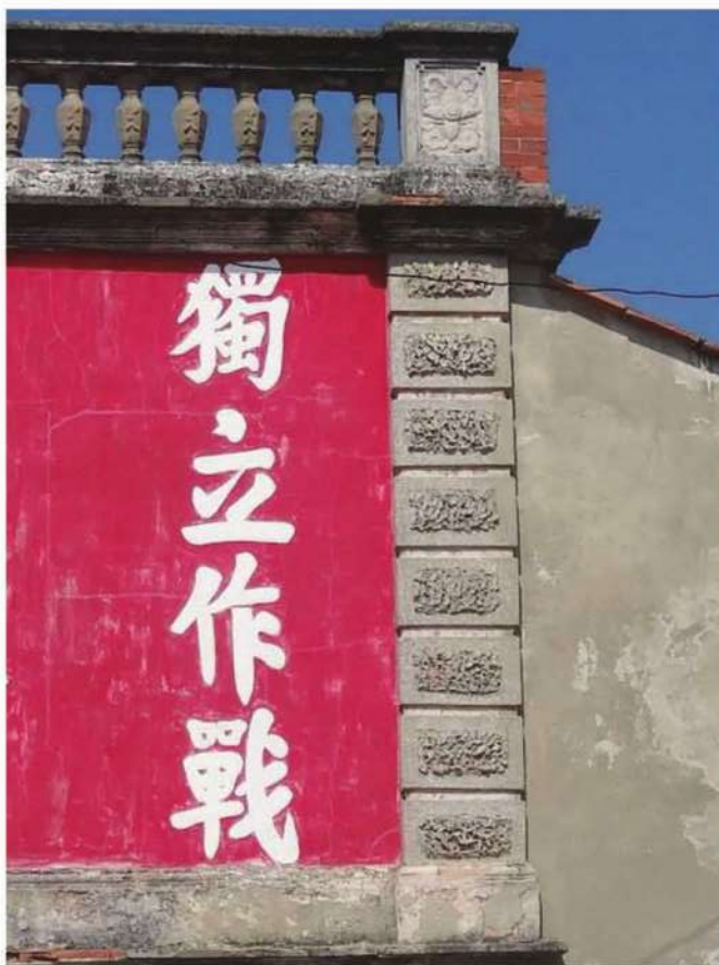
照片- 26：養拙樓左側外牆抓水泥漿蟲蝕狀裝飾柱面
