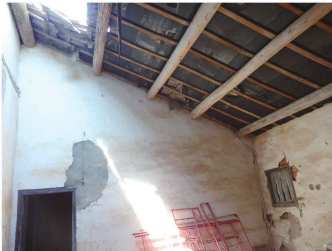
後落正廳牆面及屋架-修復前
