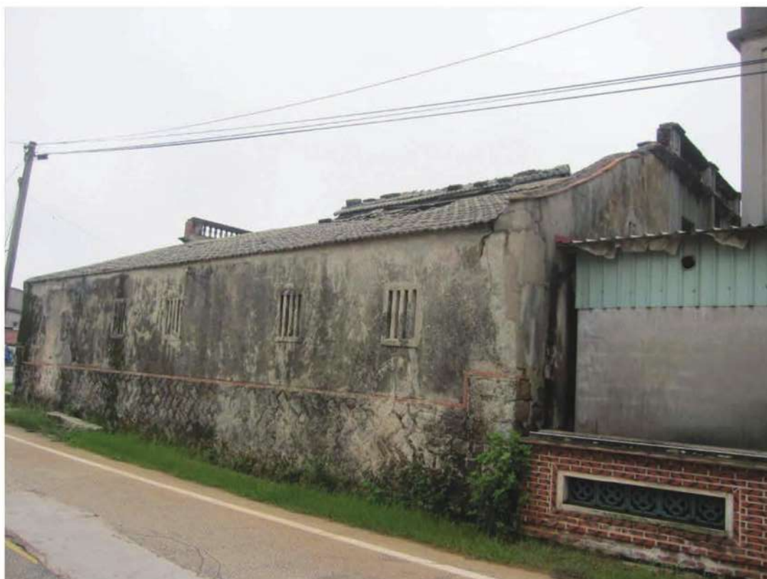
右後側立面-修復前
