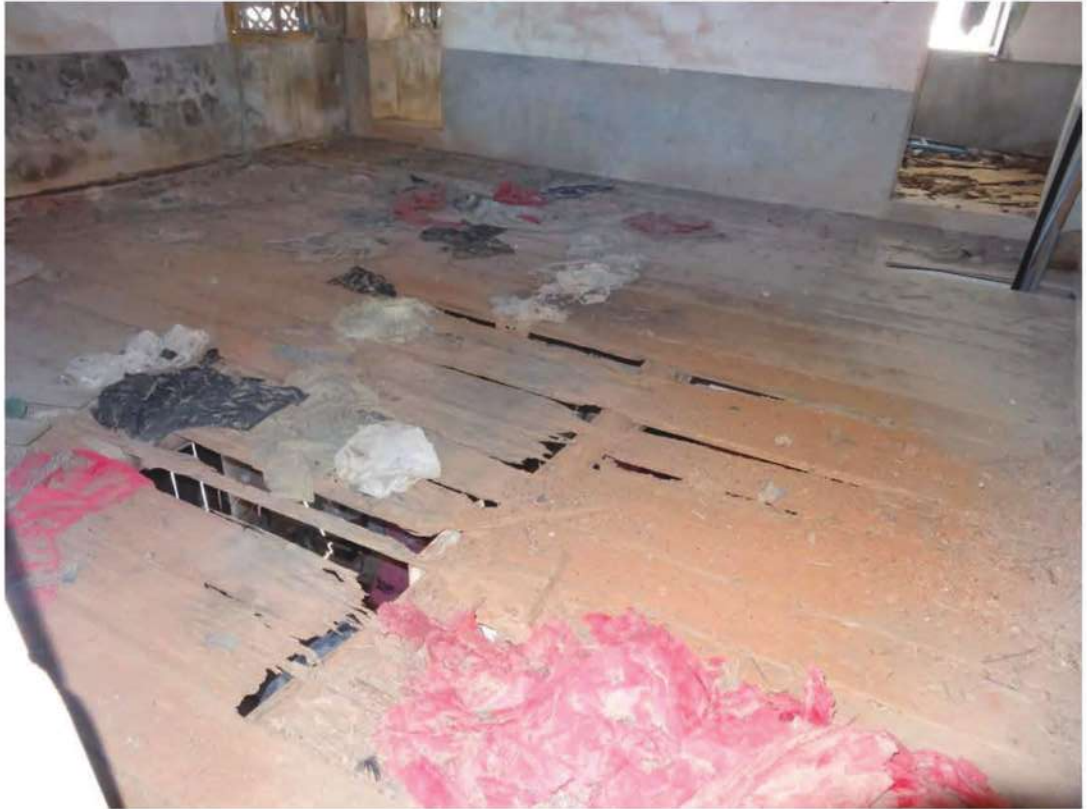
二樓大廳地坪-修復前
