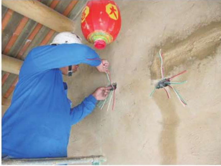
照片- 313：燈具管路配線
