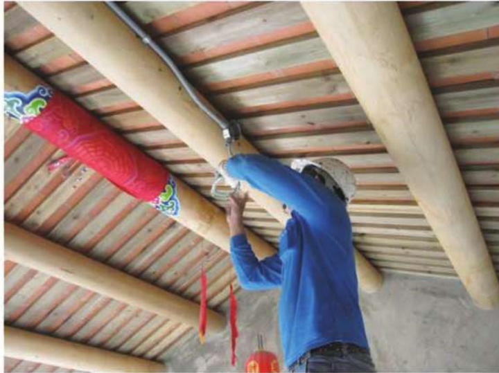
照片- 316：燈具管路配線
