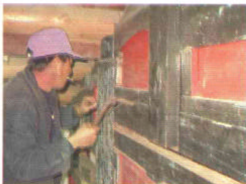
圖3-43 檢視木料腐朽情形
