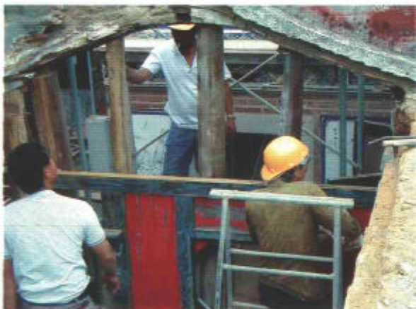
圖3-25 檢視棟架木料腐朽情形
