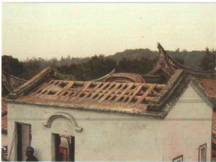
圖3-5 檁頭枋木腐朽情形
