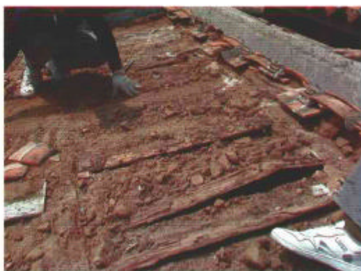
圖3-23 檢視望板及桷木損壞現況
