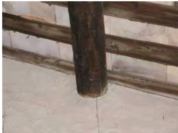
照片 5-1- 336 左前二架有腐朽現象
