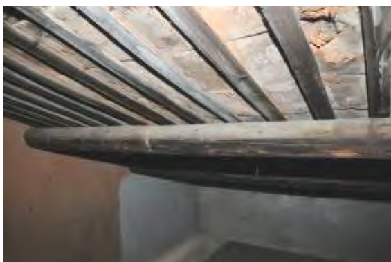
照片 5-2-74 後落左房後一架表面局部劈裂材質尚可
