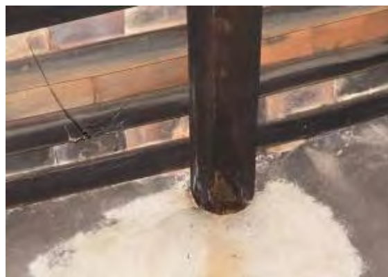
照片 5-1-322 前二架與牆體接合部位腐朽
