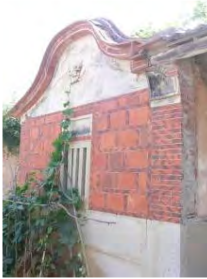
照片 5-2-14 右側正面牆基及磚面良好
