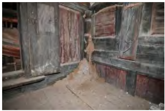
照片 5-3- 60 後落左次間夾層上右前角落有蟻巢
