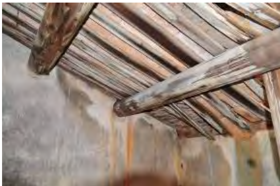
照片 5-3- 104 左次間後二、三架嚴重腐朽、蛀蝕
