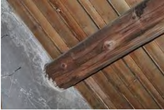
照片 5-1- 84 後一架局部乾裂無明顯損壞
