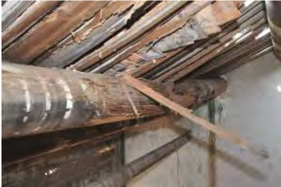
照片 5-1- 110 正廳前一架嚴重腐朽即將斷裂
