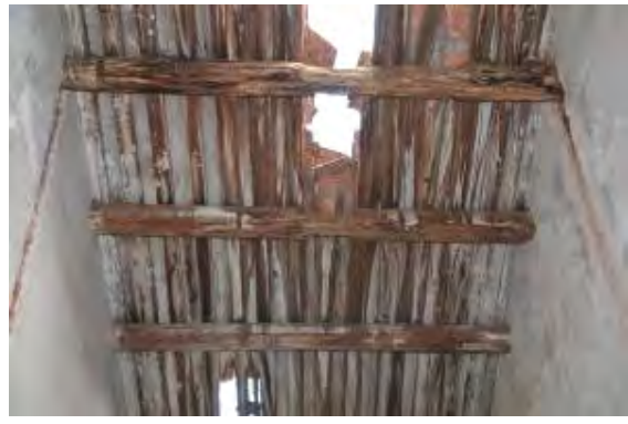
照片 5-1- 117 後落右房屋樑均嚴重腐朽
