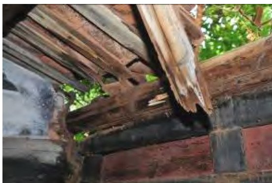
照片5-7-32 右端嚴重腐朽蛀蝕
