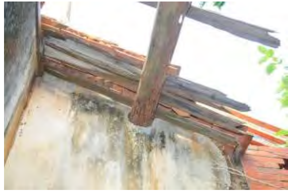
照片 5-3- 162 後落挑檐屋面崩塌
