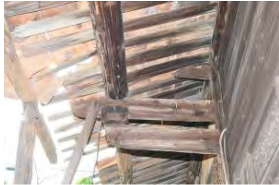
照片 5-3- 134 正身右前屋面破損
