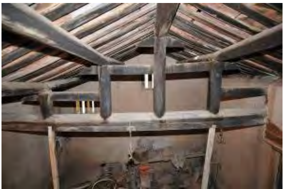
照片 5-7-9 左凸規木構架有崩塌之虞
