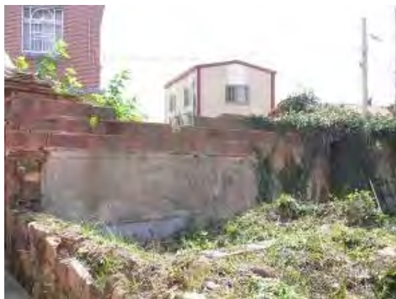
照片 5-3- 115 前庭鋪面已被雜草覆蓋（一）
