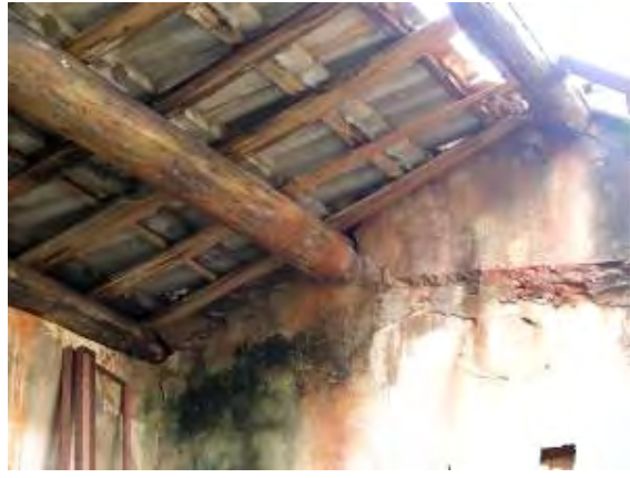
照片 5-1-340 左前二架有腐朽現象
