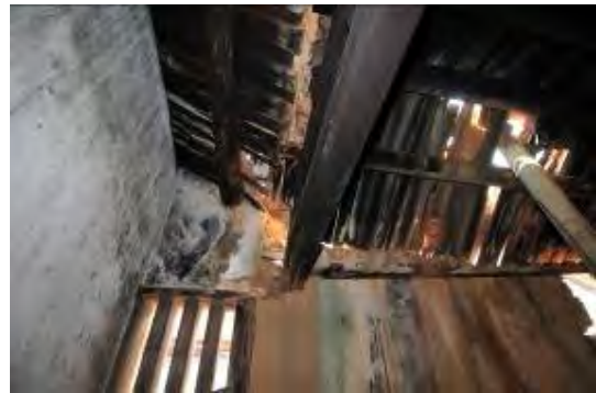
照片 5-3- 65 右擗頭與前落交接處破壞情況
