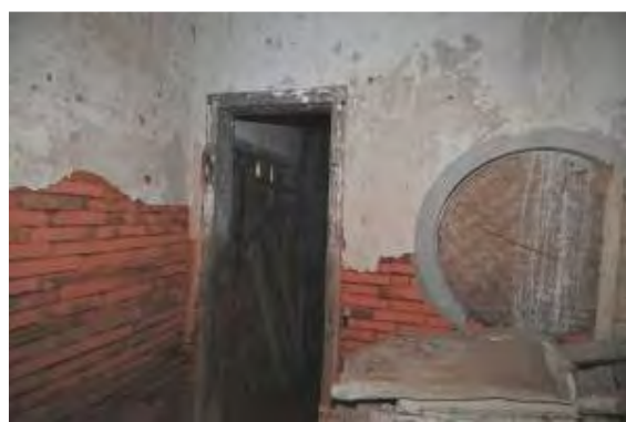
照片 5-1-17 紅磚灰縫風化掉落嚴重
