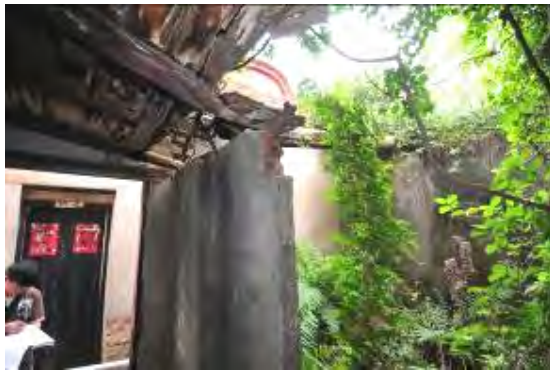
照片5-7- 67 左前擡頭坍塌
