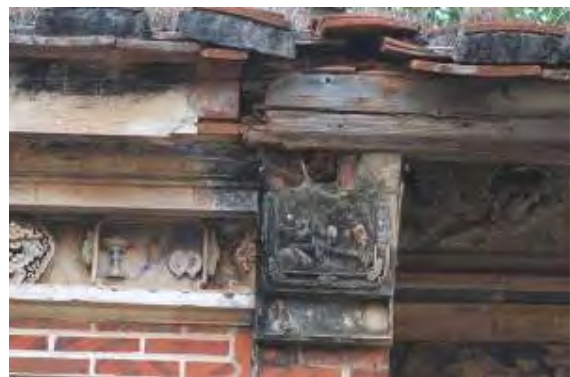
照片 5-1- 263 前挑檐捧檐右端部腐朽損壞
