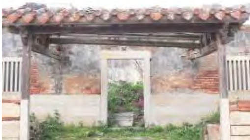
照片 5-1- 130 水頭 19 號入口嚴重損毀
