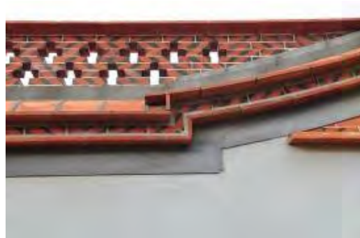
照片 4-2- 51 擗頭雨後落接合部位有裂隙
