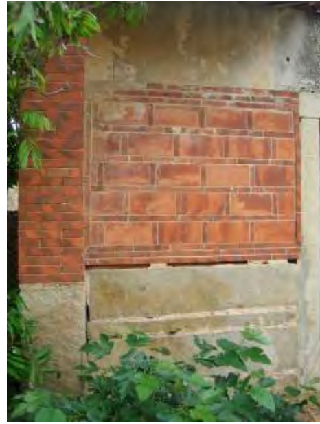
照片 5-2-45 前落牆面良好、牆基部分灰縫剝落
