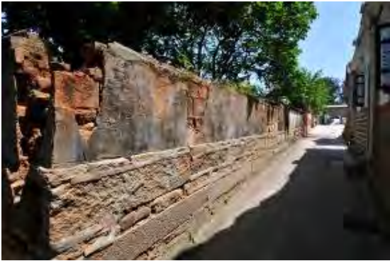
照片5-1-60 左側圍牆壁面損壞
