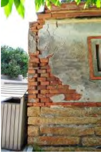
照片 5-1- 246 護龍轉角嚴重劈裂
