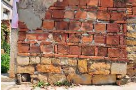
照片 5-1- 305 正面牆之歪斜牆基與斗砌牆
