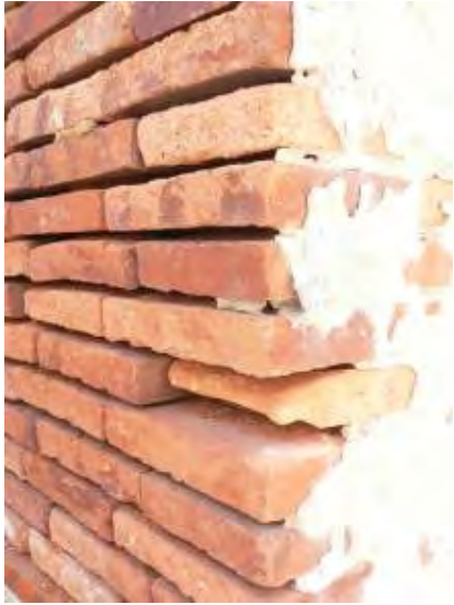
照片 5-1- 214 牆體磚面及灰縫嚴重風化
