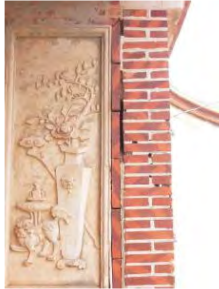
照片 5-3-8 左上房右側牆面灰縫剝落
