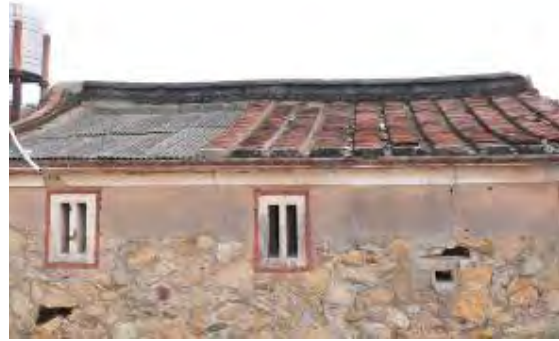
照片 5-4-38 背牆局部損壞，屋面左側曾更換石棉
