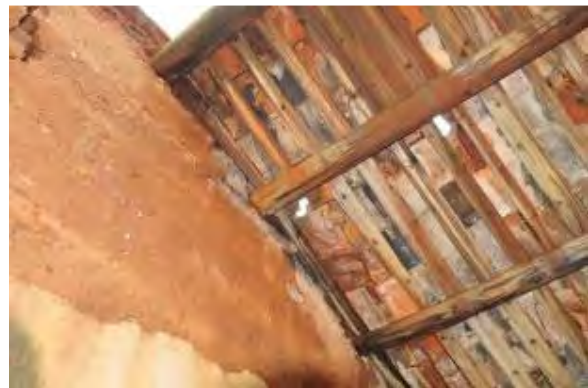
照片 5-1-203 左間樞仔端部嚴重腐朽
