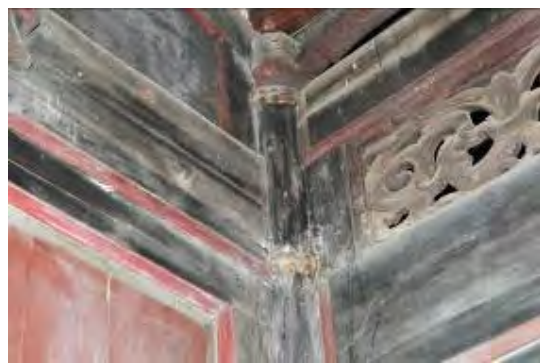
照片 5-3- 46 右後立柱柱頭內部嚴重蛀蝕
