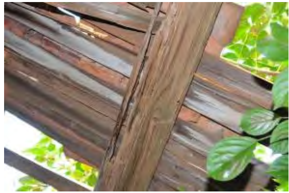
照片 5-3- 170 後落正廳前四架挑檐嚴重腐朽蛀蝕
