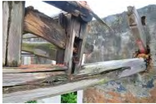
照片 5-1- 171 左大通嚴重腐朽應抽換
