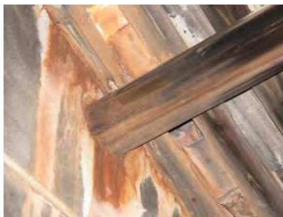
照片 5-1-318 後二架右端與牆體接合部位腐朽
