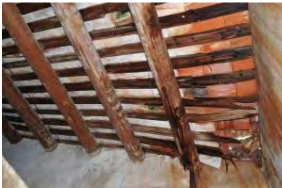
照片 5-1- 278 右次間後屋面破損滲水椽仔嚴重腐朽
