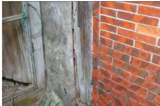
照片 5-7-24 右前立柱嚴重乾裂
