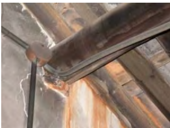
照片 5-1-317 後三架右端與牆體接合部位腐朽
