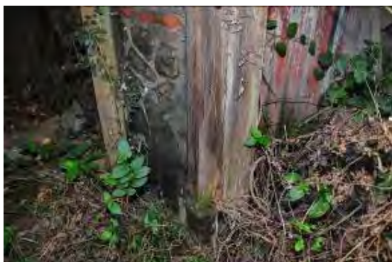
照片5-7-36 左後立柱嚴重腐朽及局部蛀蝕
