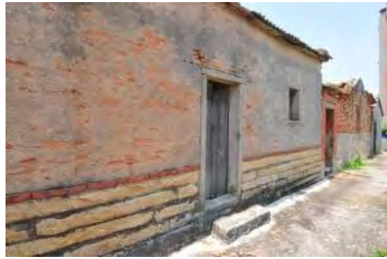
照片 5-6-6 後寮牆壁面灰壁損壞
