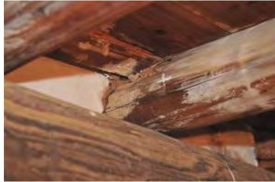
照片 4-2- 151 G-2-3 端部蛀蝕嚴重
