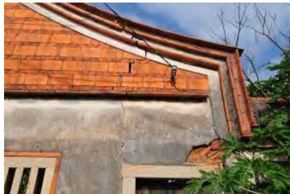
照片 5-3- 130 右側外牆上方龜裂
