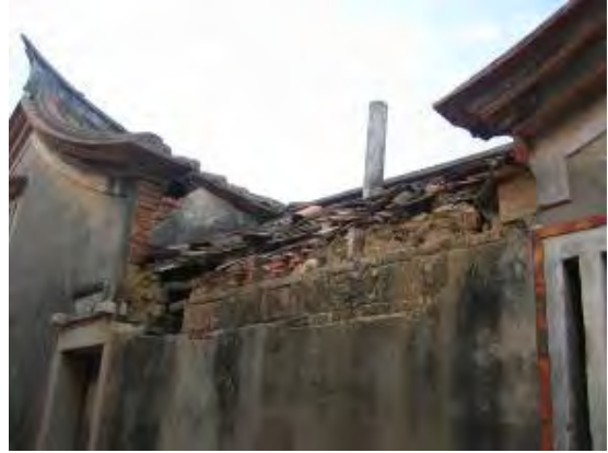
照片 5-3-5 右側除房屋面與牆交接處損壞
