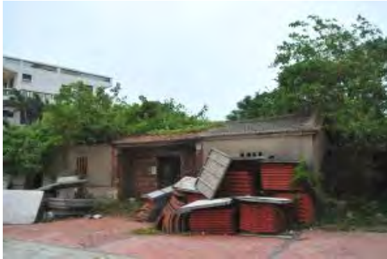
照片 5-6-25 建物外觀立面，植物四處竄升
