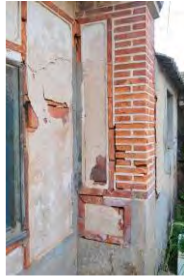
照片 5-3-92 前落磚牆灰縫損壞
