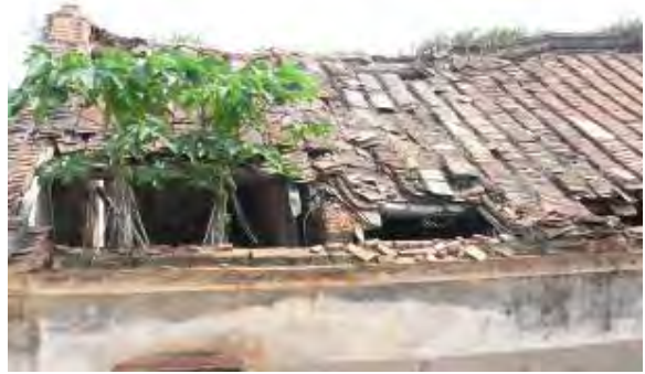
照片 5-1- 215 屋面破損坍塌，植物攀生
