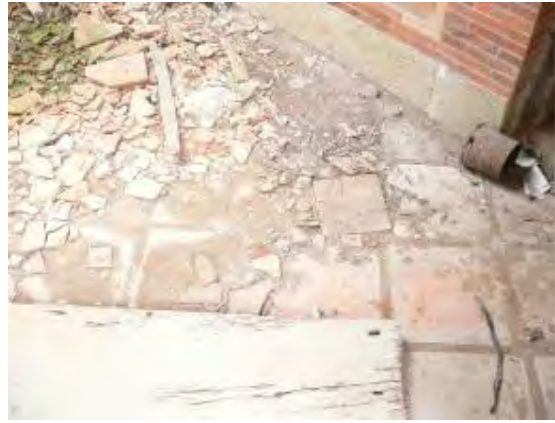
照片 5-3- 152 地坪有坍塌物，地磚面現況尚可
