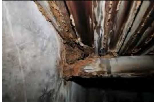
照片 5-3- 50 後三架右側嚴重蛀蝕斷裂下陷
