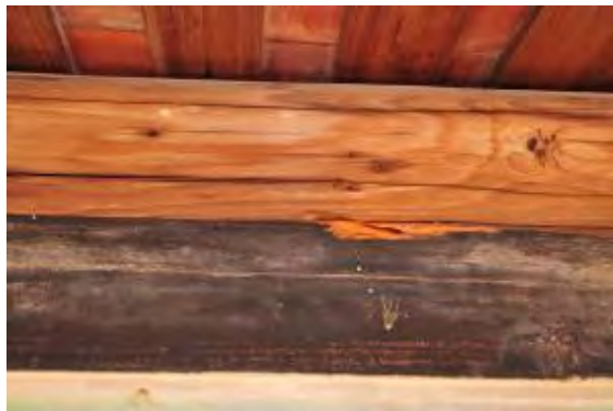
照片 4-2- 176 二樓正廳前二架局部蛀蝕
