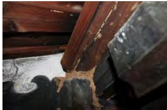
照片 5-3- 42 中脊左側樁接處蟻巢，裂縫內有蟻道
