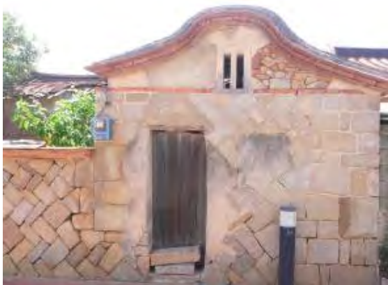
照片 5-2-48 迴向旁倉庫牆面沙漿剝落
