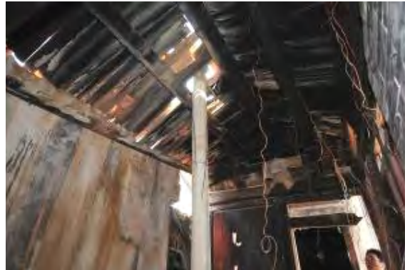
照片 5-3-32 右側擗頭屋架及屋面損壞情況
