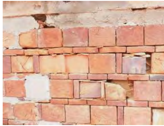
照片 5-7-14 背牆磚面灰壁覆蓋剝落、磚面風化
