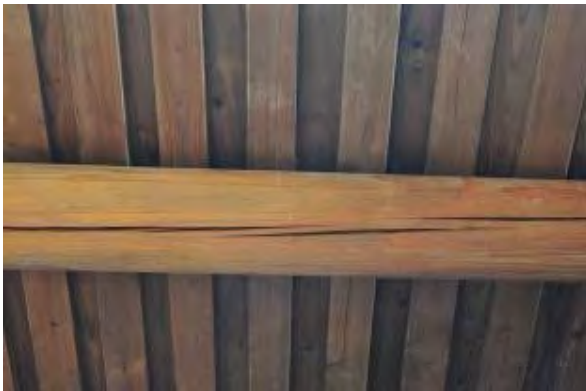
照片 4-2- 77 正廳前三架下緣全根劈裂
