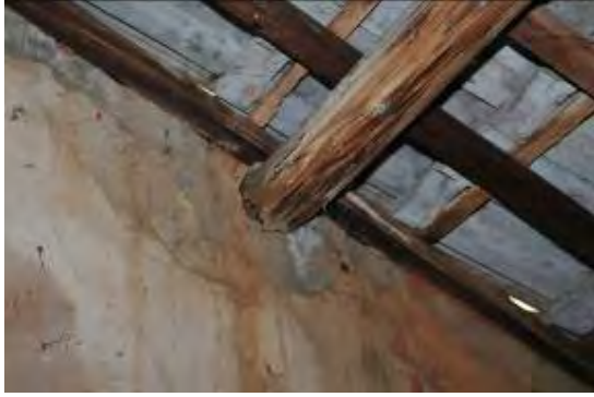
照片 5-6-51 前一架左端與壁體交接處嚴重蛀蝕
