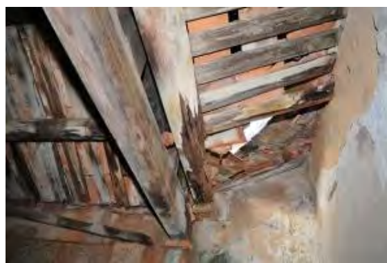
照片 5-1- 129 左護龍右房挑檐嚴重腐朽
