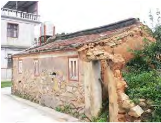
照片 5-4-37 建物現存背牆壁面損壞掉落
