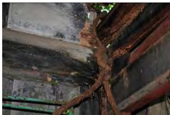
照片 5-7-37 右大通後端嚴重蛀蝕
