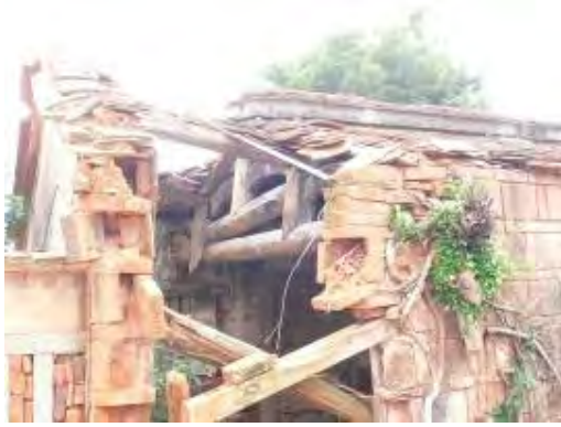
照片 5-1- 132 建物本體嚴重損毀，植物攀升
