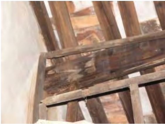
照片 5-1- 333 左後一架右端嚴重腐朽損壞
