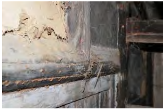
照片 5-3- 140 右大通嚴重蛀蝕
