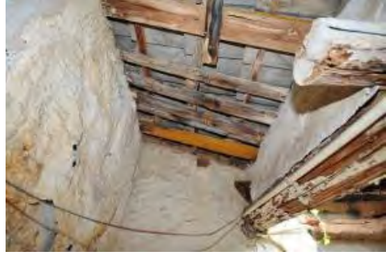
照片 5-4-52 正身挑檐構造嚴重損壞
