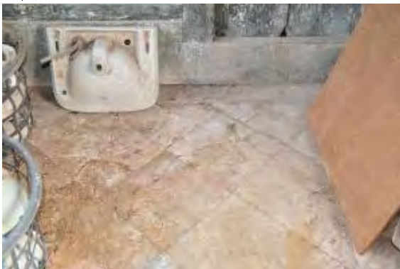
照片 5-3-33 前落地坪尺磚損壞
