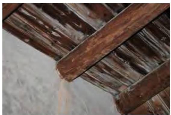
照片 5-1- 121 後落左房前一架嚴重蛀蝕
