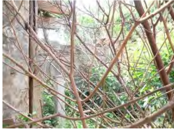
照片 5-1- 251 右二房坍塌內部植物雜生
