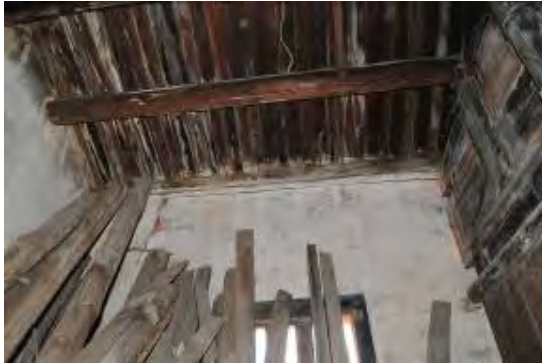
照片 5-3- 49 桷筒及後四架有蟻巢，嚴重腐朽蛀蝕
