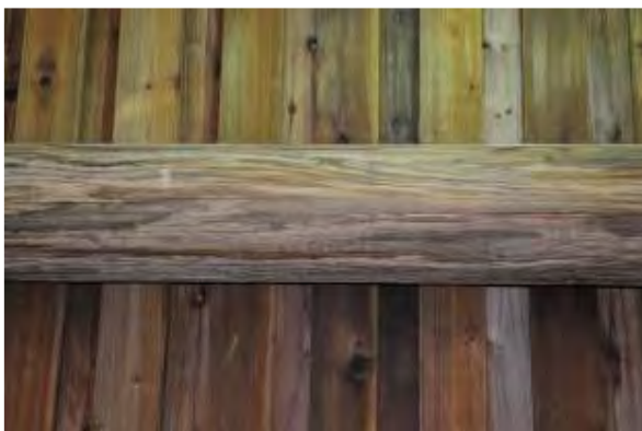
照片 4-2- 73 正廳後二架下緣全根劈裂
