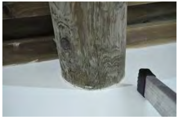
照片 4-2- 80 左後一架下緣全根劈裂
