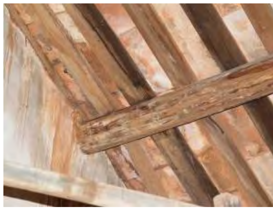
照片 5-1- 328 右後二架右端嚴重腐朽損壞
