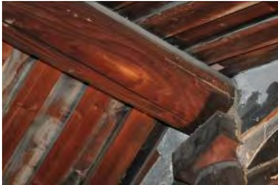
照片 5-3- 57 中脊裂縫有蟻道，內部局部蛀蝕
