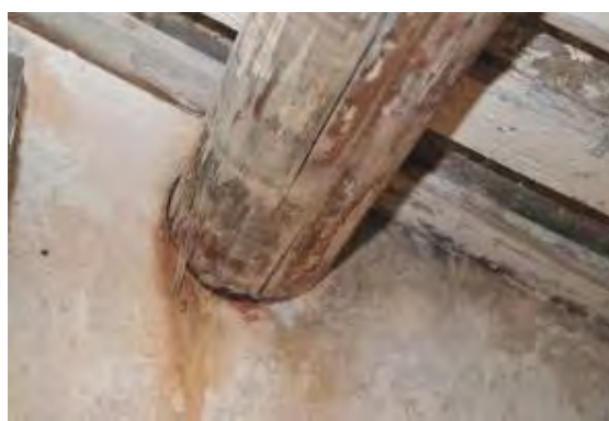
照片 5-1-25 明間後二架端部局部腐朽
