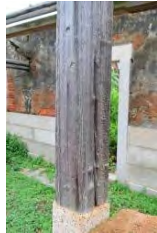
照片 5-1- 167 左前立柱劈裂
