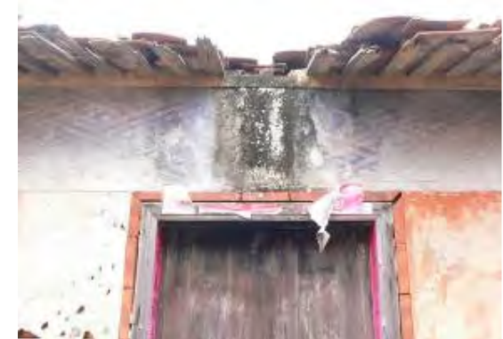
照片 5-7-12 前落前坡屋面多處毀損
