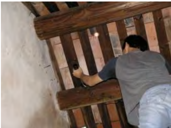
照片 5-1-268 右中脊端部輕微腐朽下緣劈裂
