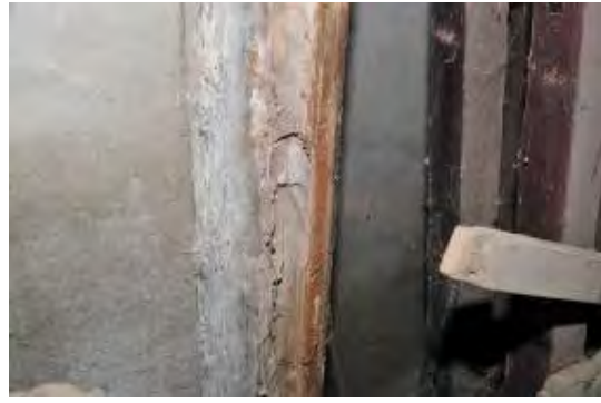
5-3- 109 左立柱下段蛀蝕嚴重
