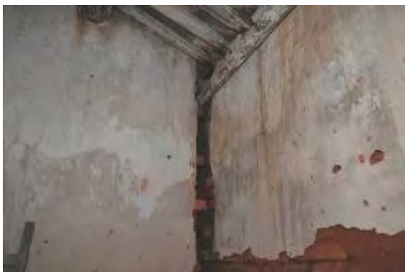
照片 5-1-16 磚造壁體嚴重脫開
