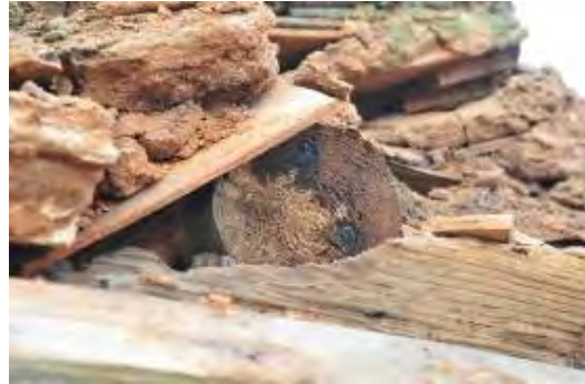
照片 5-1- 179 後一架嚴重腐朽
