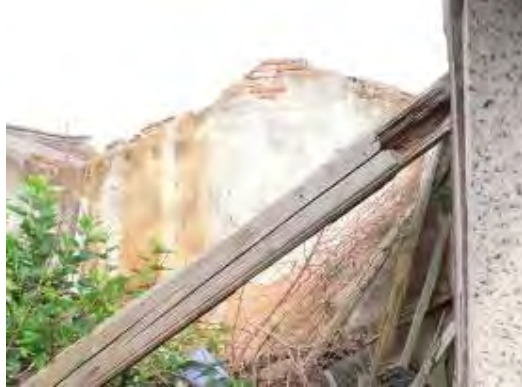
照片 5-1- 159 怡齋正廳屋頂崩塌
