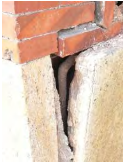
照片 5-1- 258 右護龍牆堵內樹根竄生破壞牆體
