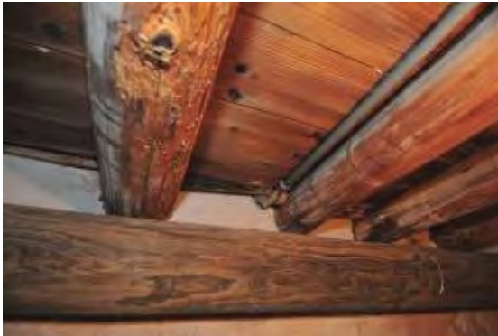
照片 4-2- 152 構件多處蛀蝕
