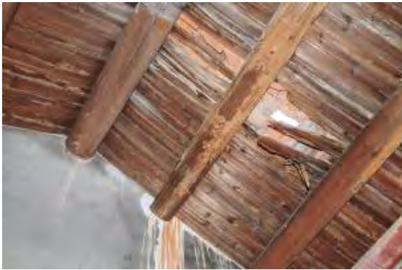
照片 5-3- 163 後落正廳屋面破損漏水嚴重
