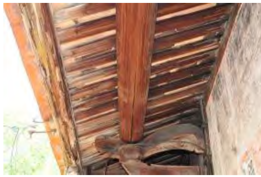
照片 5-4-26 正廳前四右端下緣劈裂
