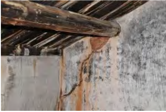
照片 5-3-39 前落右房前側壁體崩裂造成漏水
