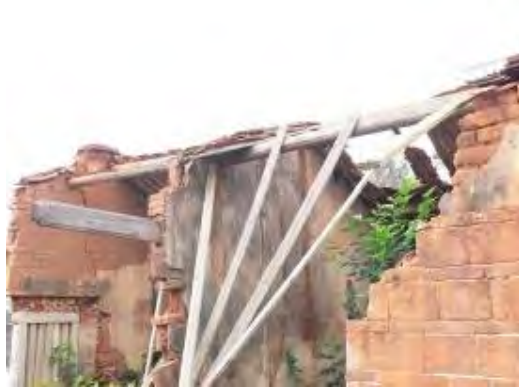
照片 5-1- 133 建物本體嚴重損毀坍塌
