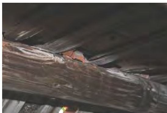
照片 5-7-35 中脊裂縫有蟻道，疑似局部蛀蝕
