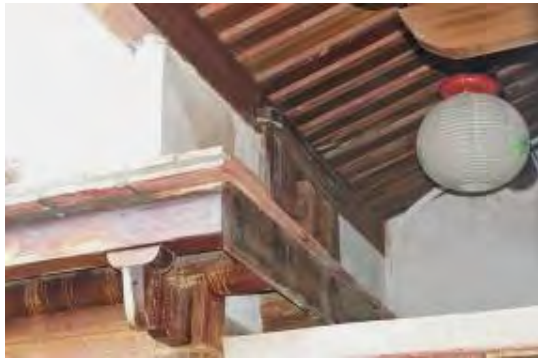
照片 4-2- 224 中落與右磚平接合部位曾滲水
