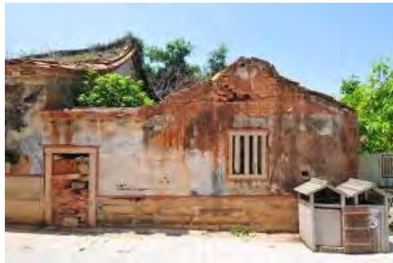
照片 5-1-245 增建護龍後側壁體損壞屋面崩塌
