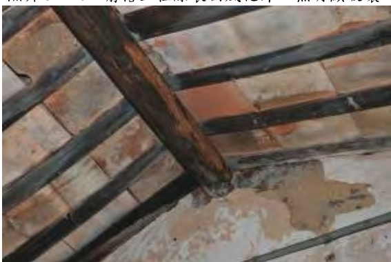
照片 5-2- 66 前落左房中脊嚴重腐朽蛀蝕
