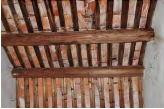
照片 5-1-280 右次間前一架端部漏水腐朽
