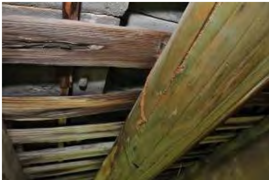
照片5-6-19 後二架表面有蟻道，內部嚴重蛀蝕
