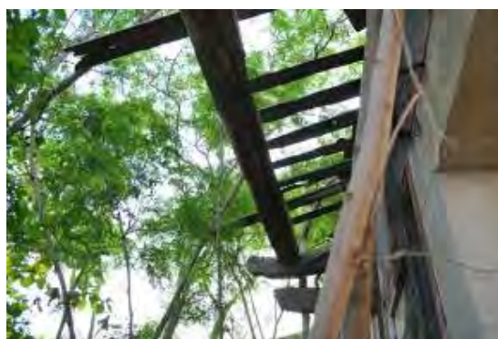
照片 5-2-29 前四架挑檐屋面崩塌已腐朽損壞
