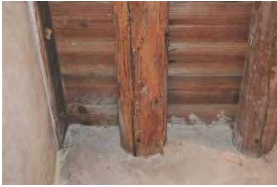
照片 4-2- 150 木樑 G-2-2 全根下緣蛀蝕嚴重
