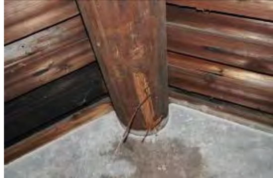
照片 5-3- 73 前落左房中脊左側上緣有蟻路、後緣嚴重劈裂
