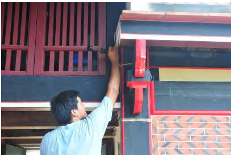
照片 4-2- 69 左擡頭外立柱表面劈裂，柱頭含水率高
