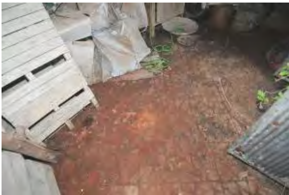
照片 5-1-20 室內地坪嚴重破損損壞
