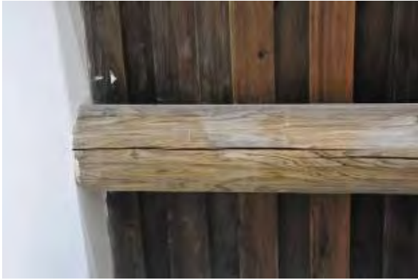
照片 4-2- 63 右後二架下緣全根劈裂
