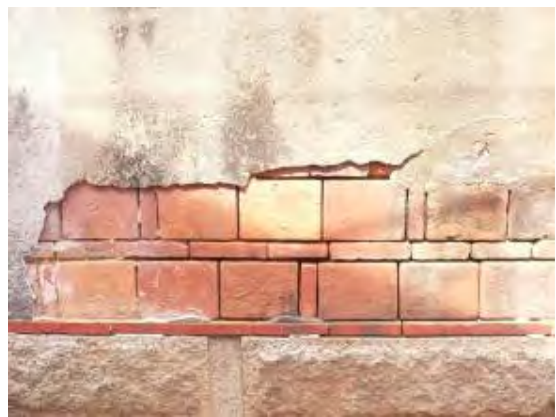
照片 5-3-12 右廂房右側外牆沙漿覆蓋面剝落
