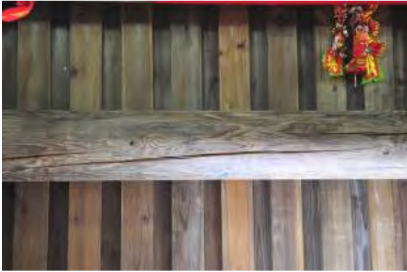
照片 4-2- 75 正廳前一架下緣全根劈裂
