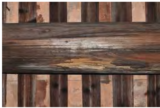
照片 5-4-24 正廳後一架約中間處嚴重腐朽蛀蝕
