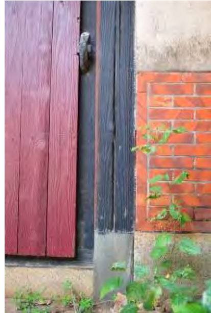
照片 5-1- 89 右後柱劈裂柱腳含水率偏高但材質良好
