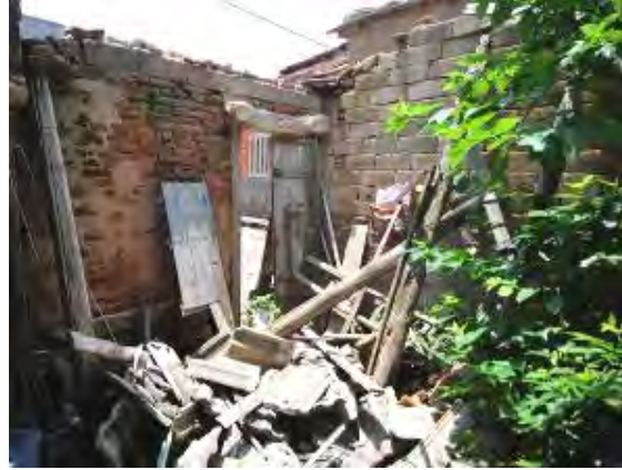
照片 5-6-4 左擗頭崩塌
