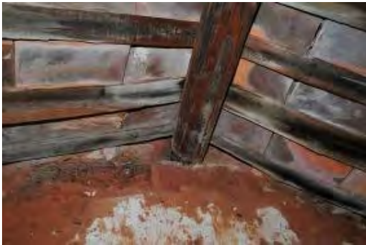
照片 5-5-21 中脊端部嚴重腐朽
