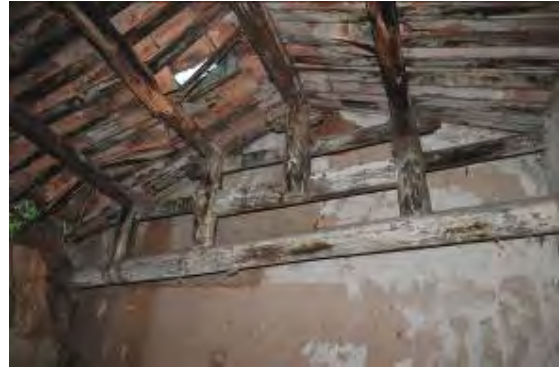
照片 5-7- 44 前落左房木作棟架嚴重腐朽蛀蝕
