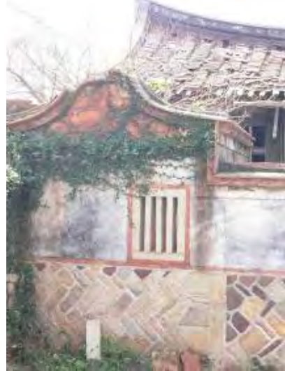
照片 5-3- 120 右擗正面藤蔓攀生、屋頂已坍塌
