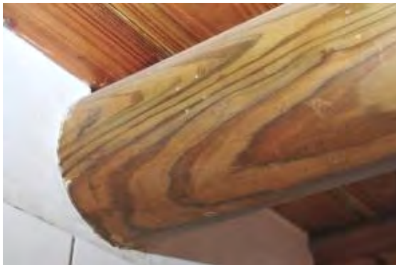
照片4-2-31 左擗頭前一架輕微裂隙
