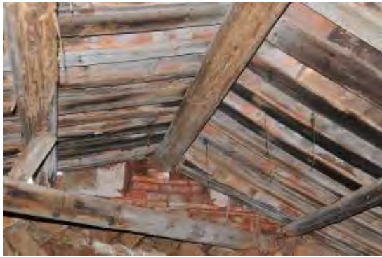
照片 5-5-25 中脊全根嚴重蛀蝕
