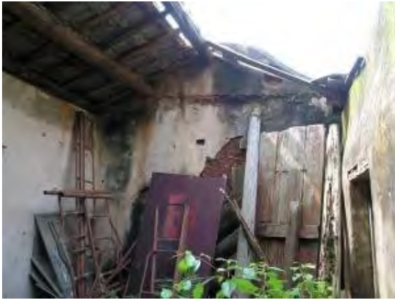
照片 5-1-339 左前一架有腐朽現象
