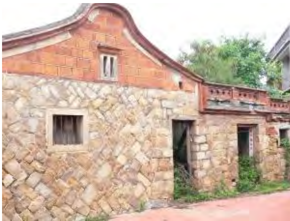
照片5-7-49 建物外觀，局部損壞
