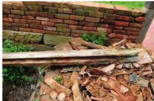
照片 5-1- 183 左側挑檐樑掉落、腐朽損壞
