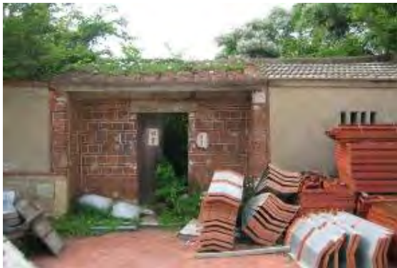
照片 5-6-27 建物外觀立面，植物四處竄升
