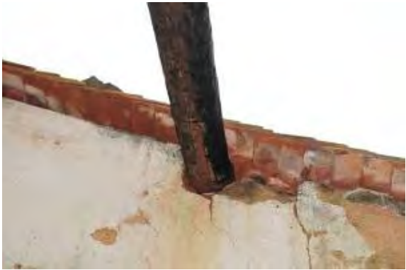
照片 5-1- 198 右次間前一架遭火害及端部腐朽
