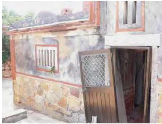
照片 5-4-16 左擗頭左側外牆灰壁局部剝落
