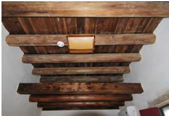
照片 4-2- 122 二樓左後房屋架
