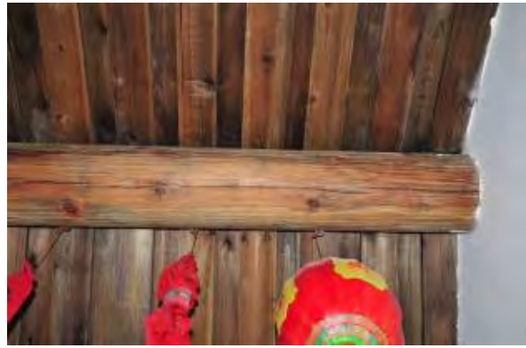
照片 4-2- 58 中脊全根下緣有裂隙
