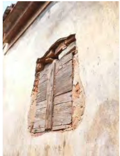
照片 5-1- 260 右護龍外牆開窗以木板封閉
