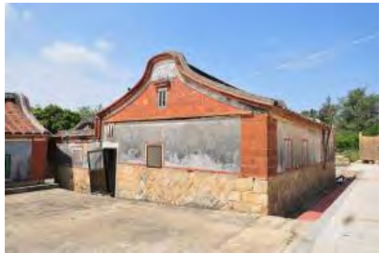
照片 5-4-6 左側與左後側牆面
