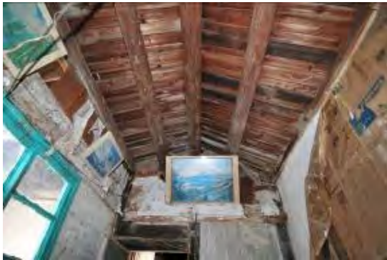
照片 5-3- 61 左擗頭後側損壞全景
