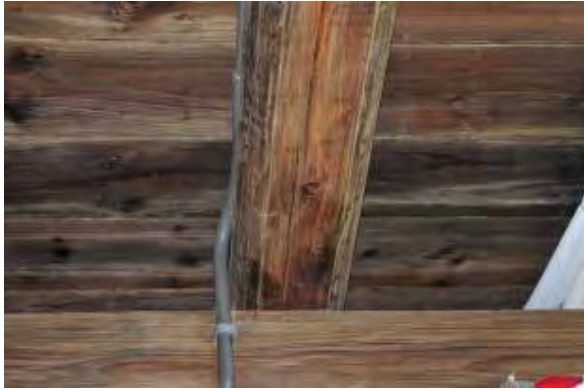
照片 4-2- 65 左擡頭左一架下緣全根劈裂
