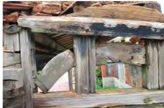
照片 5-1- 169 左構架瓜柱腐朽損壞
