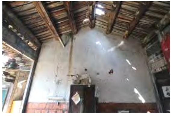
照片 5-1-73 後落正廳右側屋面破損
