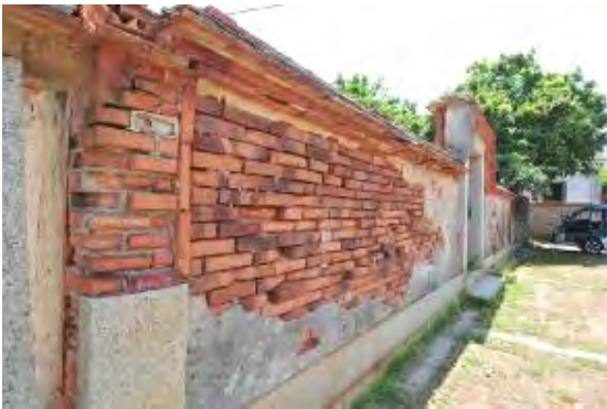
照片5-1-58 圍牆灰壁掉落磚與灰縫風化
