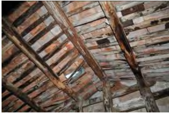
照片5-7- 43 前落左房木樑全部嚴重腐朽蛀蝕
