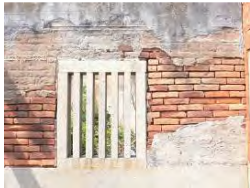
照片 5-1- 157 外牆粉刷層剝落及磚面風化
