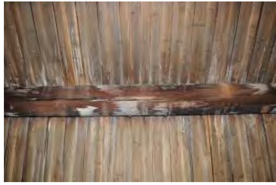
照片 5-1- 85 前落中脊材質尚可但上方屋面滲水
