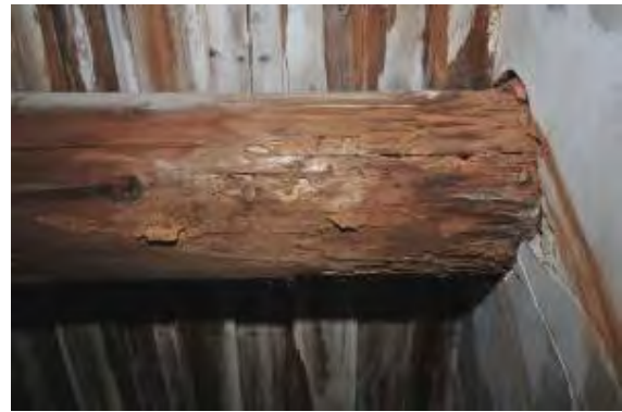
照片 5-3-176 前落正廳前一架嚴重腐朽蛀蝕
