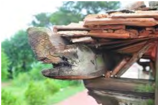
照片 5-1- 182 前挑檐上緣嚴重腐朽損壞
