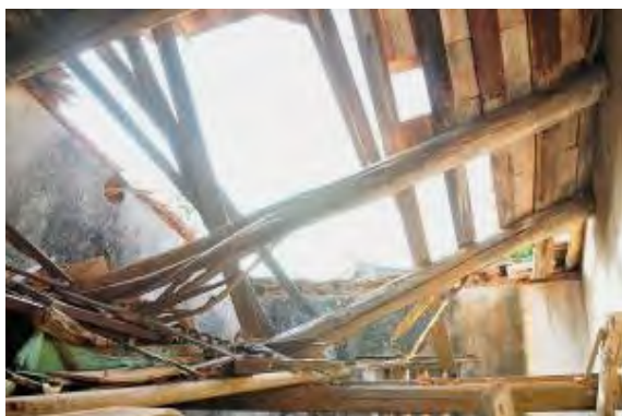
照片 5-2-30 後二後三架上方屋頂崩塌
