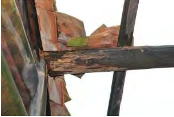
照片 5-1- 196 右次間後一架端部嚴重腐朽
