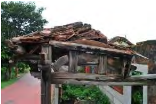
照片 5-1- 168 左構架各瓜柱均已嚴重腐朽
