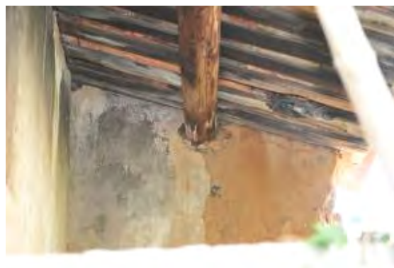
照片 5-2-77 後落左房挑檐左端腐朽嚴重
