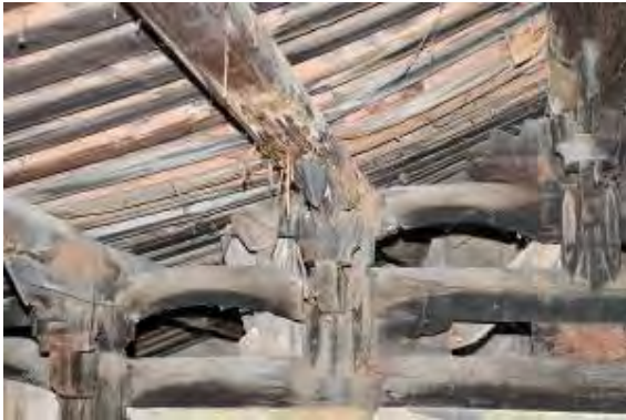
照片 5-3- 133 正身屋面破損漏水木構件腐朽蛀蝕
