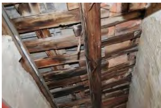
照片 5-4- 49 前三假嚴重蛀蝕及劈裂
