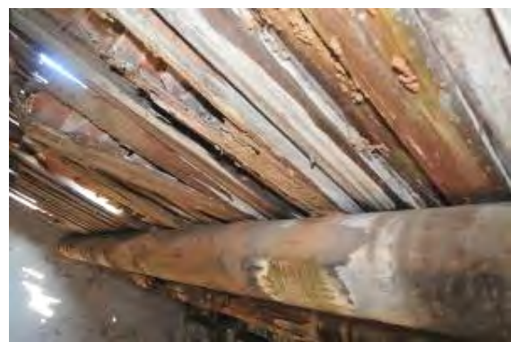
照片 5-1- 107 後一架上緣嚴重腐朽與蛀蝕
