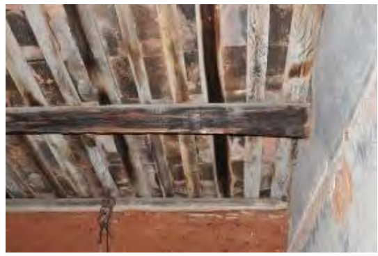
照片 5-5-26 後一架端部與牆體交接處蛀蝕腐朽
