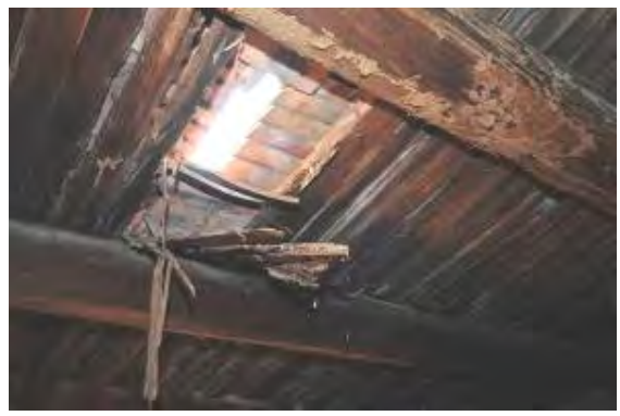
照片 5-3- 164 後落正廳屋面前一前二架破損漏水
