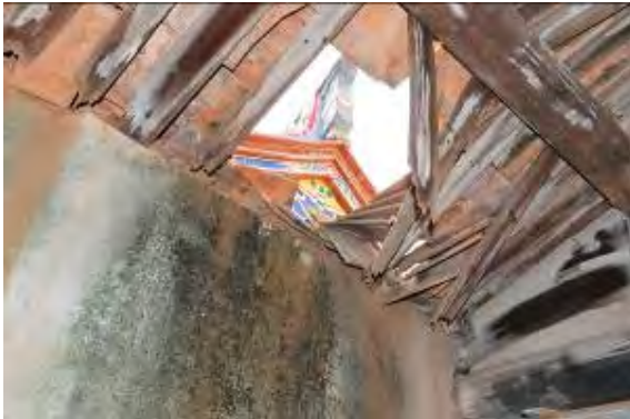
照片 5-3-93 前落左房屋頂破損
