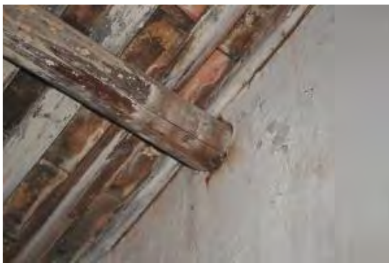
照片 5-1-30 右房後一架壁體內嚴重腐朽應抽換
