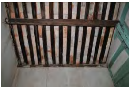
照片 5-7- 25 後落右房後二架全根劈裂腐朽
