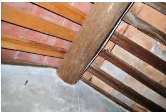
照片 5-4- 31 左房中脊左端壁體內嚴重腐朽蛀蝕
