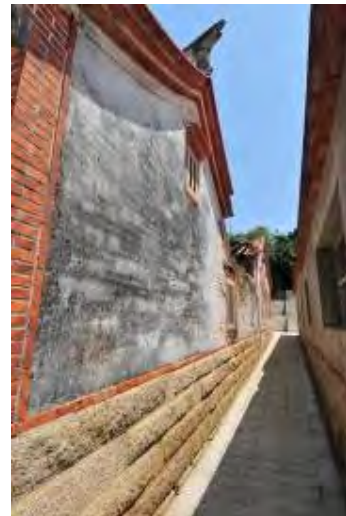
照片 5-1-227 前落左側大規壁
