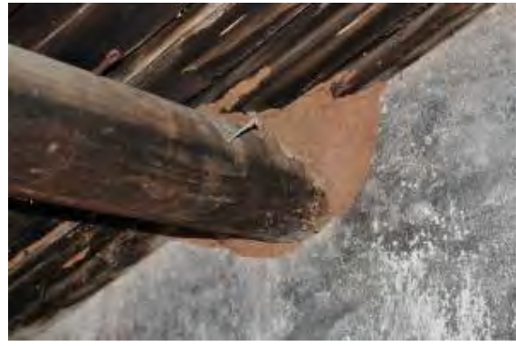
照片 5-3-40 前落前一架嚴重白蟻蛀蝕蟻巢明顯
