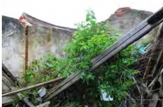
照片 5-1- 189 正廳左右構架毀損佚失
