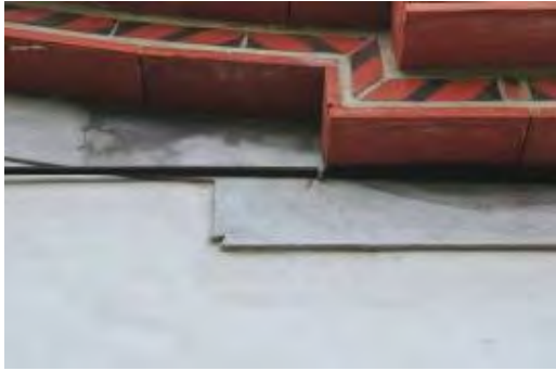
照片 4-2- 50 前落與擗頭接合部位有裂隙
