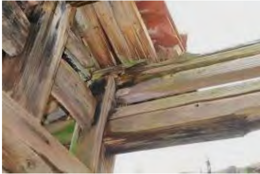
照片 5-1- 178 後二架與其下方壽樑嚴重腐朽
