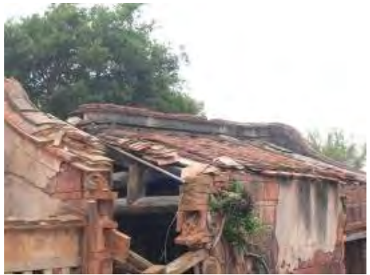
照片 5-1- 161 四維堂正廳左側屋脊、屋面坍塌
