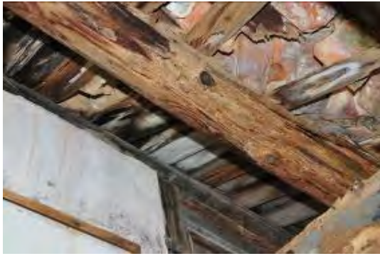
照片 5-3- 72 前落左房後三架全根嚴重腐朽蛀蝕
