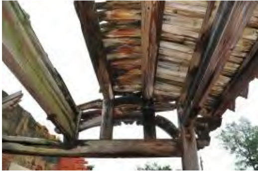
照片 5-1- 186 左構架瓜柱嚴重腐朽
