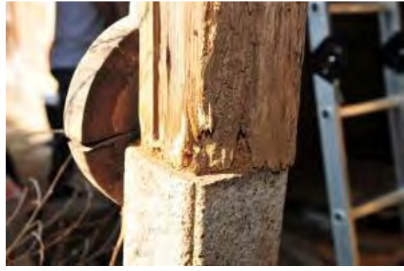
照片 5-1- 123 左前過廊左前柱嚴重腐朽
