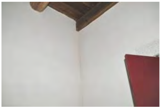
照片 4-2-114 二樓右後壁體有滲水現象
