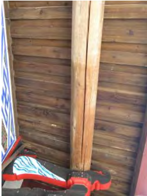
照片 4-2-194 後落前五架挑檐下緣劈裂
