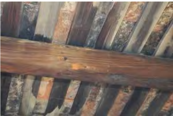
照片 5-2- 72 前三架多處蛀蝕嚴重
