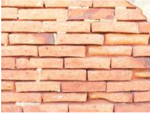
照片 5-1- 158 牆體灰縫嚴重剝落
