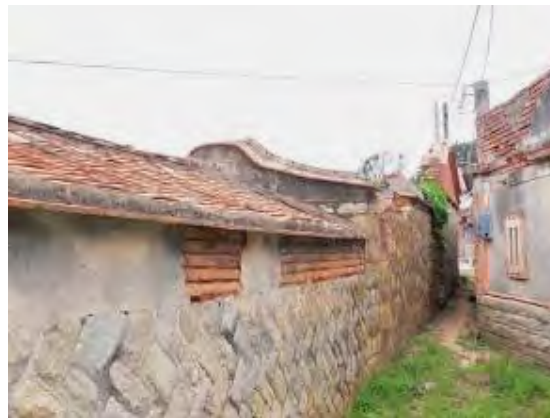
照片 5-5-2 石砌外牆尚可，粉刷層剝落
