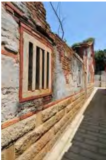
照片 5-1- 238 擗頭外壁破損
