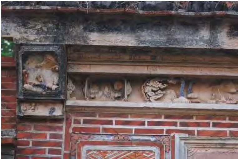
照片 5-1- 236 前落泥塑破損
