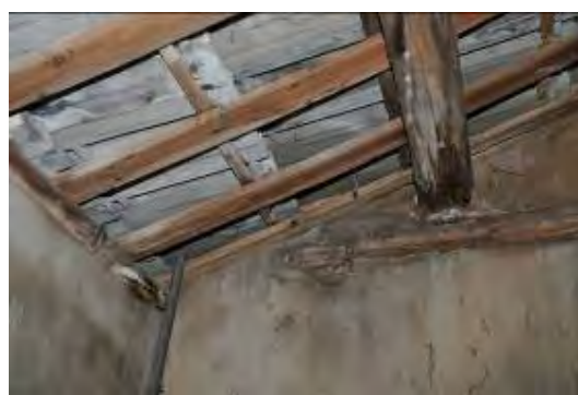
照片 5-6-48 前一、前二架右端腐朽蛀蝕
