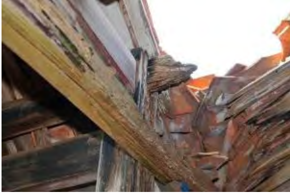
照片 5-1- 122 左前過廊左後柱嚴重腐朽
