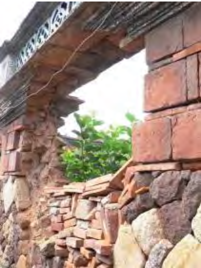
照片 5-3- 159 增建部分右次間右側牆面破損
