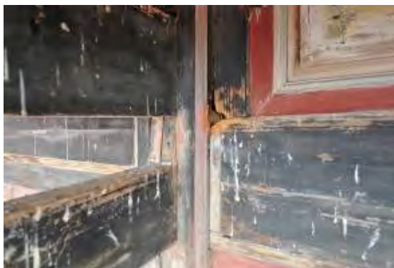
照片 4-2- 172 二樓左前楣樑右端部內蛀蝕
