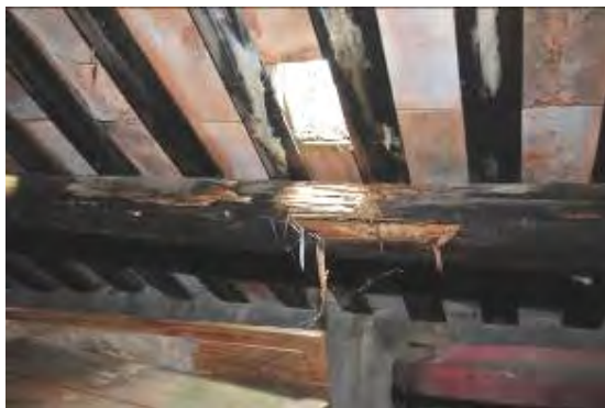
照片 5-7-29 後落左房前一架中段位置嚴重腐朽
