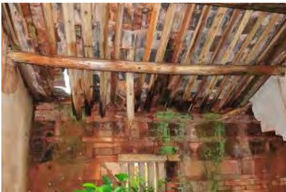
照片 5-1-202 左間後三架後四架嚴重腐朽損壞
