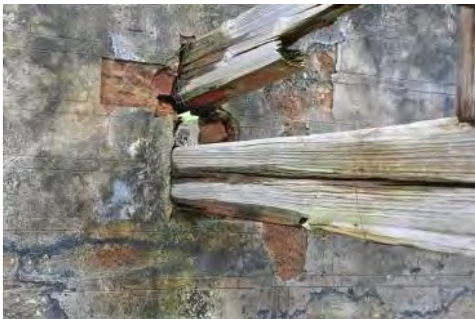
照片 5-1- 174- 右大通後側嚴重腐朽與風化
