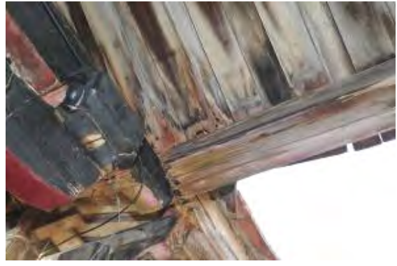
照片 5-1- 83 前落後挑檐右端嚴重腐朽
