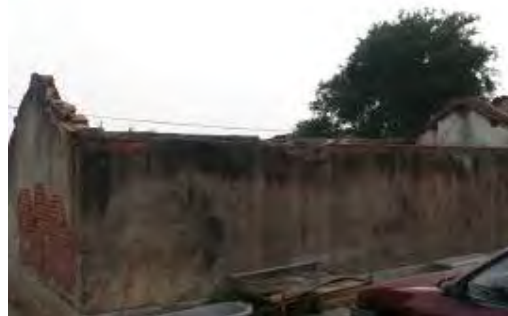
照片 5-1- 131 建築體屋頂損毀佚失
