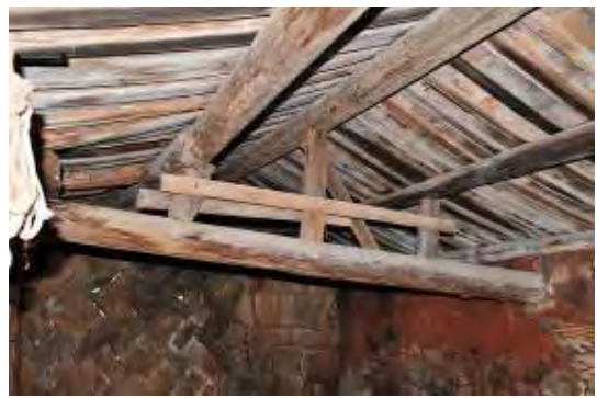
照片 5-5-27 室內全景，木構架毀損
