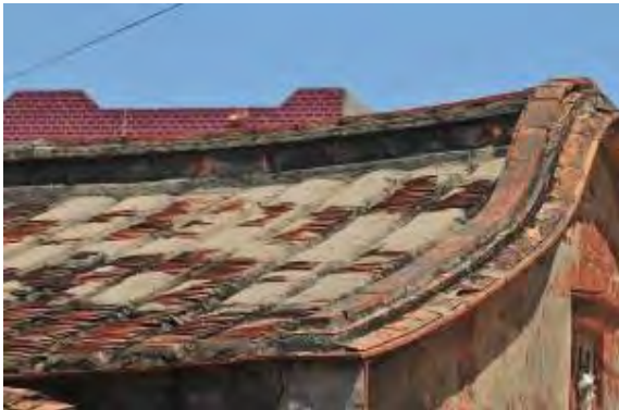
照片 5-1- 303 正身左側屋面以水泥塗抹
