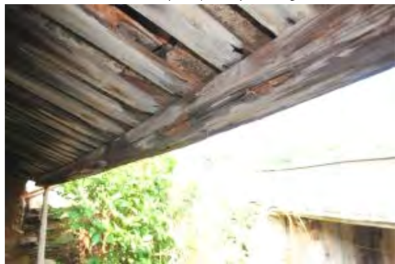
照片 5-2- 73 挑檐嚴重蛀蝕腐朽
