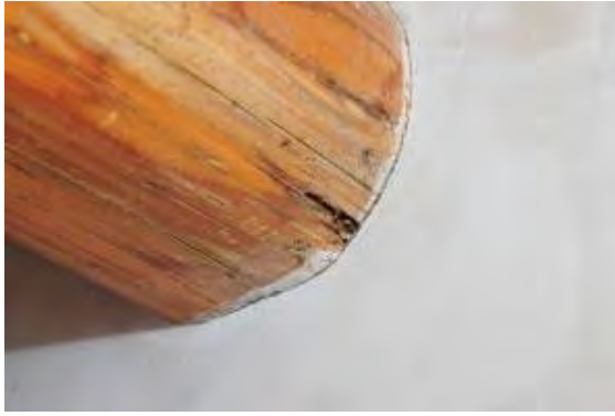
照片4-2-27 右擗頭後一架端部下緣局部蛀蝕
