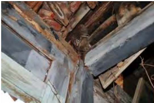
照片 5-3- 63 左前柱表面嚴重劈裂、風化、蛀蝕
