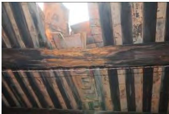
照片5-7- 58 後二架中間位置嚴重腐朽蛀蝕
