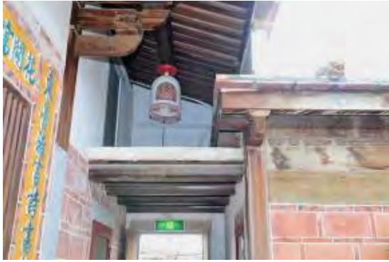
照片4-2- 223 中落與左磚平接合部位之木構造有嚴重水漬
