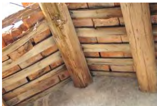
照片 5-2-27 中脊腐朽蛀蝕
