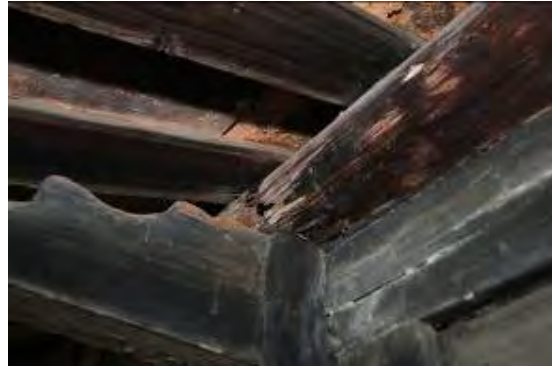
照片 5-7-20 右端榫接處腐朽前二架
