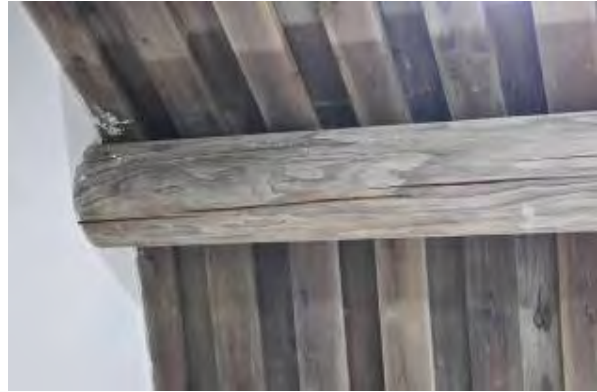
照片 4-2- 64 右中脊下緣全根劈裂
