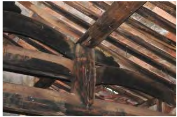
照片 5-1- 201 右次間中脊左側端部嚴重腐朽
