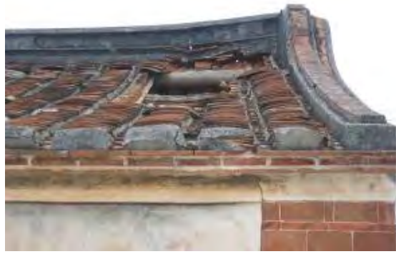
照片 5-4-4 右次間後坡屋面破損
