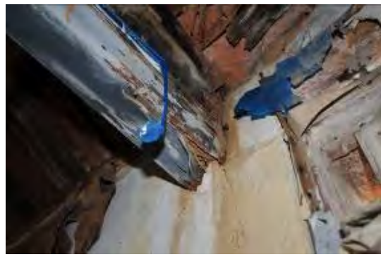
照片 5-3- 62 左前大通左側嚴重腐朽、蛀蝕
