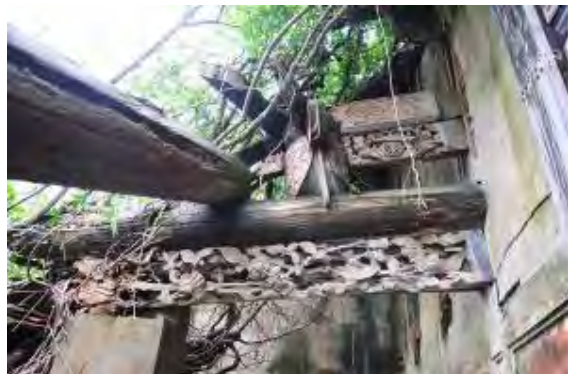
照片 5-1-283 步口右構架嚴重損壞
