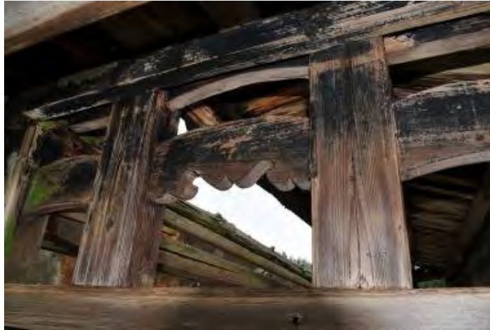
照片 5-1- 165 右側構架瓜柱表面輕微腐朽
