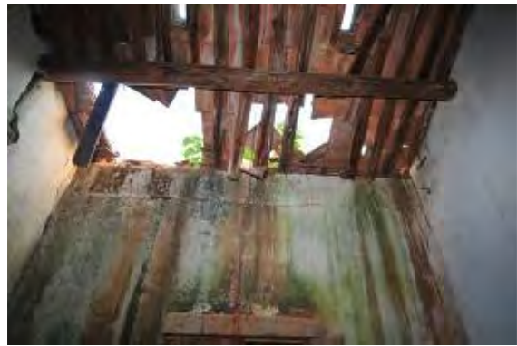
照片 5-3- 166 前落左房屋面破損嚴重
