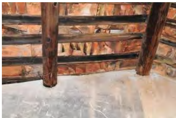
照片 5-1- 191 左中脊與左前一架端部腐朽
