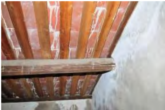
照片 5-4- 29 左房後二架右端腐朽蛀蝕
