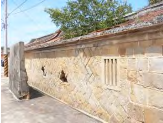
照片 5-2- 18 後廳背牆則有兩處砌石佚失
