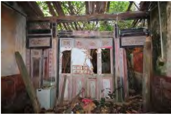
照片 5-3- 165 前落正廳屋面嚴重崩塌構件損壞
