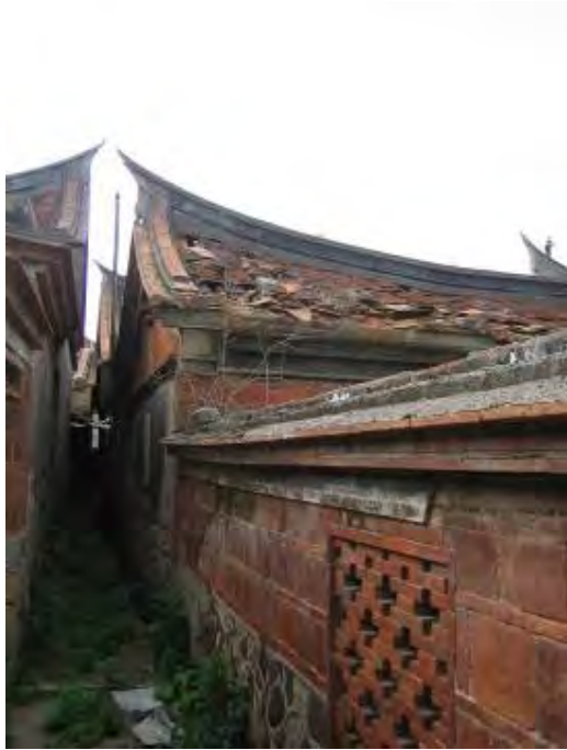
照片 5-3- 145 前落屋面部分破損
