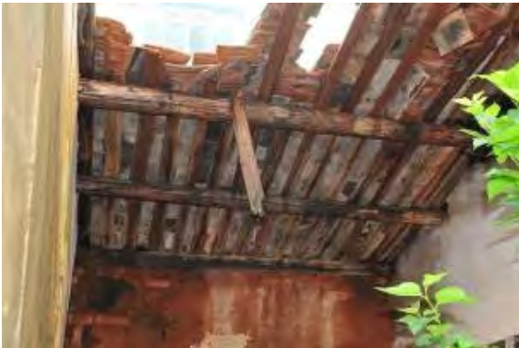
照片 5-1- 206 右間楹仔因屋面坍塌嚴重腐朽
