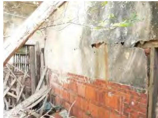
照片 5-2-17 後廳內部右側牆面粉刷層凸起
