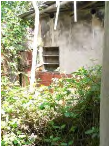
照片 5-2-16 右側房屋頂坍塌、地坪雜草生長
