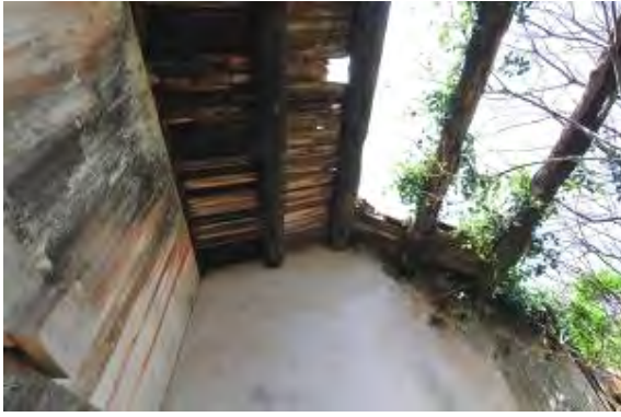
照片 5-1- 234 前落前廳屋頂崩塌
