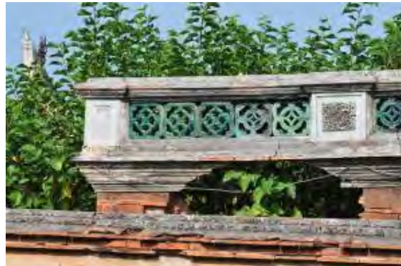
照片 5-3- 160 女兒牆下方牆體破損
