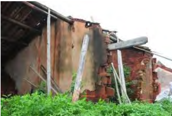
照片 5-1- 208 出厝外露腐朽
