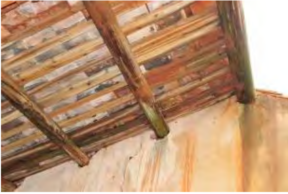
照片 5-1- 204- 左間楹仔左側端部嚴重腐朽
