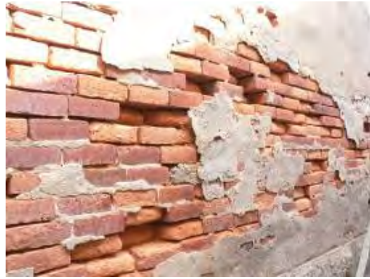
照片5-1-36 圍牆牆體表面粉刷及砌磚風化
