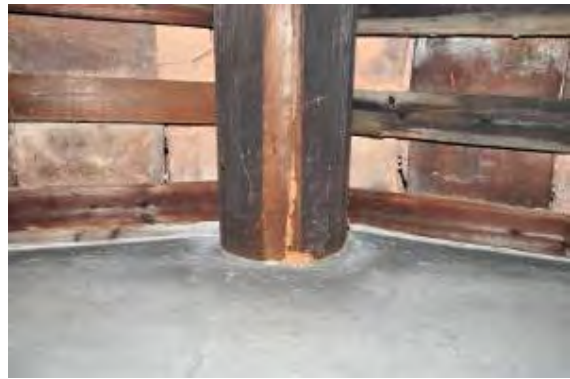
照片 5-3- 138 正身中脊嚴重蛀蝕蟻路外露
