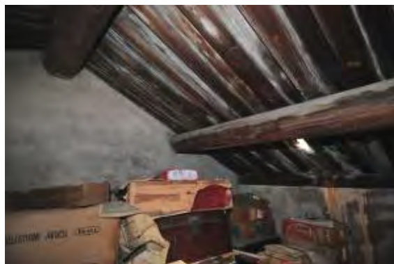
照片 5-1- 71 前落左房屋架後坡
