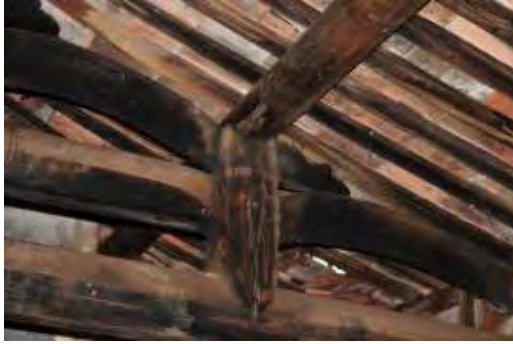
照片 5-1- 152 怡齋正廳右前側步廊屋架坍塌
