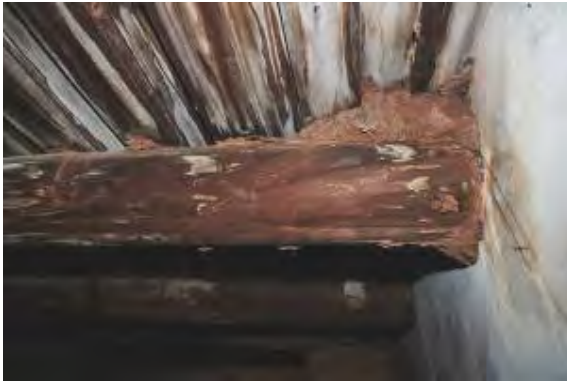
照片 5-1- 118 後落左房後三架嚴重蛀蝕
