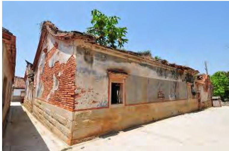
照片 5-1-243 後落大規壁與後寮牆表面損壞磚灰縫風化
