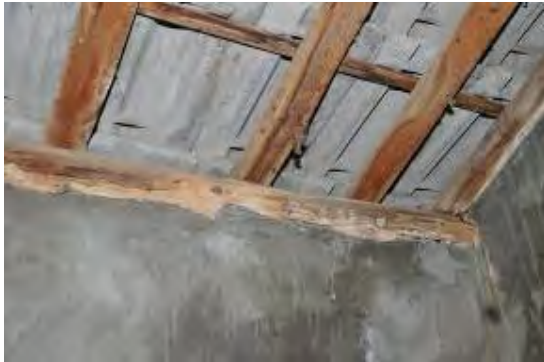
5-3- 110 右房前五架嚴重腐朽
