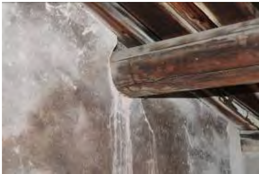
照片 5-3- 74 前落左房前二架全根嚴重劈裂，內有蟻道，局部蛀蝕
