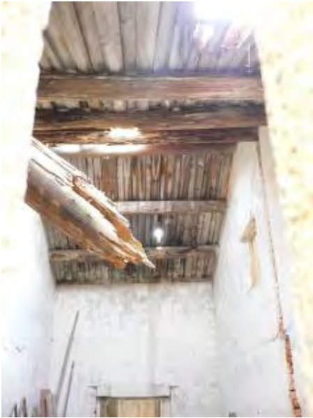
照片5-1-44 後落右房屋頂破損嚴重樑仔斷裂
