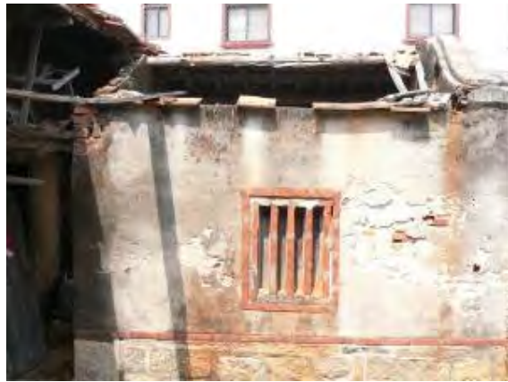
照片 5-1-314 左上舉右側屋坡坍塌
