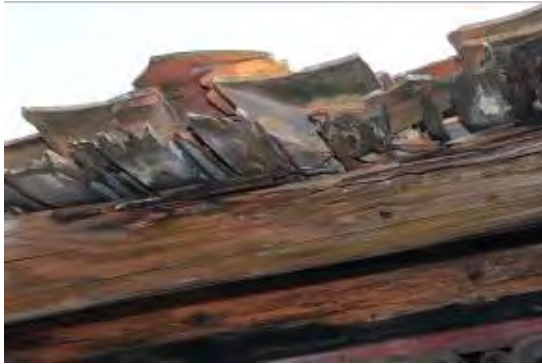
照片 5-3- 66 後三架中央嚴重腐朽、蛀蝕
