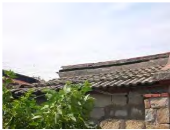
照片 5-2-49 倉庫屋面後半部塌陷，改用水泥瓦
