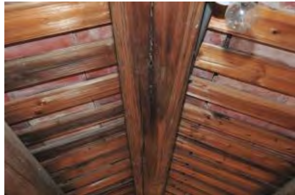
照片 4-2- 175 二樓正廳中脊下緣劈裂
