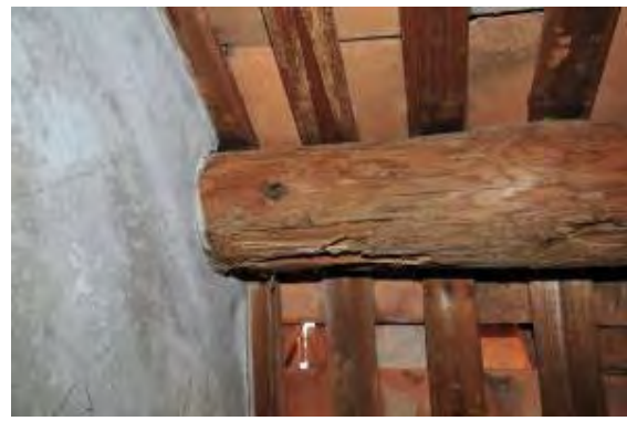
照片 5-3- 174 後落左房中脊白蟻蛀蝕嚴重
