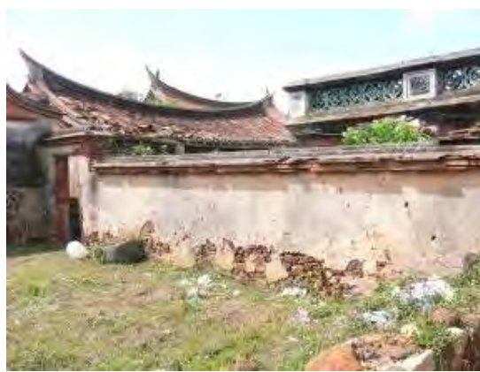
照片 5-3- 116 前庭鋪面已被雜草覆蓋（一）
