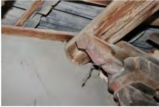
5-3- 108前三架全根下緣劈裂、右端輕微腐朽
