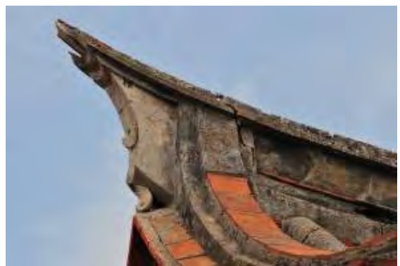
照片 5-3-28 屋脊與歸帶交接處有明顯龜裂
