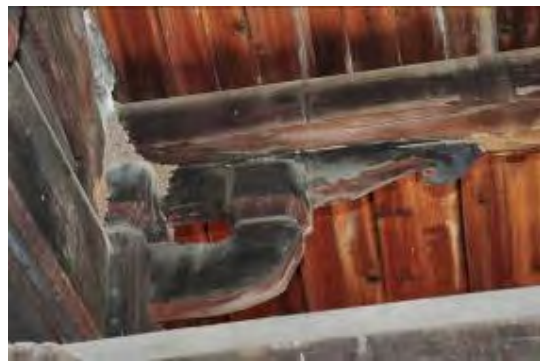
照片 5-3- 44 前二假左側端部蟻巢，內部嚴重蛀蝕
