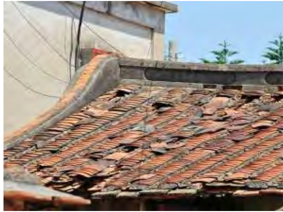
照片 5-1- 302 正身右側屋面嚴重破損
