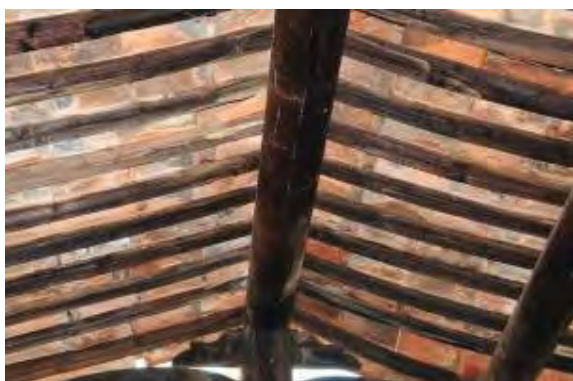
照片 5-1- 194 明間後二架（桷筒）嚴重腐朽
