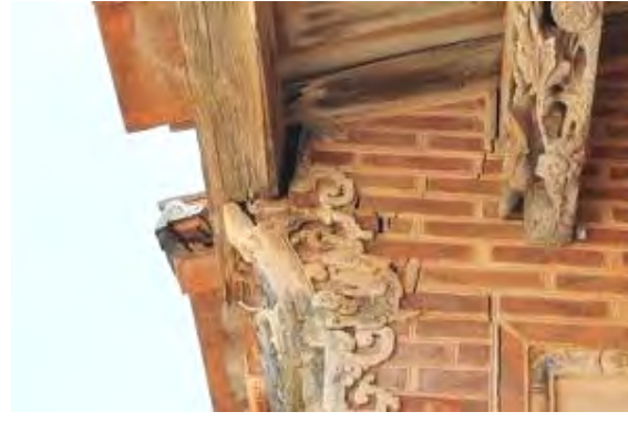
照片 5-1- 235 前落凹壽兩側壁體劈裂
