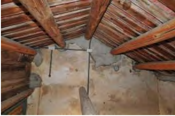
照片 4-2- 182 二樓右房右側牆面與樑仔
