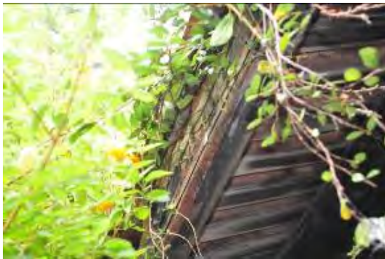
照片 5-7-21 挑簷樑前側劈裂及植物攀生
