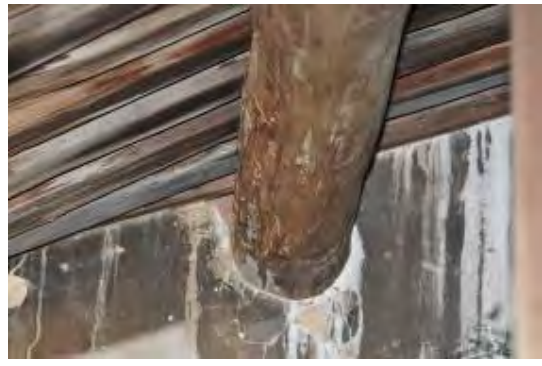
照片 5-4-28 右房前四架前緣蛀蝕及腐朽
