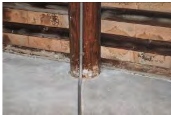
照片 5-7- 59 後一架又端部與壁體交接處腐朽
