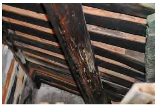
照片 5-4- 32 左房前四架嚴重蛀蝕腐朽
