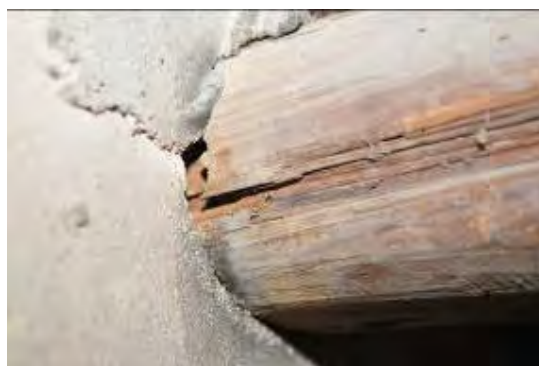
照片 5-6-36 前一架料左端壁體交接處內部蛀空
