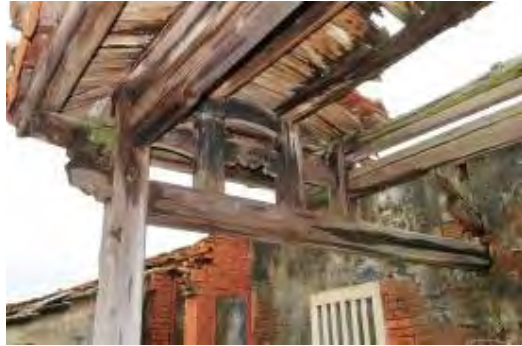
照片 5-1- 187 右構架大通後端嚴重腐朽
