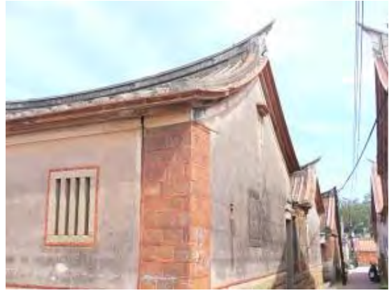
照片 5-3-14 右側外牆有一處破損
