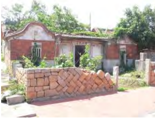
照片 5-2-12 前庭鋪面雜草覆蓋、外牆部分損毀
