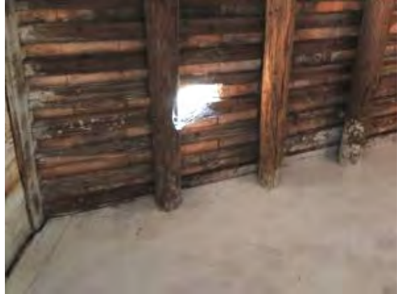
照片 5-1-265 前落右前楹仔端部輕微腐朽
