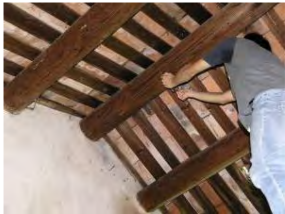
照片 5-1-269 前落右前楹仔端部輕微腐朽
