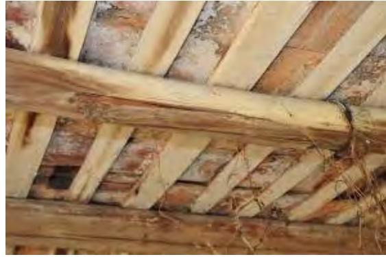
照片 5-2- 61 後一架嚴重蛀蝕腐朽
