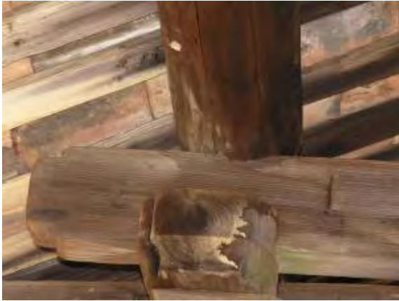
照片 5-1- 323 前四架與出展拱接合部位輕微腐朽
