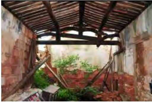
照片 5-1- 150 怡齋正廳右前側步廊屋架坍塌
