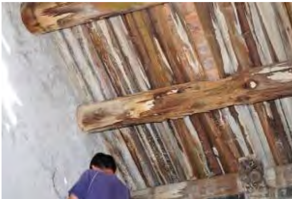
照片 5-1-76 後落正廳屋面破損漏水構件嚴重腐朽
