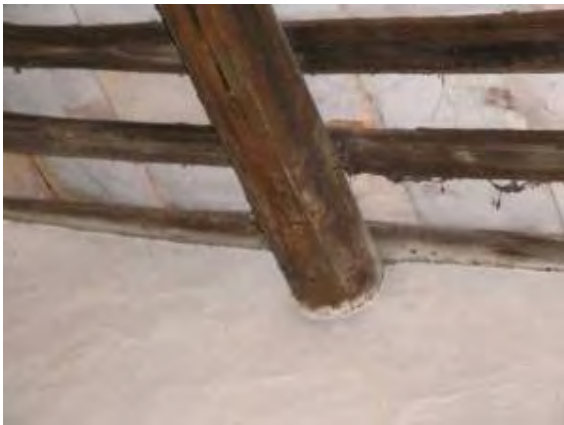
照片 5-1- 335 左前一架有腐朽現象
