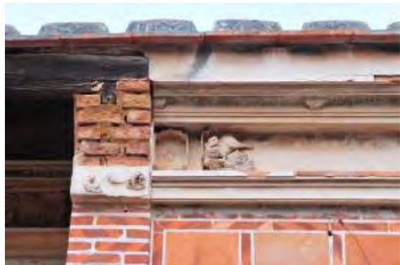
照片 5-3-36 前落左側樨頭嚴重損壞
