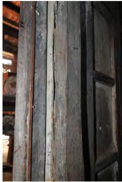
照片 5-3-48 左神龕柱後側裂縫有蟻道，局部蛀蝕
