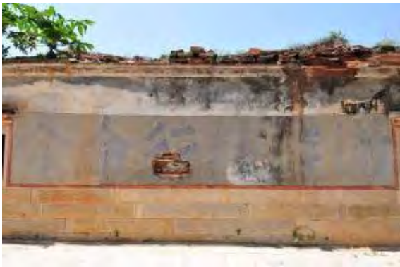
照片 5-1-244 後落壁體中央破損
