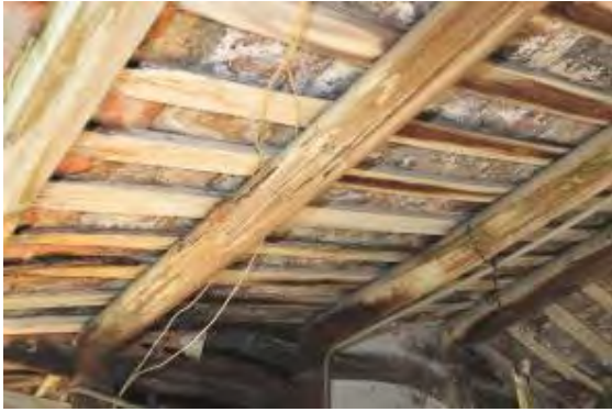
照片 5-2- 60 後二架嚴重蛀蝕腐朽
