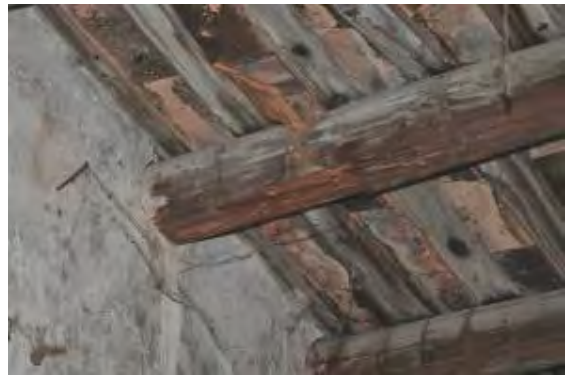
照片 5-2-39 前一架蛀蝕腐朽嚴重
