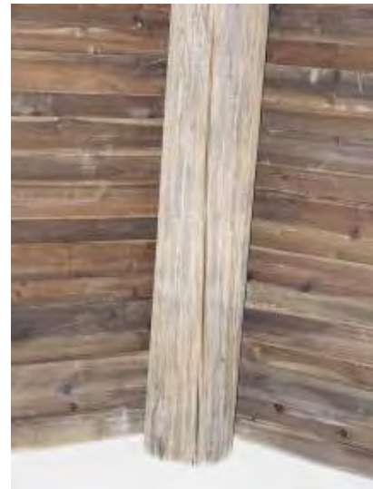
照片 4-2- 201 後落右房中脊下緣劈裂
