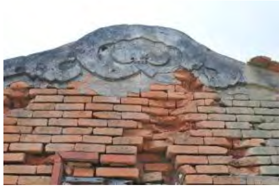
照片5-6-14 右護龍磚牆灰縫損壞磚牆風化
