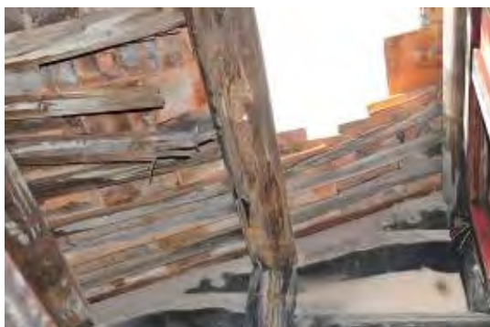
照片 5-3- 103 左次間後一架嚴重腐朽、蛀蝕
