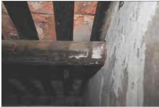
照片 5-7-27 後落左房木樑與壁體交接處現況
