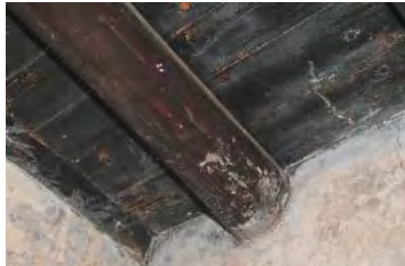
照片 4-2- 157 明間五架表面局部損壞內部尚可
