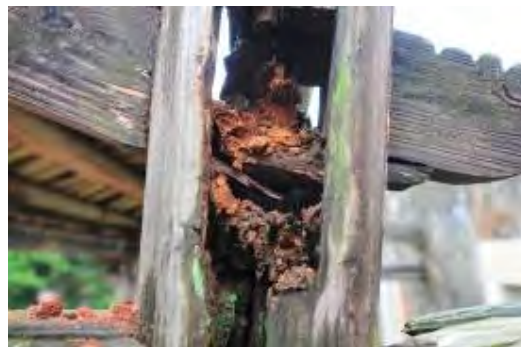
照片 5-1- 177 後壽樑端部嚴重腐朽損壞
