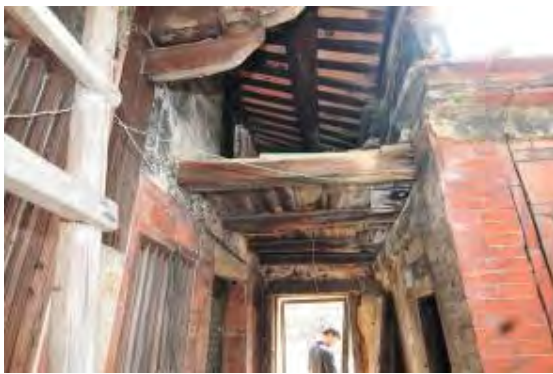
照片 5-4-21 左房前巷頭上方夾層構造嚴重腐朽
