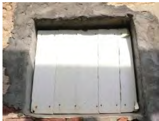
照片 5-1-41 右前房窗戶損壞以木板遮蔽
