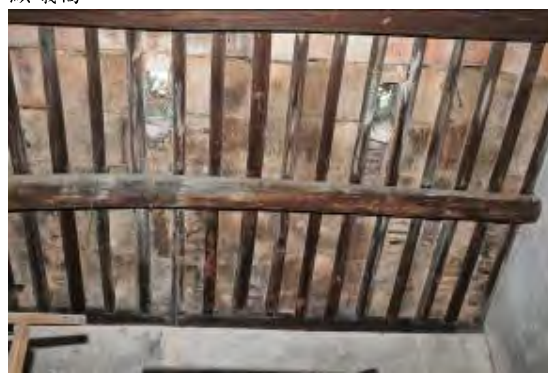
照片 5-7- 66 左房前一架多處腐朽蛀蝕
