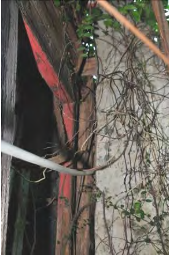
照片5-7-38 右後立柱全根嚴重蛀蝕
