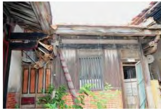
照片 5-1- 63 右擗頭前側屋面崩塌
