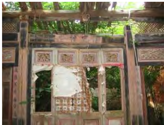
照片 5-3- 150 前落正廳屏門及屋面破損
