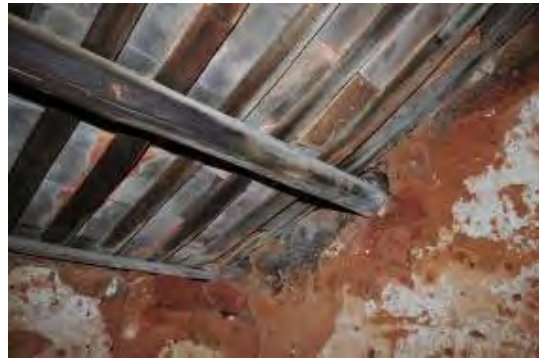
照片 5-5-22 後一架木料直徑過小，且嚴重腐朽
