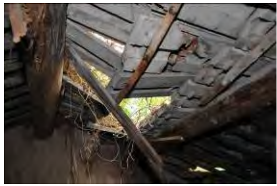
照片 5-6-44 中脊與前一架中間屋面破損
