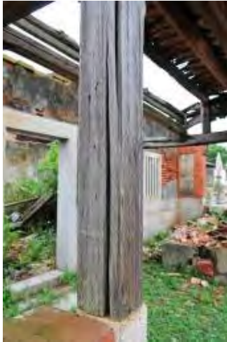
照片 5-1- 164 右前立柱劈裂
