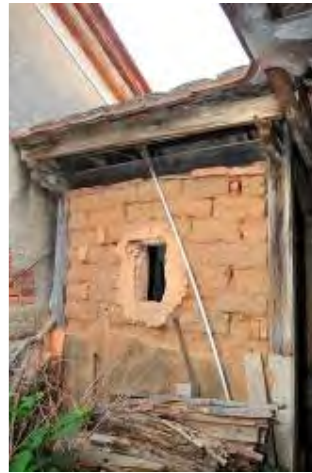
照片 5-1- 67 左側後過廊土墻牆壁體損壞
