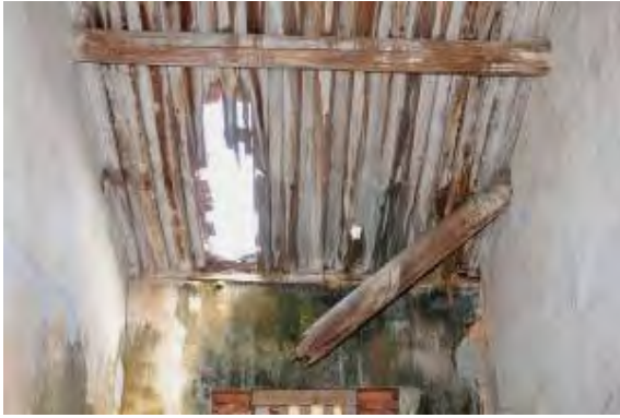
照片 5-1- 116 後落右房屋面崩塌屋樑嚴重腐朽
