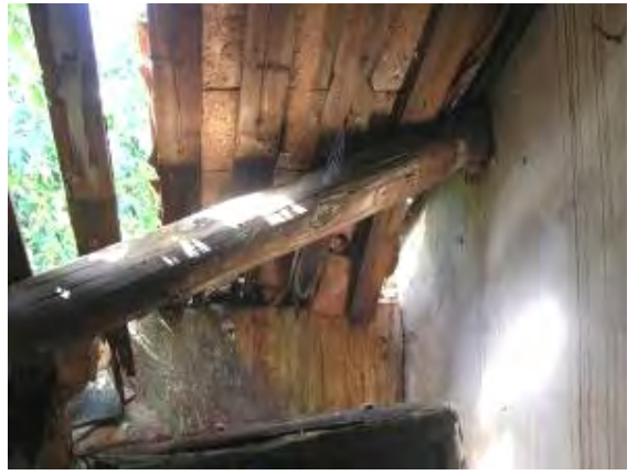
照片 5-1-267 左後楹仔因屋頂崩塌毀損
