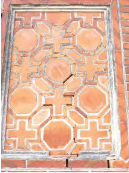
照片 5-1- 250 右前方外牆裝飾灰縫風化掉落
