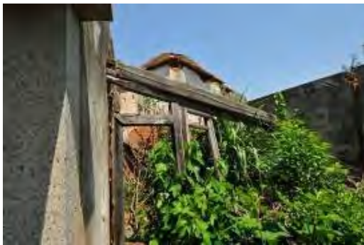
照片 5-1- 142 怡齋正廳右棟架坍塌
