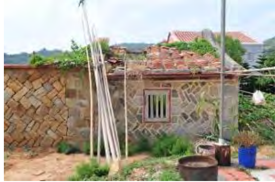
照片 5-5-16 正身右凸規屋面嚴重崩塌
