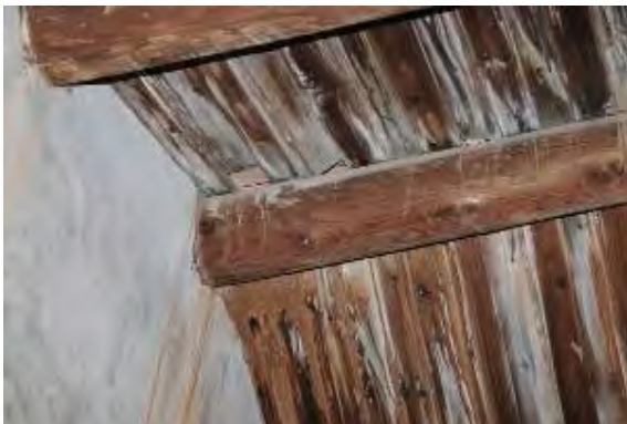
照片 5-1- 120 後落左房中脊嚴重蛀蝕
