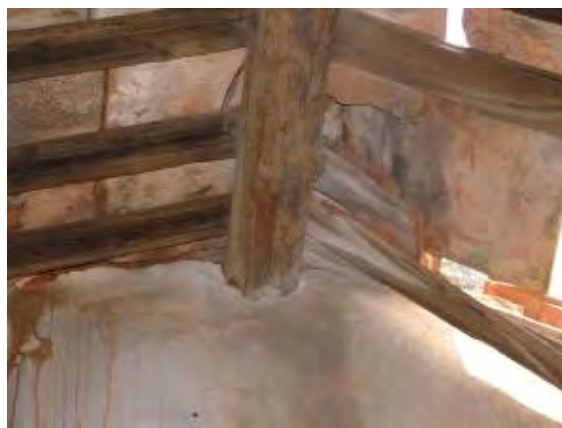
照片 5-1- 330 右中脊右端嚴重腐朽損壞
