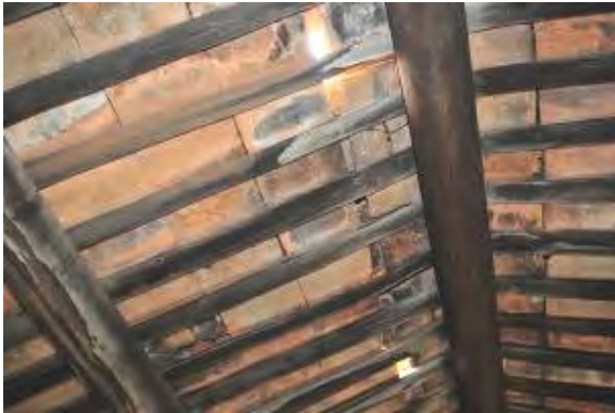
照片 5-2-56 後落屋面破損漏水
