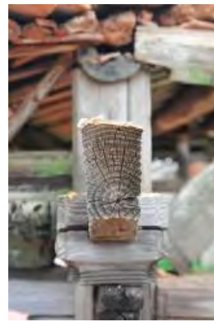
照片 5-1- 175 前壽樑局部損壞
