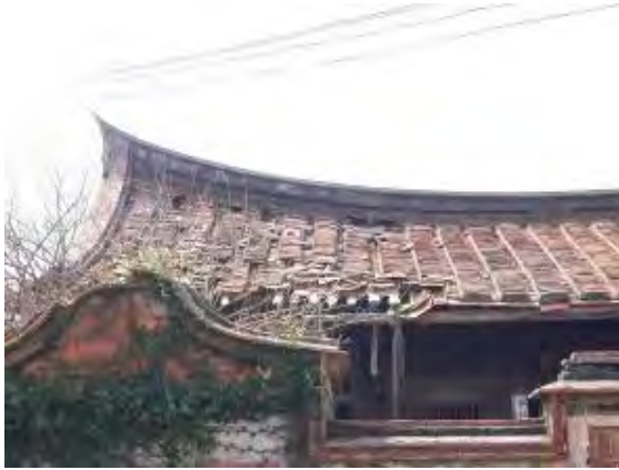
照片 5-3- 117 側屋面破損情形
