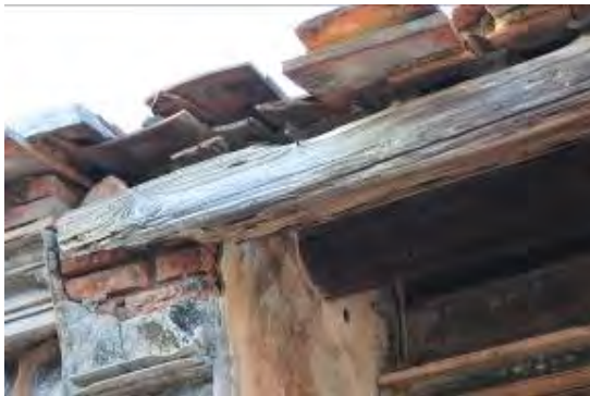
照片 5-3- 68 挑簷樑右端嚴重腐朽、蛀蝕
