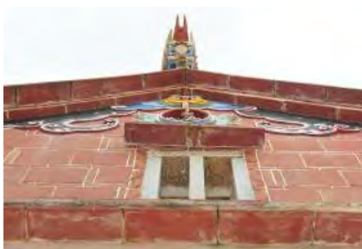
照片 4-2- 222 中落規尾窗下雨時有滲水現象
