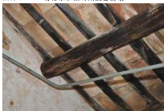
照片 5-2- 67 前落左房前一架嚴重腐朽蛀蝕
