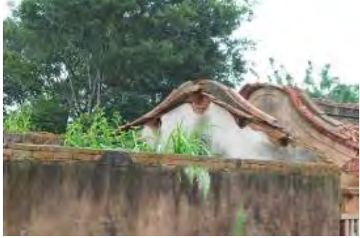
照片 5-1- 188 正廳屋架完全坍塌佚失
