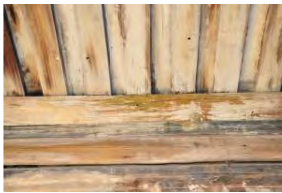
照片5-1-77 正廳楹仔因屋面漏水腐朽損壞
