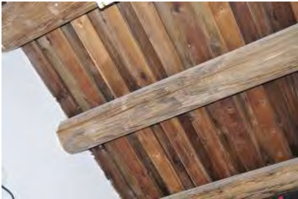
照片 4-2- 57 後二架右側端部微裂不影響構造
