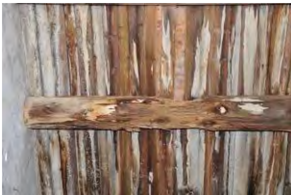
照片 5-1- 106 後二架全根嚴重蛀蝕腐朽
