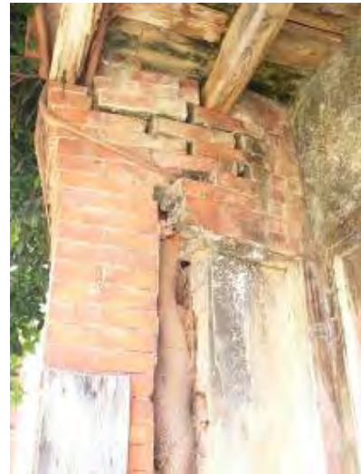
照片 5-1- 217 植物攀生根部造成牆體嚴重損壞
