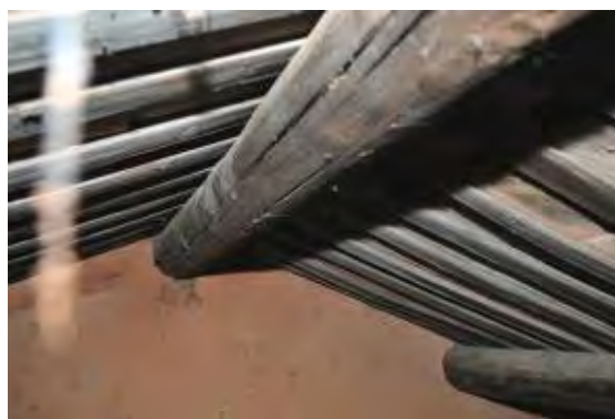
照片 5-2-75 後落左房中脊表面劈裂材質尚可
