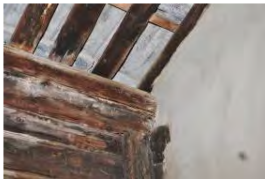
5-3- 107 前二架下緣局部蛀蝕、右端嚴重腐朽
