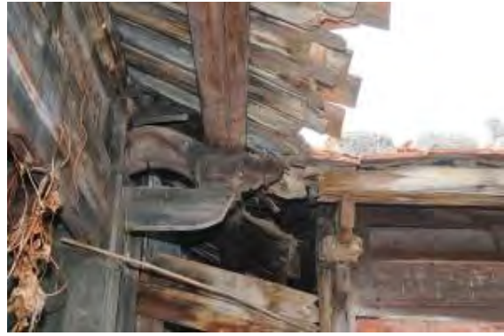
照片 5-3-30 後落簷口與擗頭交接處損壞情況
