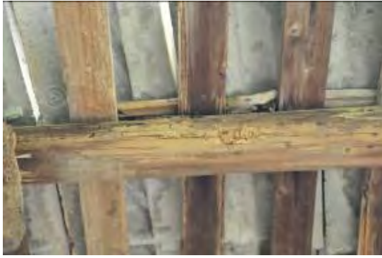
照片 5-6-37 前三架右側前緣嚴重蛀蝕
