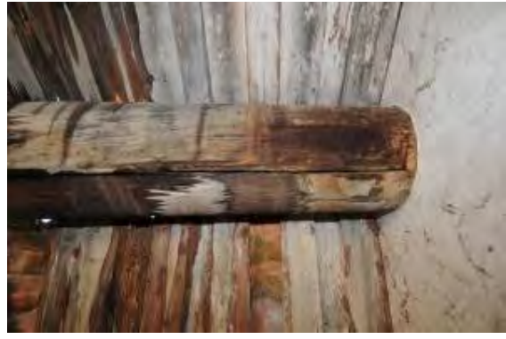
照片 5-1- 109 中脊表面局部輕微腐朽材質尚可
