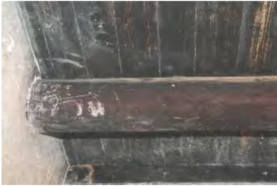
照片 4-2- 154 明間二架局部損壞，其餘大致良好
