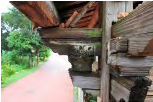
照片 5-1- 170 左前關刀拱嚴重腐朽應抽換
