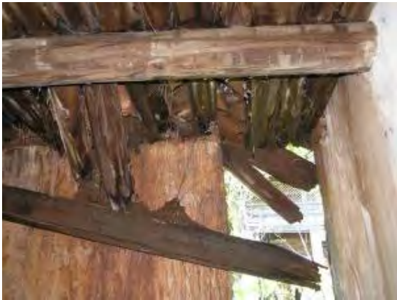
照片 5-1-266 右夾層後側崩塌毀損
