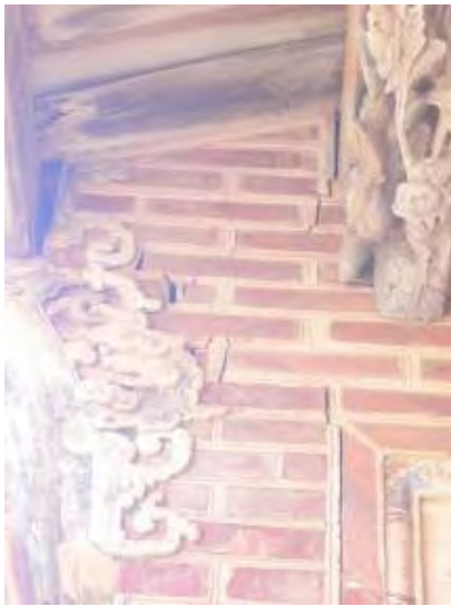
照片 5-1- 212 門廊右側壁面剪力破壞
