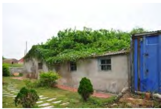
照片 5-6-28 建物背牆外觀，植物四處竄升
