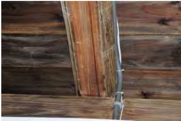
照片 4-2- 67 左擡頭左三架下緣全根劈裂
