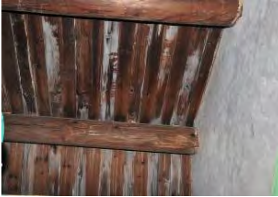
照片 5-1-94 前落右房中脊左半端局部白蟻蛀蝕、 內部疑似蛀蝕
