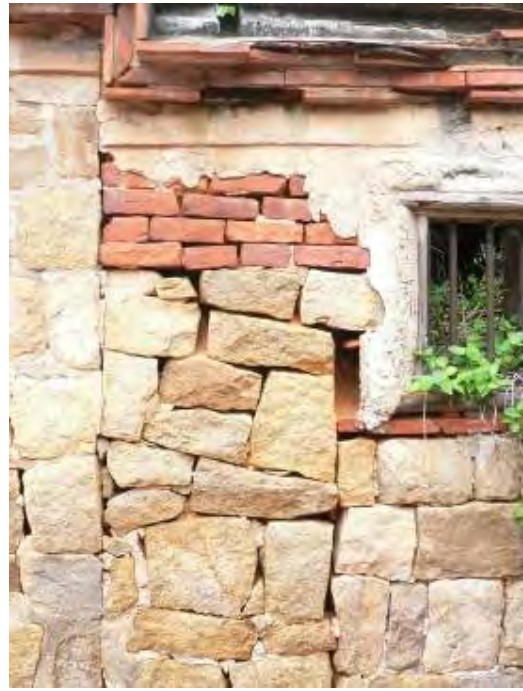
照片 5-7- 55 右擗頭牆面破損情形
