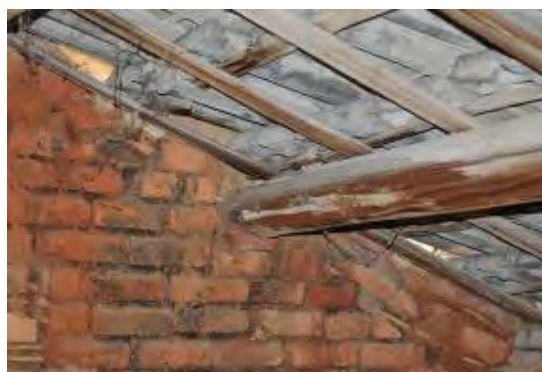
照片 5-6-24 後一假右側交接處嚴重腐朽蛀蝕
