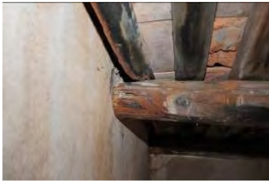
照片5-7-47 後二架右端與壁體接合處嚴重蛀蝕
