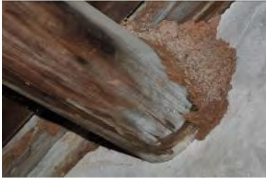
照片 5-3- 55 後四架左側有蟻巢，嚴重蛀蝕
