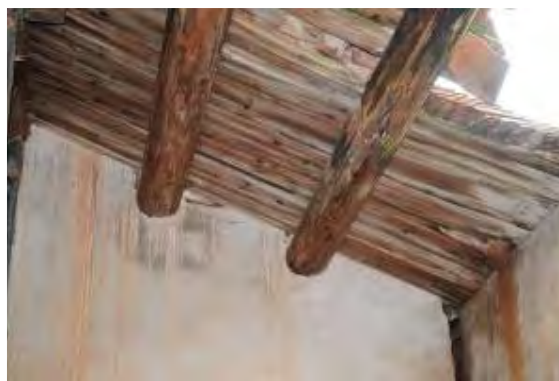
照片 5-1-271 前落右前楹仔端部輕微腐朽
