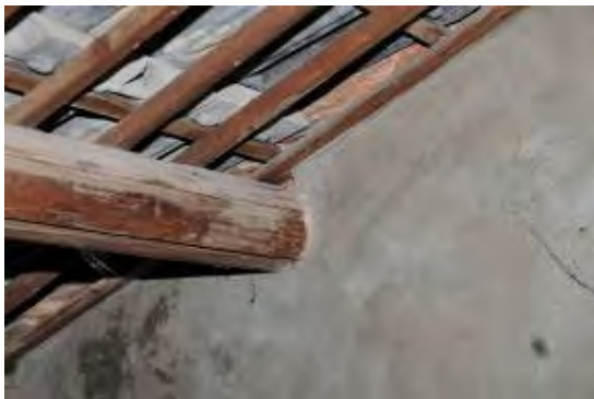
5-3- 112 左房後一架下緣嚴重劈裂、左端部腐朽
