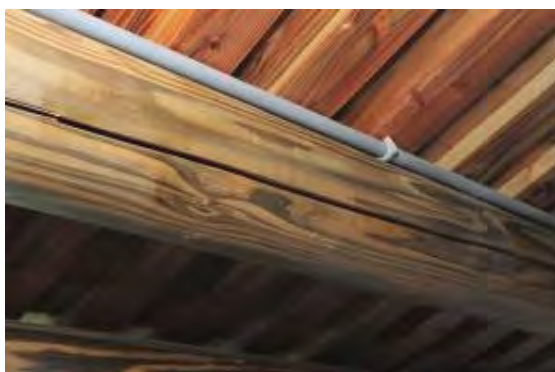
照片4-2-21 後落正廳前二架劈裂但材質良好
