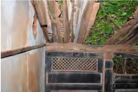
照片 5-3-175 前落正廳後三架嚴重腐朽蛀蝕
