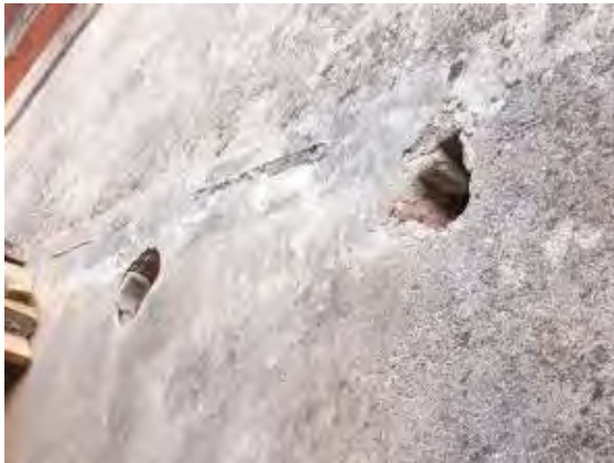
照片 5-3-15 左側牆面有兩處破損
