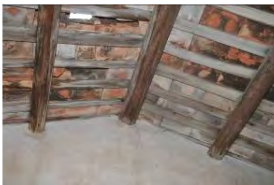
照片5-7-41 前落右房右側木樑與牆體處蛀蝕腐朽
