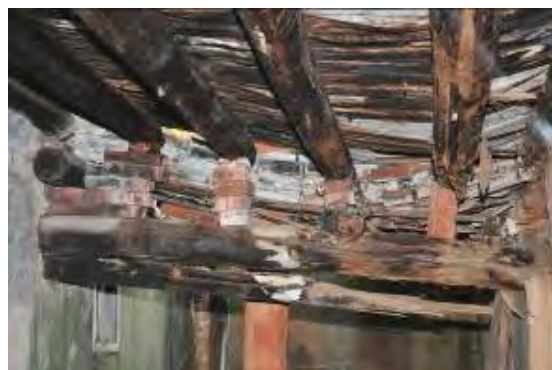
照片 5-7-31 左後擡頭與後落交接處損壞情況
