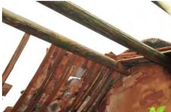
照片 5-1- 207 右間中脊及前一架與牆體接合端腐朽
