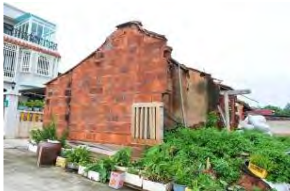
照片 5-1- 209 後落牆體前段均已崩塌屋架坍塌
