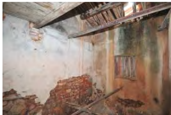
照片 5-3-90 前落左房壁體崩落
