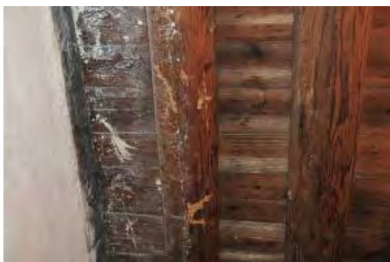
照片 4-2- 160 右二架嚴重白蟻蛀蝕應抽換
