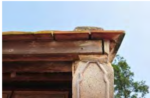
照片 4-2- 167 二樓左房前四架表面輕微損壞
