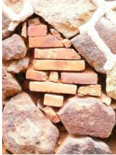
照片 5-3- 158 增建部分左次間正面牆面破損 (二)
