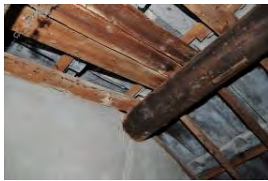
5-3- 113 左房中脊右端部腐朽
