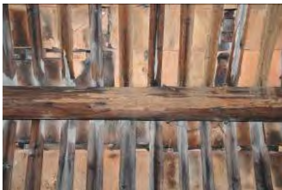
照片5-7- 60 中脊全根嚴重腐朽蛀蝕
