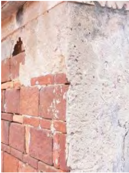
照片 5-7-15 右側外牆風化現況
