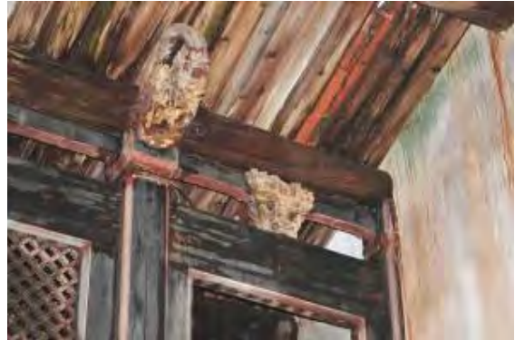
照片 5-1-273 前落右前楹仔端部輕微腐朽
