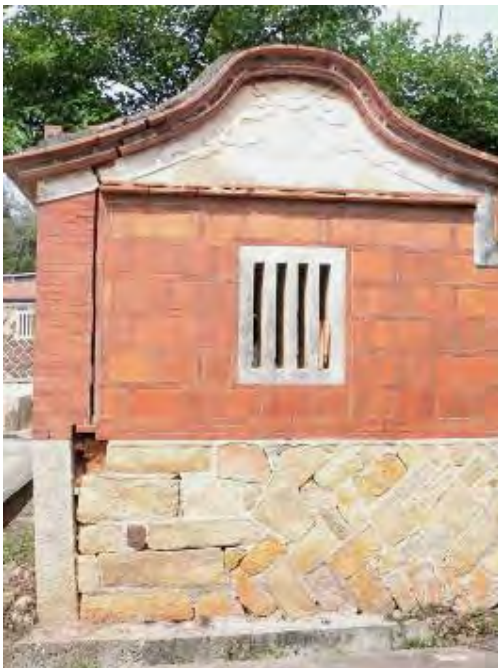
照片 5-4-17 右擗頭外牆交接處破裂
