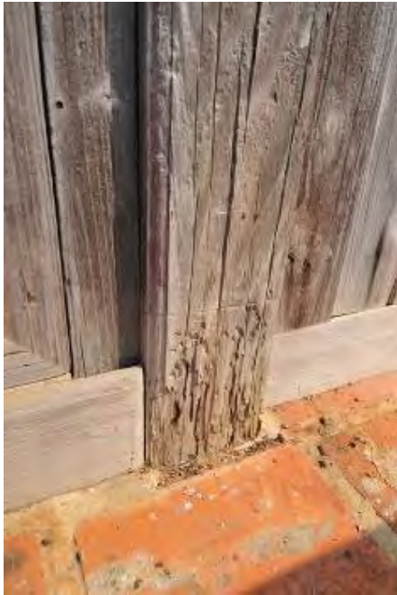
照片 4-2- 168 二樓左構架後柱柱腳表面蛀蝕
