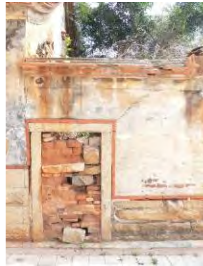
照片 5-1- 219 右護龍後門砌石封閉
