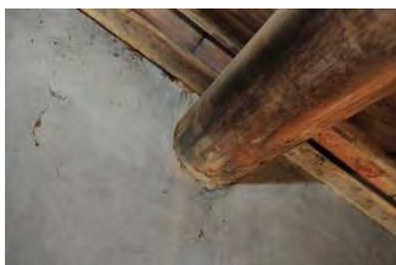
照片5-6-15 前二架與壁體接合處疑似腐朽蛀蝕
