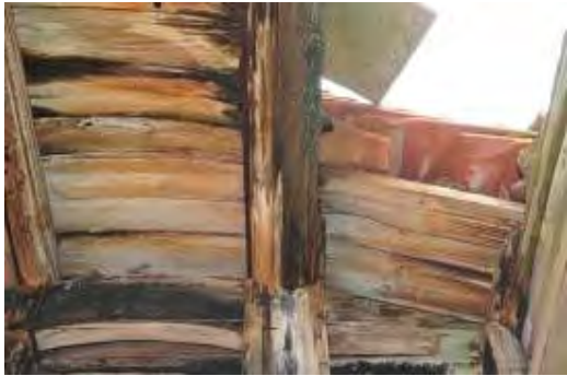
照片 5-1- 180 前一架上緣嚴重腐朽
