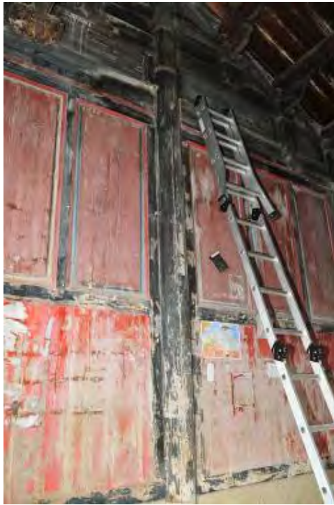
照片 5-3-47 右中立柱裂縫內有蟻道，局部蛀蝕
