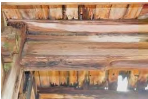
照片 5-1- 176 前壽樑端部局部輕微腐朽風化
