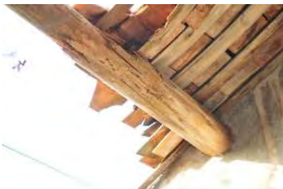
照片 5-2-26 後一架嚴重蛀蝕腐朽
