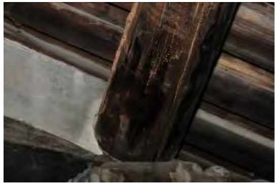
照片 5-3- 56 後三架右側裂縫有蟻道，嚴重蛀蝕
