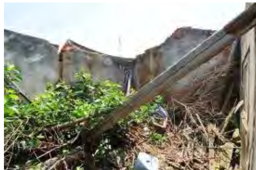
照片 5-1- 143 怡齋正廳左棟架坍塌
