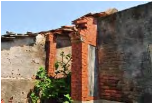
照片 5-1- 144 怡齋正廳右前側步廊屋架坍塌
