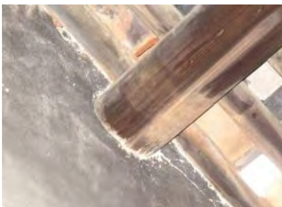
照片 5-1-319 後一架右端與牆體接合部位腐朽
