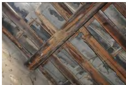
照片 5-6-34 後一架白蟻嚴重蛀蝕
