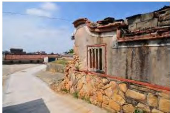
照片 5-4-40 右擡頭右側崩塌
