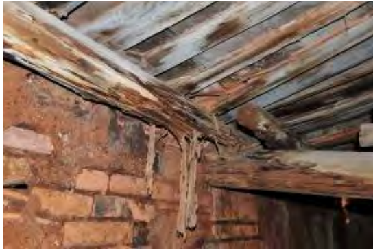
照片5-5-23 前二架木料端部榫接處嚴重腐朽蛀蝕及脫榫
