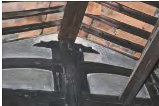
照片 5-7-22 作中柱上端蛀空劈裂
