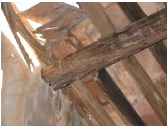
照片 5-1- 329 右後一架右端嚴重腐朽損壞
