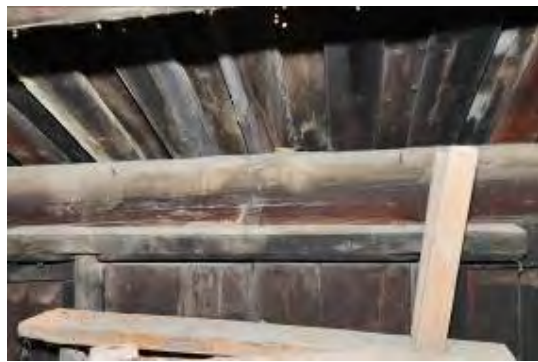
照片 5-3- 54 前三架中間有蟻道，內部局部蛀蝕
