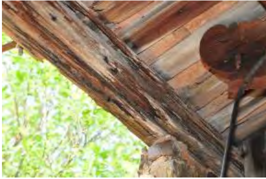
照片 5-4-27 正廳簷口樑右端嚴重腐朽
