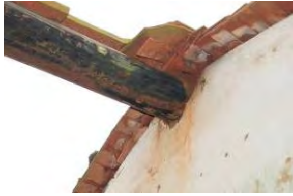
照片 5-1- 197 右次間中脊左側端部嚴重腐朽
