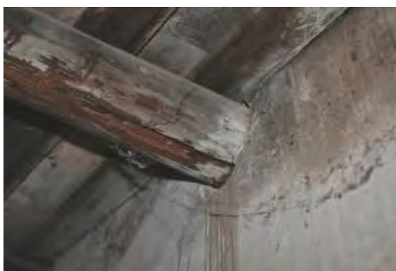
照片 5-2-36 後二架嚴重蛀蝕
