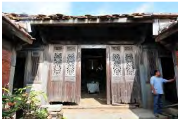
照片 5-3-34 後落立面損壞情況
