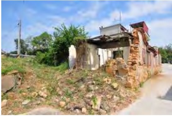
照片 5-4-35 建物右側外牆倒塌（一）
