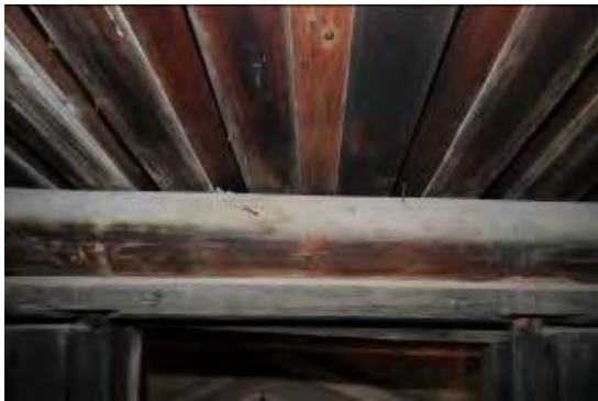
照片 5-3- 59 前三架中間下緣有蟻道，內部局部蛀蝕
