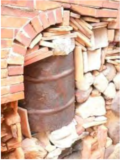
照片 5-3- 157 增建部分左次間正面牆面破損 (一)
