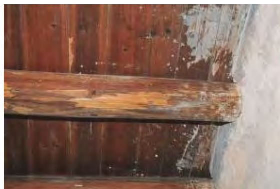
照片 4-2- 161 右六架蟻路外露蛀蝕嚴重應抽換
