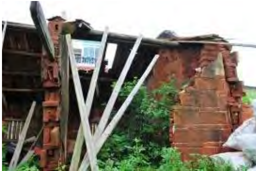
照片 5-1- 154 怡齋正廳右前側步廊屋架坍塌
