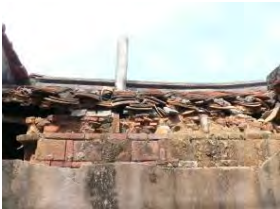
照片 5-3-11 右廂房屋面邊緣嚴重損壞
