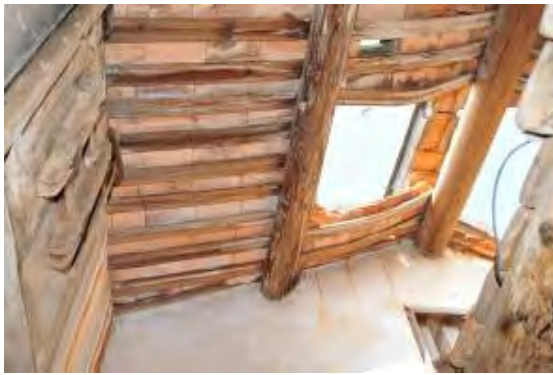
照片 5-4-19 正身右房屋面崩塌木構件毀損
