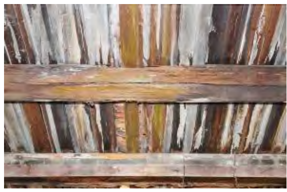
照片 5-1- 111 正廳前二架嚴重腐朽
