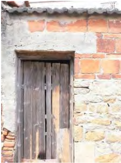
照片 5-1-315 左下舉外壁面風化屋面使用水泥瓦
