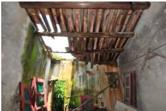
照片5-6-11 右房屋面崩塌
