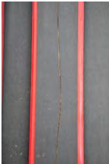
照片 4-2- 61 左門柱中央有全根乾裂造成之裂隙
