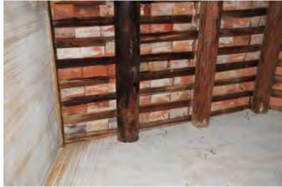
照片 5-1-281 右次間前屋面破損，前二、三架腐朽
