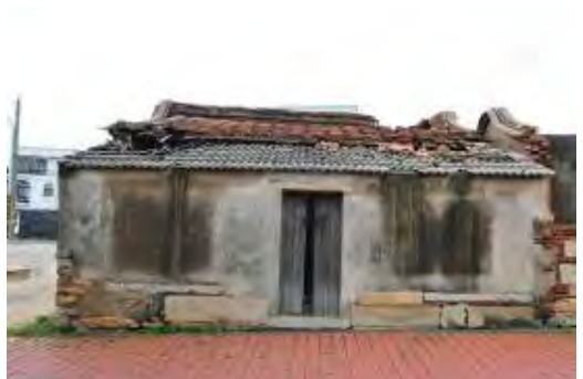
照片 5-1- 141 四維堂前落前庭不當增建
