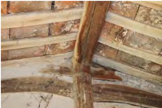
照片 5-2- 62 前落中脊材質尚可無明顯嚴重損壞
