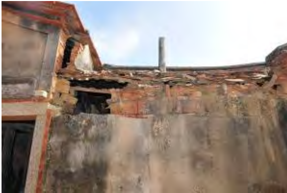
照片 5-3-31 右側擗頭外牆及屋面交接處坍塌損壞情況
