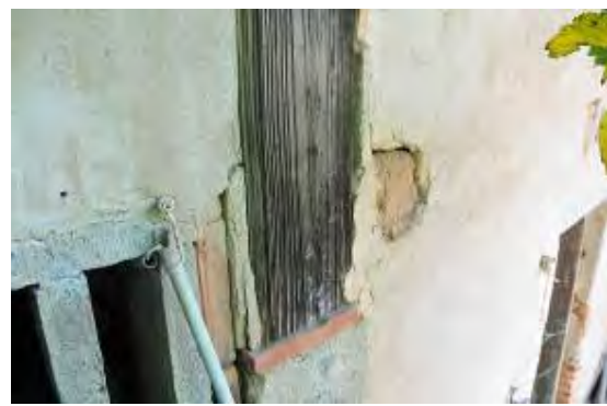
照片 5-6-20 木石接柱，木料表面風化腐朽
