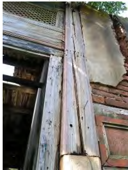
照片 5-1-277 正廳左門柱柱腳嚴重腐朽
