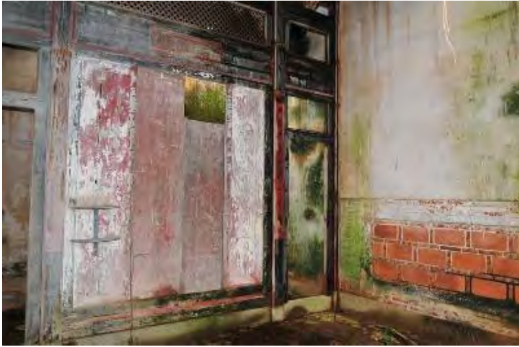
照片 5-1-240 正廳內因漏水造成壁體水漬與損壞
