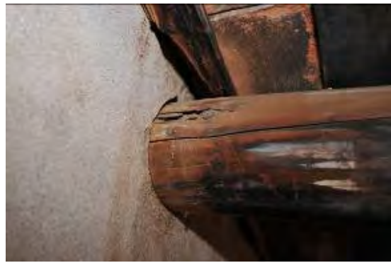
照片5-7-48 後一架右端與壁體接合處嚴重蛀蝕
