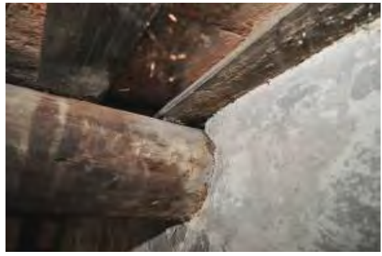
照片 5-2- 69 後一架左端上緣蟻路外露蛀蝕
