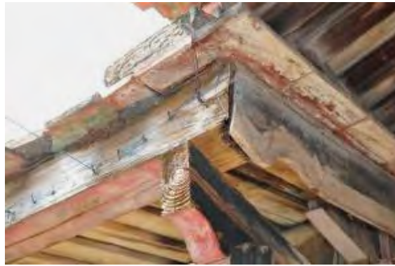
照片 5-1- 101 右擗頭挑檐樑端部嚴重腐朽
