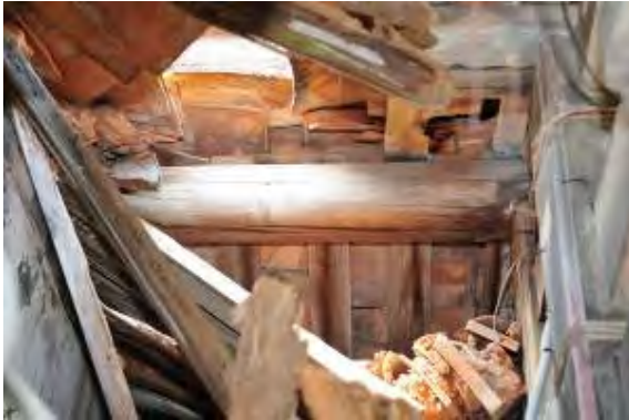
照片 5-1- 100 右擗頭與前落暗厝崩塌漏水中脊腐朽
