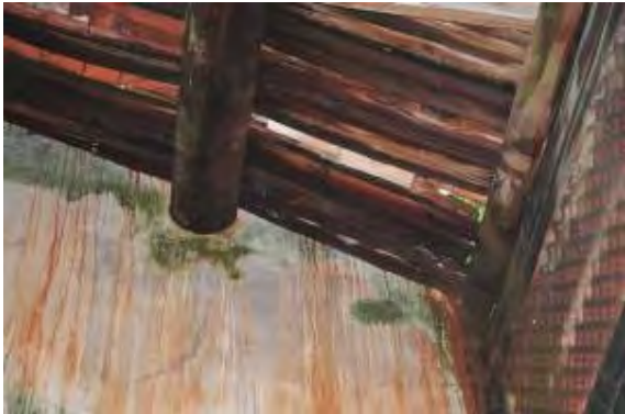
照片 5-1-274 後二架端部與上緣腐朽
