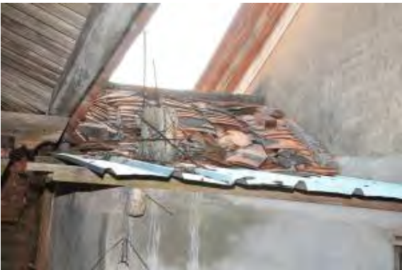
照片 5-1-80 左前過廊屋面破損漏水
