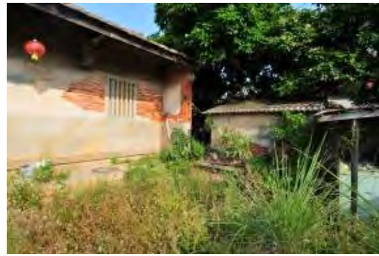
照片 5-1- 61 前埕長雜草，前落牆體壁面剝落
