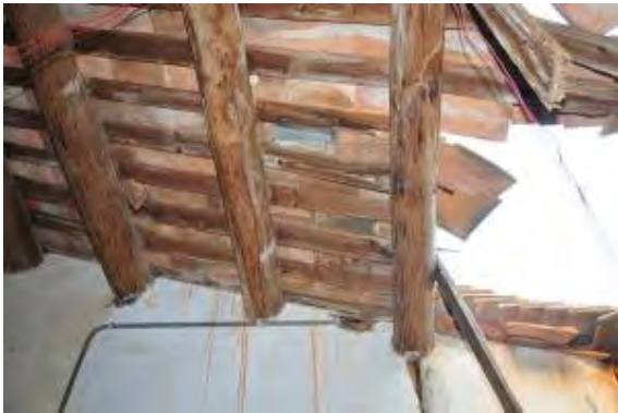
照片 5-3-177 前落右房前一架嚴重腐朽蛀蝕
