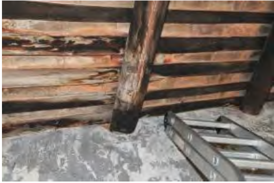
照片 5-2- 68 後二架上緣嚴重蛀蝕，右端前緣劈
