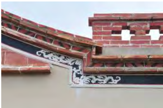
照片4-2- 221 前落與磚平接合部位有斜向裂縫
