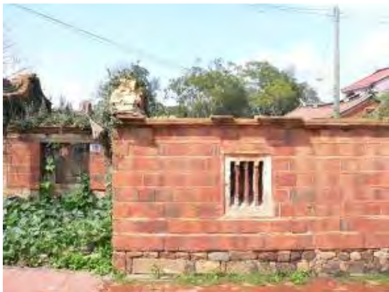
照片 5-3- 121 倉庫屋頂坍塌、外牆現況良好(一)
