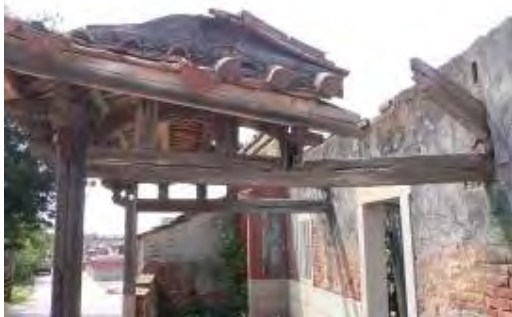
照片 5-1- 156 前庭軒屋頂破損、木架損毀
