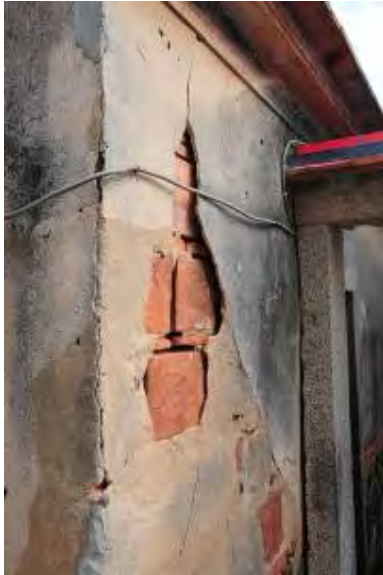
照片 5-3-91 前落壁體灰壁掉落
