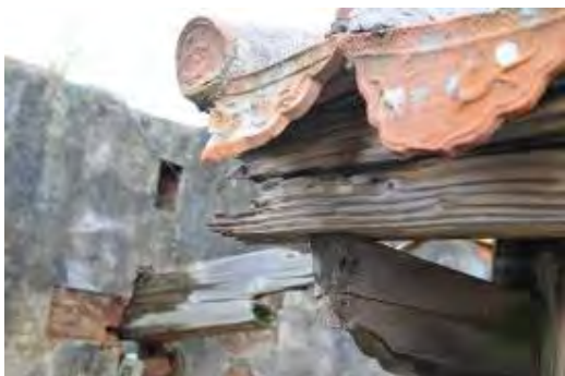
照片 5-1- 184 右側挑檐樑端部嚴重腐朽
