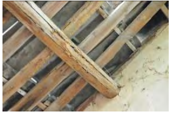
照片 5-6-40 後二架嚴重蛀蝕
