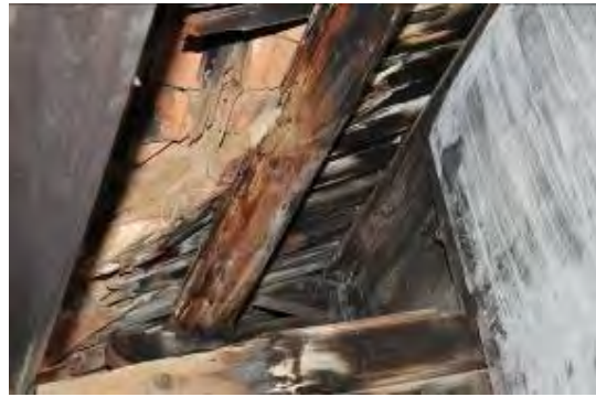
照片 5-3- 69 前落右房後三架嚴重腐朽、蛀蝕
