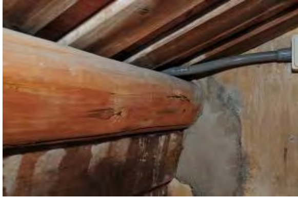
照片 4-2- 188 二樓右房前二架蛀蝕嚴重
