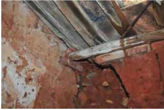
照片 5-5-19 前二架木料直徑過小，端部嚴重腐朽
