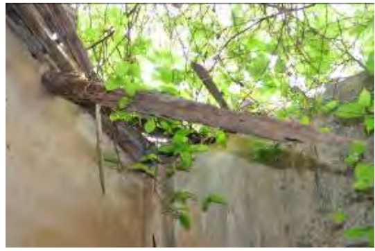
照片 5-6-42 前一架腐朽蛀蝕斷裂
