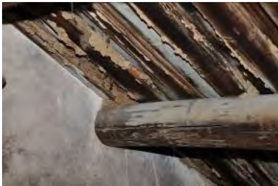
照片 5-3- 51 後二架右側有蟻巢，嚴重蛀蝕
