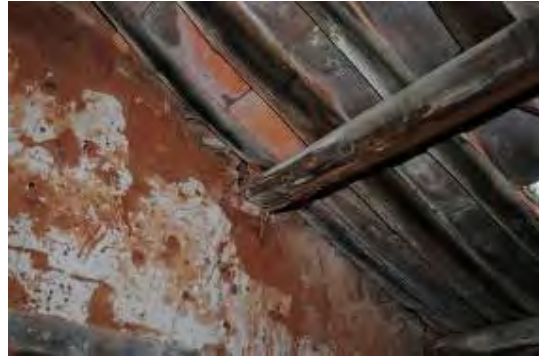
照片 5-5-20 前一架木料端部嚴重腐朽
