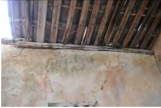
照片 5-6-39 梢筒嚴重腐朽蛀蝕
