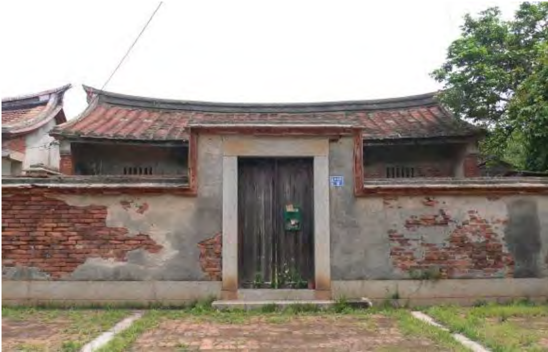
照片 5-1- 32 水頭 9 號正面入口外觀表面粉刷嚴重風化及磚體風化
