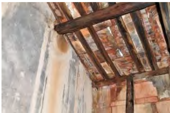
照片 5-1- 190 左後二架與後一架端部嚴重腐朽
