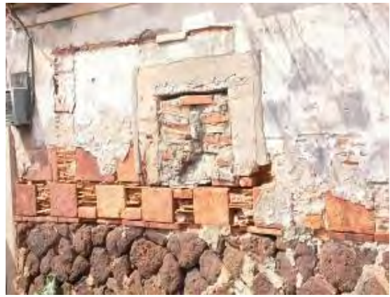
照片 5-3- 118 右側牆面修補、灰縫剝落
