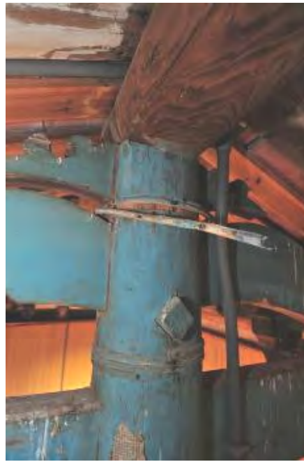
照片 4-2- 169 二樓左構架中柱柱頭輕微損壞
