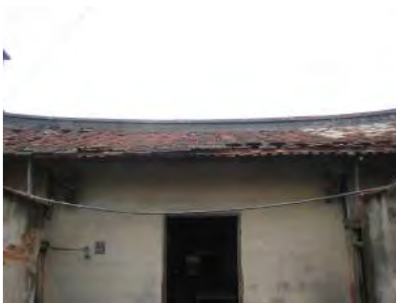
照片 5-1- 309 屋脊部分水泥剝落、屋面部分破損
