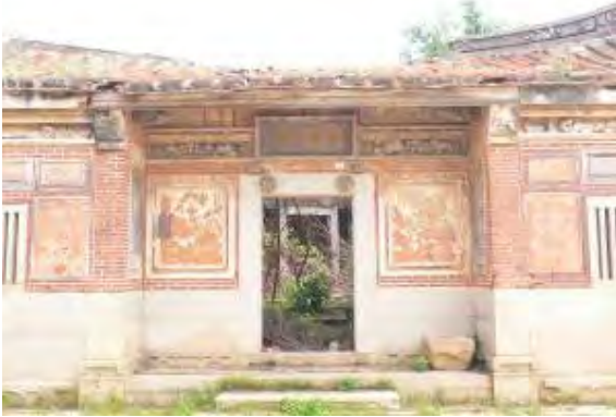
照片 5-1- 210 第一落屋面損壞塌陷
