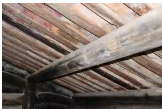
照片5-3-95 前一架全根表面多處劈裂
