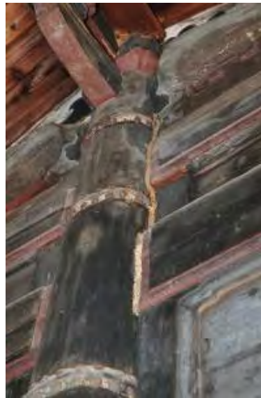
照片 5-3- 38 後落部分立柱白蟻蛀蝕嚴重
