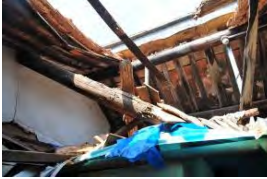
照片 5-4-51 右房屋面嚴重破損木料腐朽斷裂
