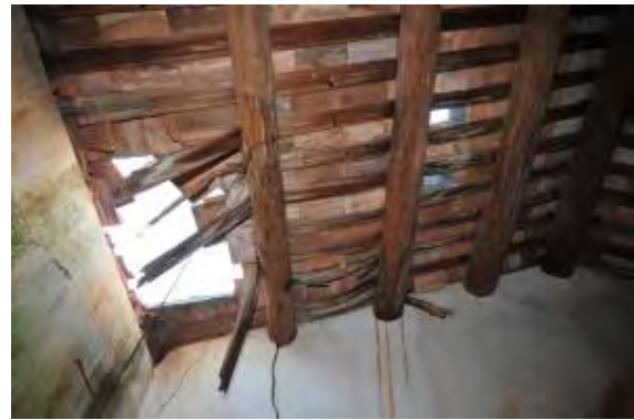
照片 5-3-178 前落左房後一、後三架嚴重腐朽蛀蝕
