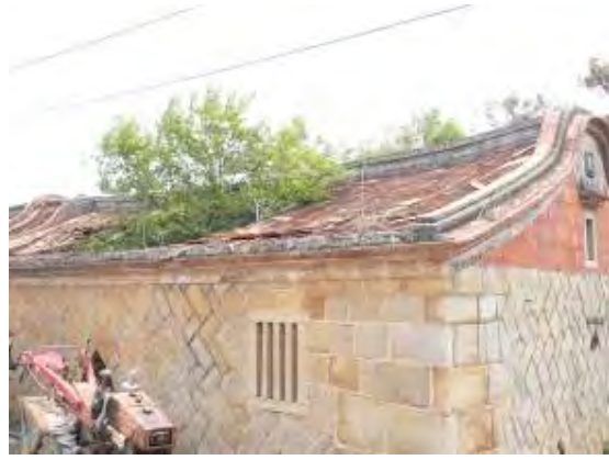
照片 5-2- 11 明間屋面坍塌，並有植物生長竄出
