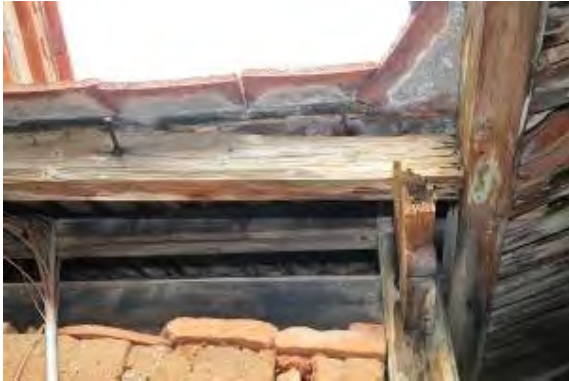
照片 5-1- 124 左後過廊挑檐嚴重腐朽
