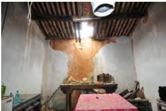
照片5-7- 56 正廳屋面破損漏水造成木構件腐朽
