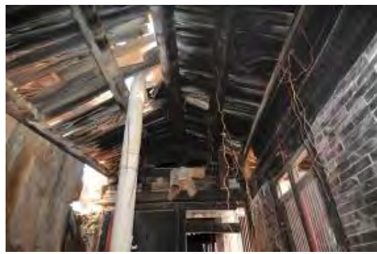
照片 5-3- 64 右擗頭後側損壞全景
