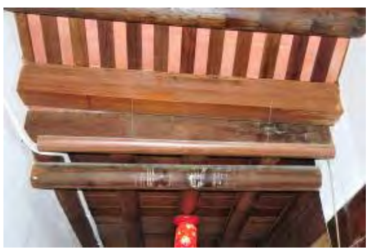
照片 4-2- 230 右磚平與前落接合之水槽曾滲水有水漬，目前已整修完成
