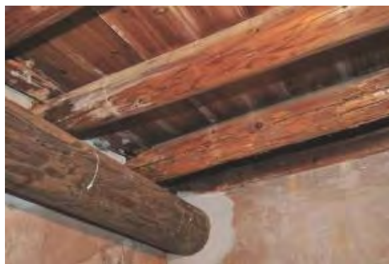
照片 4-2-149 左側端部嚴重蛀蝕
