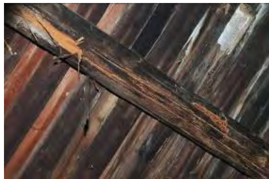
照片 5-3- 71 前落右房前二假嚴重蛀蝕
