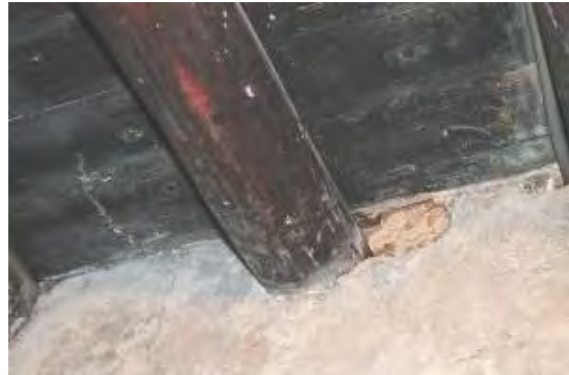
照片 4-2- 155 明間四架左半部下緣表面蛀蝕 1-3cm，內部亦有局部環狀蛀蝕
