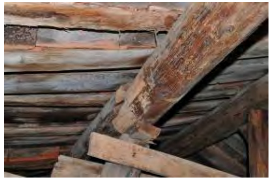
照片 5-5-24 前一架木料榫接處嚴重蛀蝕及脫榫
