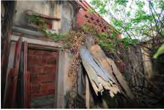
照片5-3- 161 後落正廳屋面破損漏水嚴重
