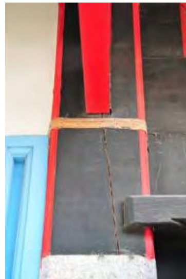
照片 4-2- 62 左柱中央有全根乾裂造成之裂隙
