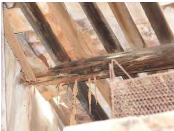
照片 5-1- 327 右後三架右端嚴重腐朽損壞斷裂
