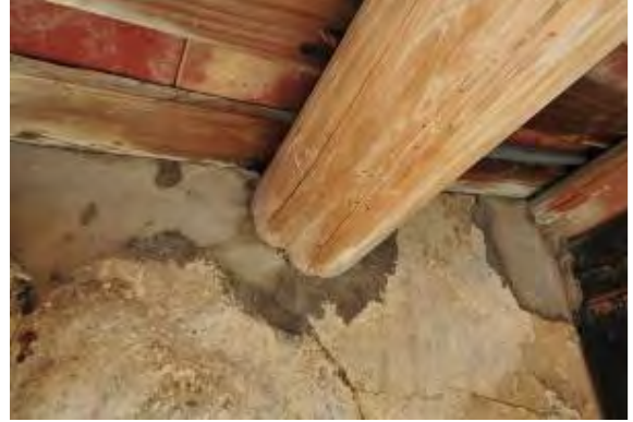
照片 4-2- 189 二樓右房前三架蛀蝕但不嚴重
