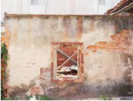
照片 5-1-311 右上舉屋面坍塌及窗戶損壞
