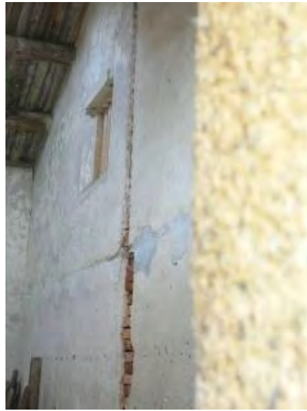
照片 5-1- 45 後落右房右側內牆產生裂縫
