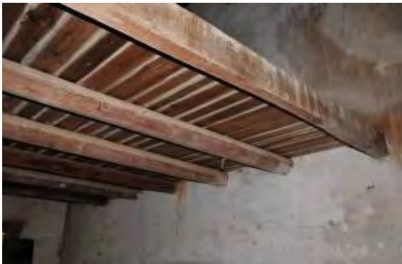
照片 5-1-282 右次間夾層木樑端部輕微腐朽
