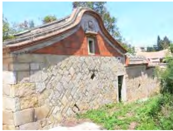
照片 5-2- 21 右側牆面有兩處砌石佚失
