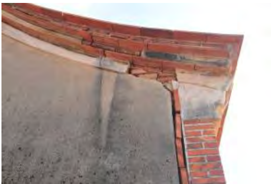
照片 5-3-27 大規避與立面交接處損壞有嚴重龜裂
