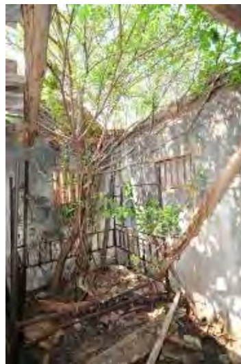
照片 5-4-22 右擗頭屋面崩塌毀損
