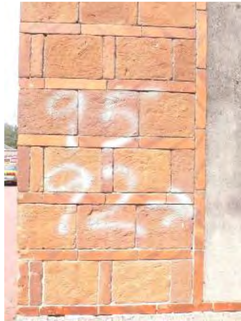
照片 5-3-16 背牆有噴漆在磚面上
