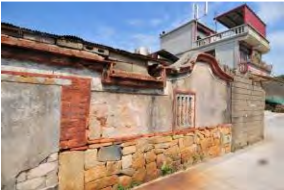
照片 5-4-41 原正面入口已經封閉破損嚴重
