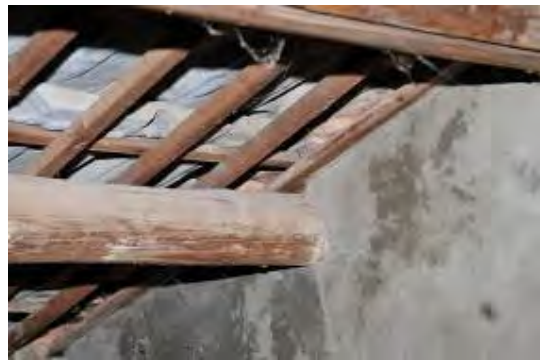
5-3- 111 左房後二架左端上方腐朽
