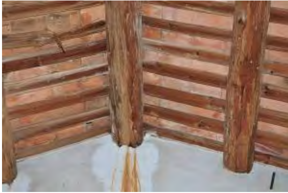
照片 5-3- 171 後落右房中脊白蟻蛀蝕腐朽嚴重
