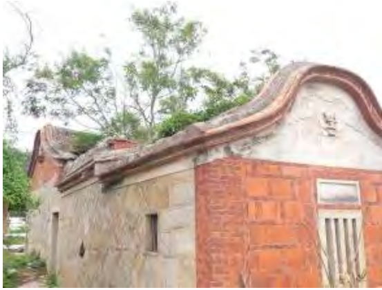
照片 5-2- 10 右側房內植物生長並竄出屋面
