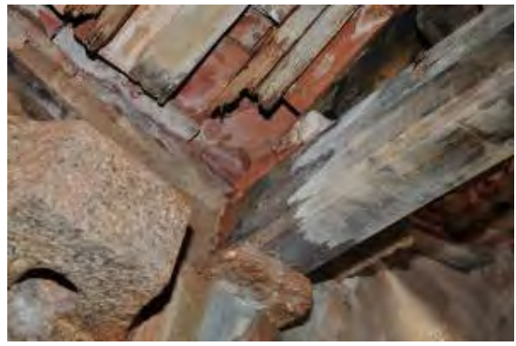
照片 5-1- 125 左後過廊右大通局部腐朽其餘尚可
