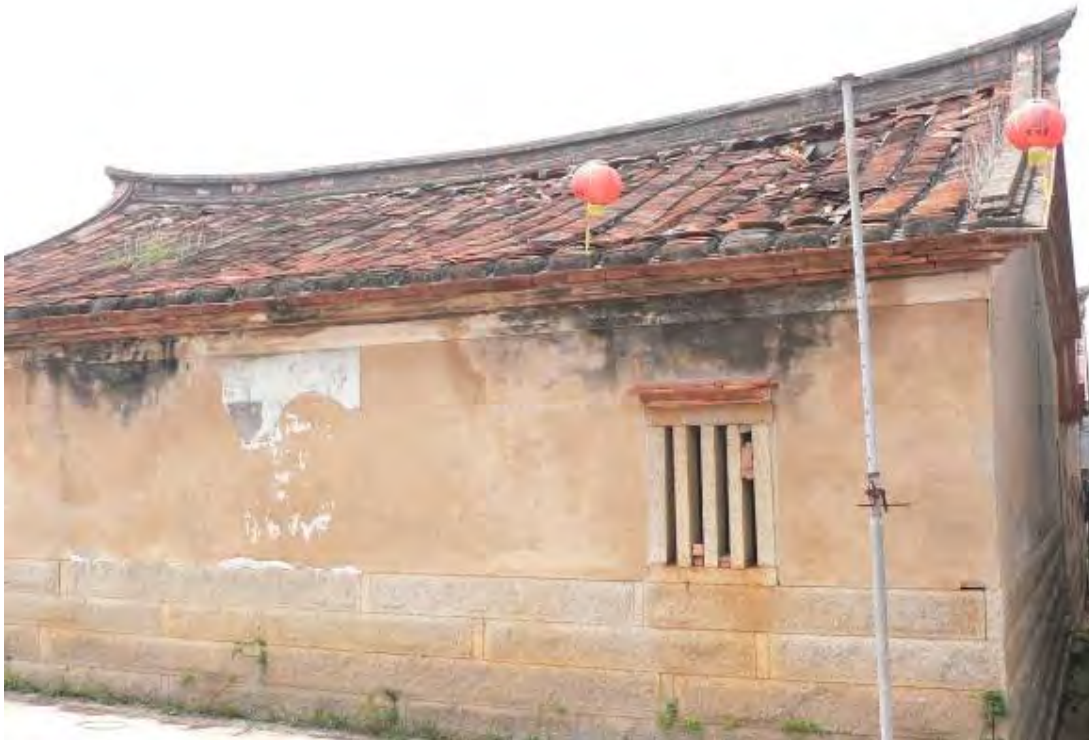
照片5-1-37 水頭9號背牆有水漬及屋面破損
