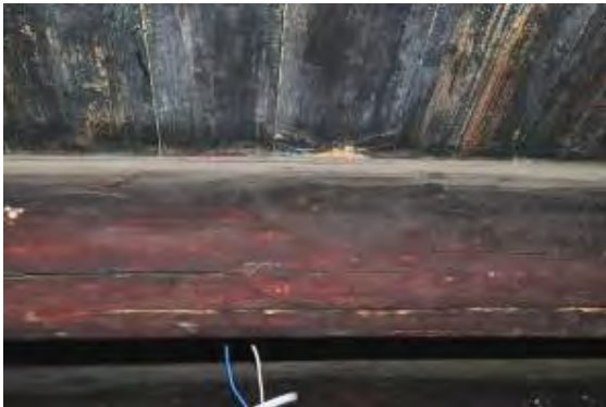
照片 4-2- 156 明間四架下緣表面蛀蝕深 1-3cm
