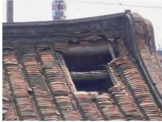
照片 5-4-14 右房屋面破損嚴重
