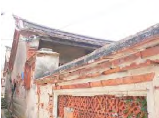
照片5-1- 33 外牆部分灰縫需重填
