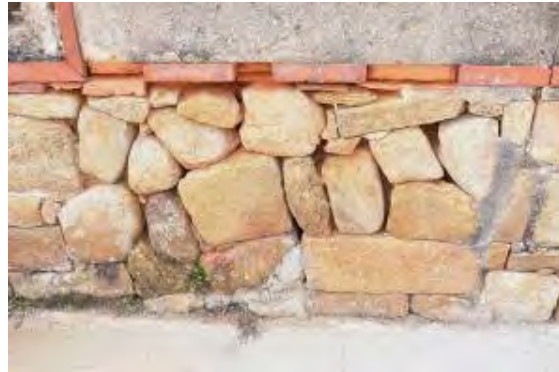
照片 5-4-42 牆基亂石砌灰縫均已崩落
