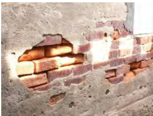
照片5-1-40 壁體外部粉刷層及砌磚損壞風化
