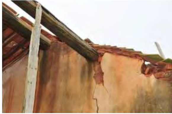
照片 5-1- 205 左間前一架嚴重腐朽
