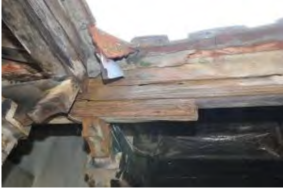
照片 5-1- 82 前落後挑檐左端嚴重腐朽
