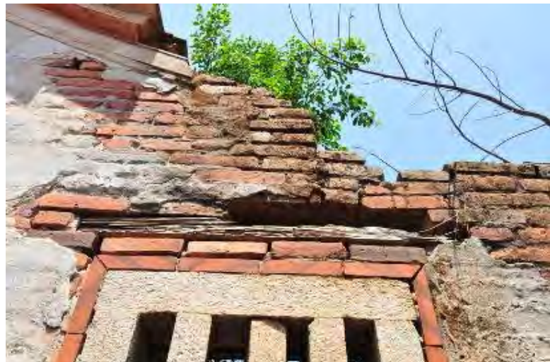
照片 5-1- 239 擗頭磚平屋面崩塌後壁體上方損壞
