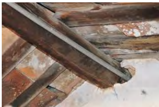
照片5-4-47 中脊左側與壁體接合處有腐朽損壞
