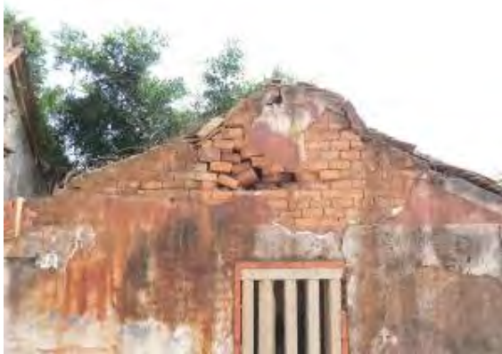
照片 5-1- 218 右護龍馬背損壞坍塌
