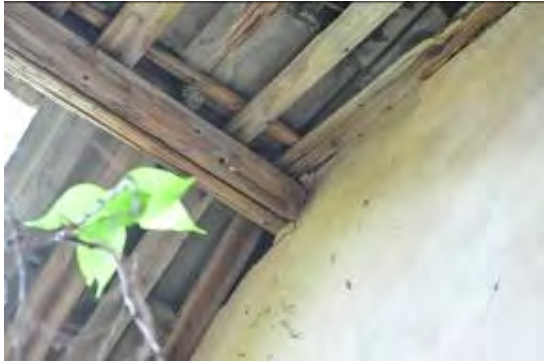
照片 5-6-41 中脊嚴重腐朽蛀蝕
