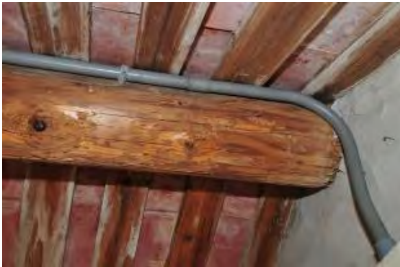
照片 4-2- 186 二樓右房中脊蛀蝕嚴重
