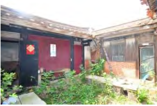
照片5-1-64 天井雜草叢生
