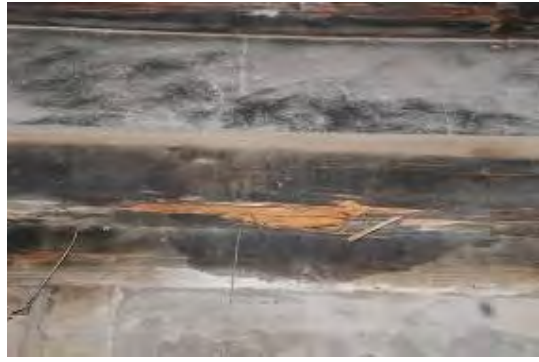
照片 5-3-98 左大通全根內部蛀蝕
