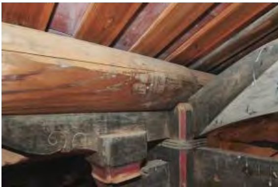
照片 4-2- 174 二樓正廳後一架全根下緣劈裂
