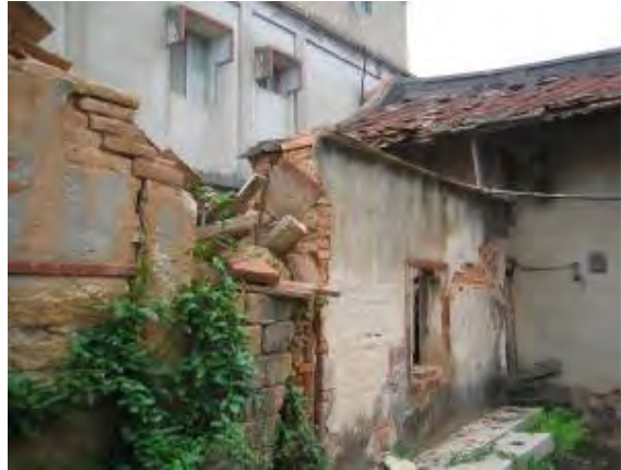
照片 5-1-288 左側護龍牆體及屋面坍塌
