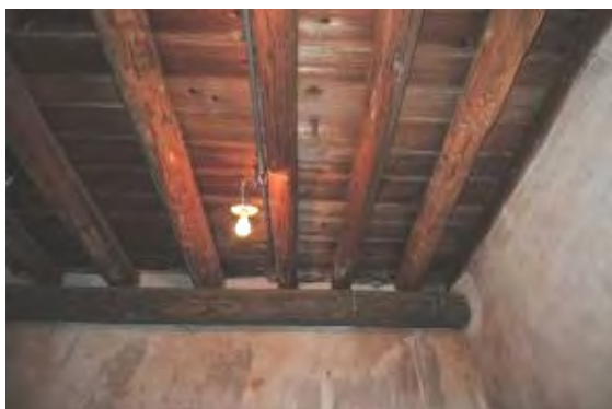
照片 4-2-148 一樓左房之二樓木樑均有嚴重蛀蝕
