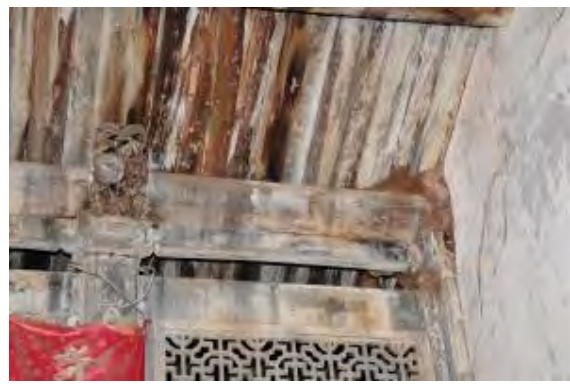
照片 5-1- 105 後落正廳後三架左側蟻巢生長
