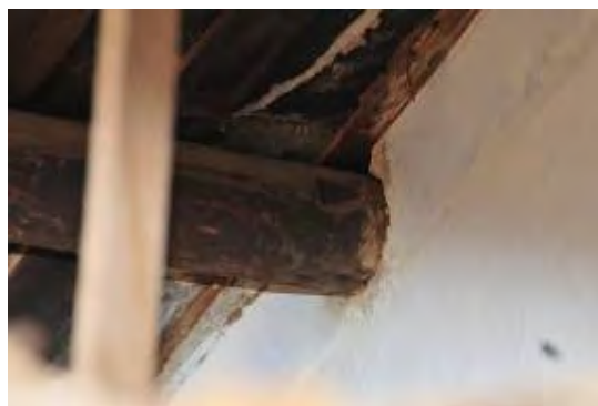
照片 5-4- 48 後一架與壁體交接觸腐朽蛀蝕
