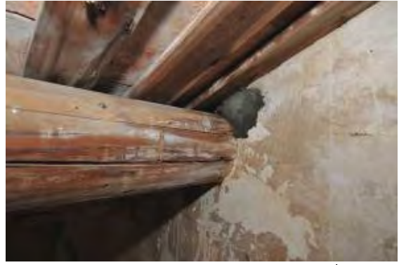
照片 4-2- 163 二樓左房後一架與壁體接合處嚴重腐朽
