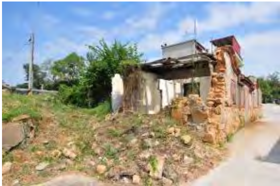
照片 5-4-39 右擡頭與右房壁體屋面崩塌
