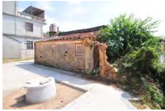
照片 5-4-36 建物右側外牆倒塌（二）
