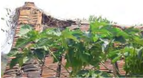
照片 5-1- 252 左側屋脊坍塌
