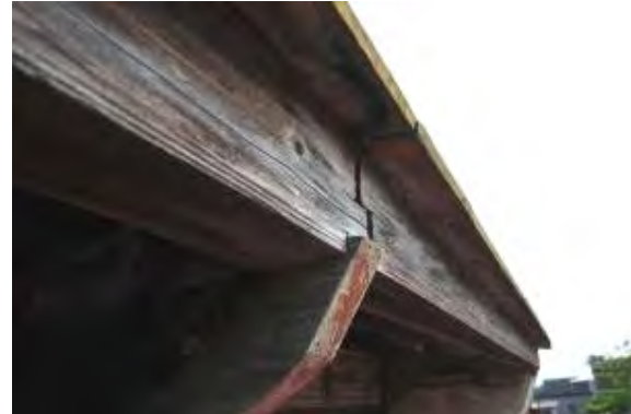
照片 4-2- 177 二樓正廳前四架挑檐局部蛀蝕
