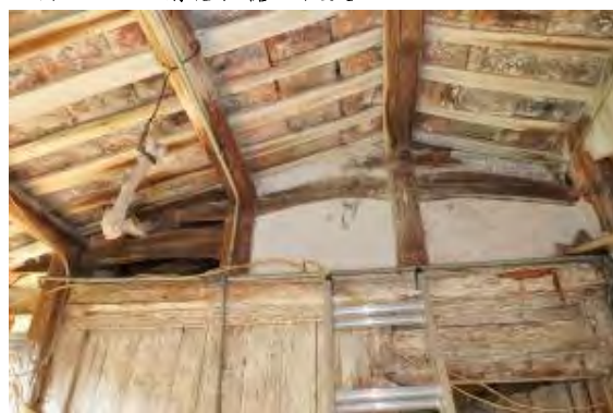
照片 5-2- 65 前落瓜柱無明顯嚴重損壞
