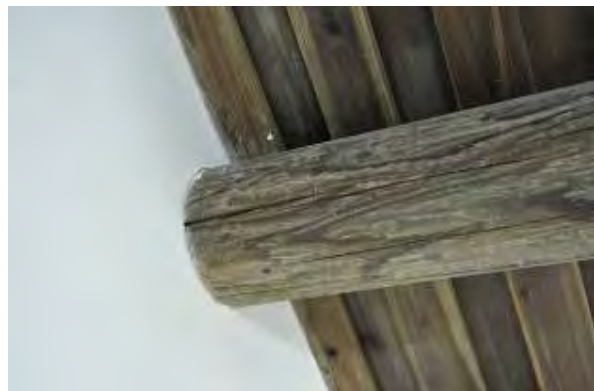
照片 4-2- 82 左前一架下緣多處裂隙
