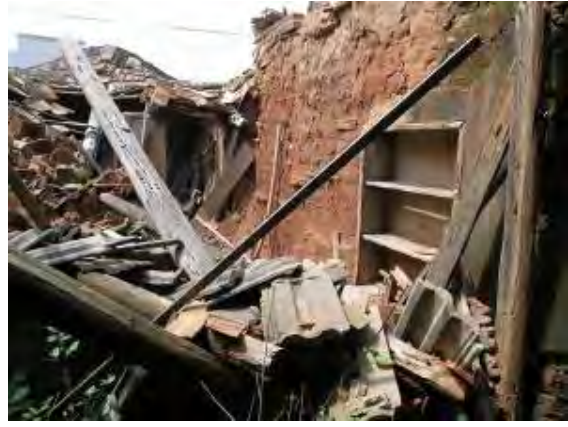
照片 5-1-338 左前二架有腐朽現象
