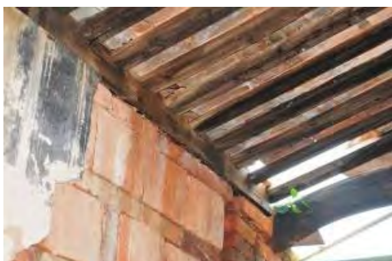
照片 5-1- 192 明間後二架（桷筒）嚴重腐朽
