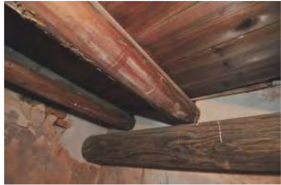
照片 4-2- 153 構件全根均有蛀蝕
