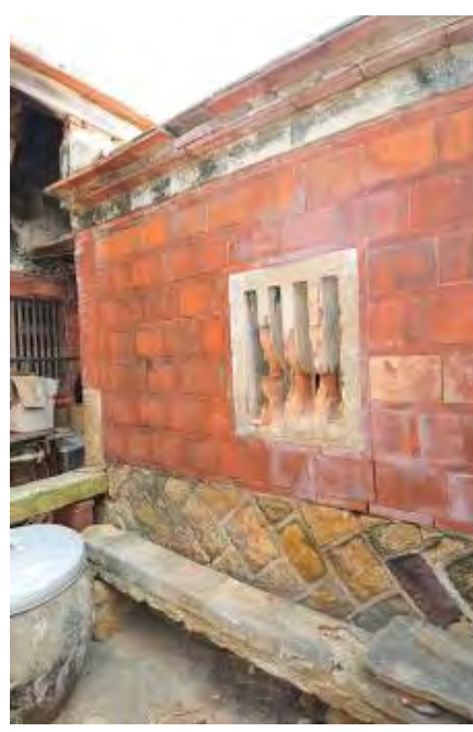
照片 5-4-18 左擗頭磚體風化損壞
