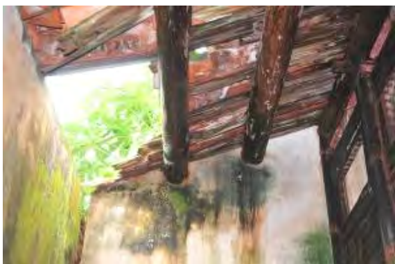
照片 5-1-270 右中脊端部輕微腐朽下緣劈裂
