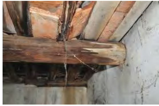
照片 5-6-18 後一架因漏水上緣嚴重腐朽
