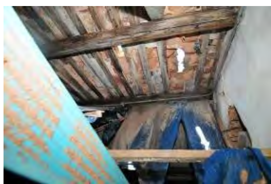
照片 5-4- 50 木料嚴重腐朽蛀蝕
