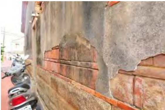
照片 5-3-35 外側壁面分刷層剝落損壞
