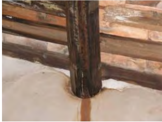
照片 5-1- 332 右前二架左端腐朽損壞
