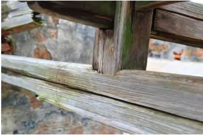
照片 5-1- 166 D-1-4 瓜柱柱腳有輕微腐朽
