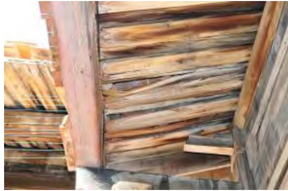
照片 5-1- 99 左擗頭挑檐桷仔嚴重腐朽
