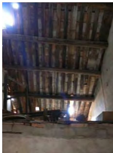
照片 5-1- 310 右房屋瓦破損，閣樓堆積雜物
