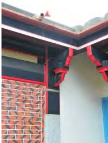
照片 4-2- 71 左前外柱表面輕微裂隙
