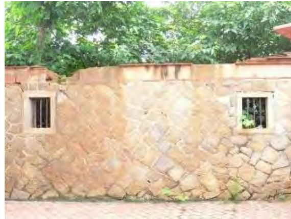
照片 5-7- 52 牆體上原局部損壞
