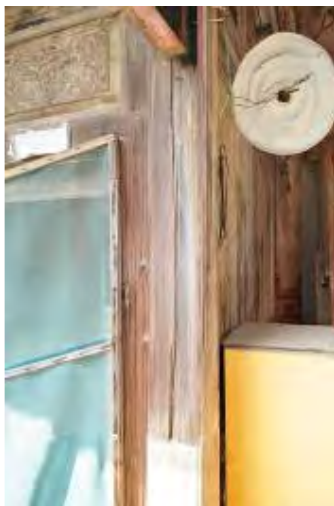
照片 5-1- 102 右擗頭後柱表面劈裂風化
