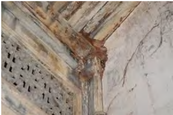
照片 5-1- 112 左後柱柱頭蟻巢外露，柱頭蛀蝕嚴重
