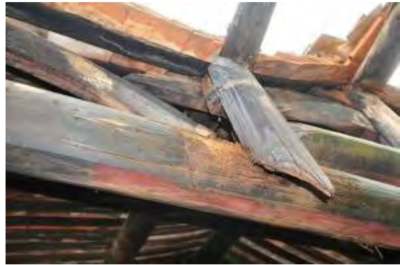
照片 5-1- 199 右次間中脊左側端部嚴重腐朽
