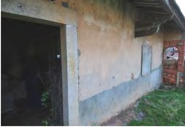
照片 5-1-18 鏡面牆曾以水泥沙漿修補
