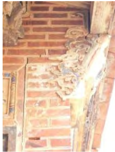
照片 5-1- 211 門廊左側壁面剪力破壞
