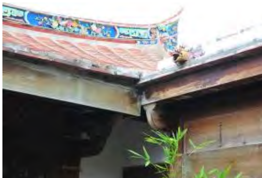
照片 4-2- 232 前落與右磚平接合部位滲水
