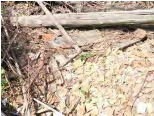
照片 5-1- 160 內部地坪瓦片掉落堆積
