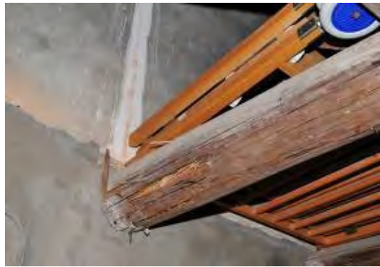
照片 5-4-20 左房夾層構造亦已嚴重蛀蝕
