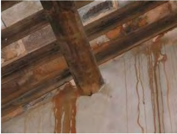
照片 5-1- 331 右前一架右端嚴重腐朽損壞
