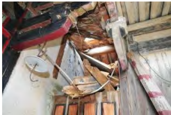
照片 5-1- 103 右擗頭與前落間暗厝嚴重毀損
