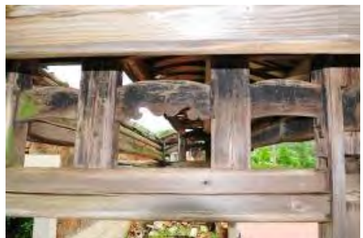
照片 5-1- 185 左右構架彎束等構件輕微腐朽
