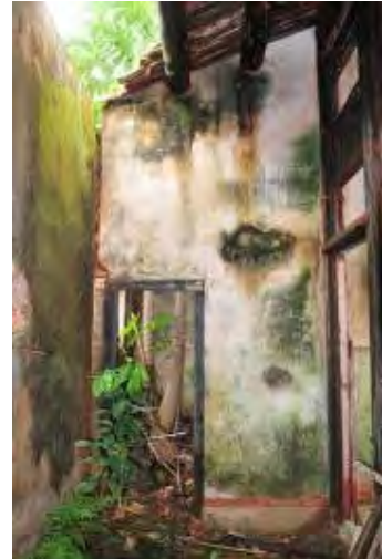
照片 5-1-241 後落壽堂後壁體與屋頂損壞
