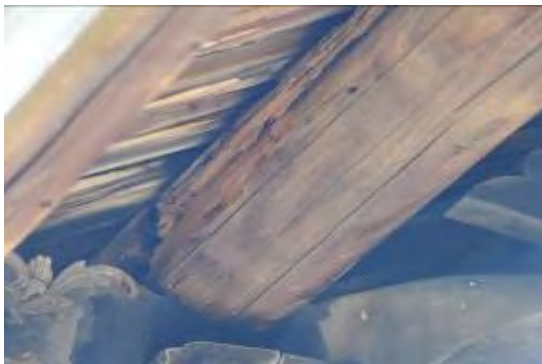
照片 5-3- 45 前四架右側端部嚴重腐朽蛀蝕
