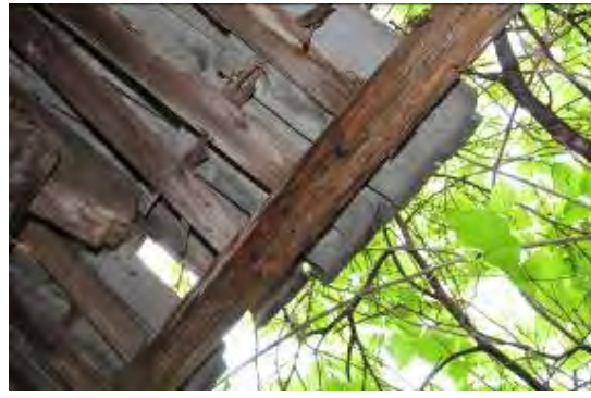
照片 5-6-38 挑簷樑嚴重腐朽蛀蝕
