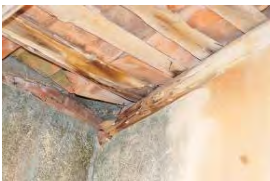
照片 5-3- 102 左次間前二架嚴重腐朽
