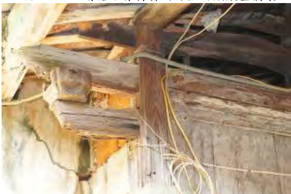
照片 5-2- 64 前落立柱除表面風化外，無明顯破壞
