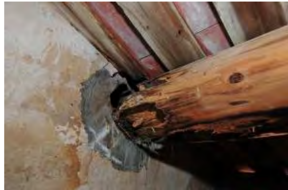
照片 4-2- 165 二樓左房前一架端部嚴重腐朽
