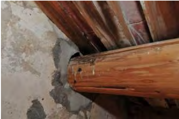
照片 4-2- 184 二樓右房後二架蛀蝕嚴重
