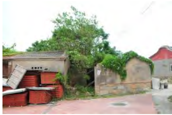
照片 5-6-26 建物背牆外觀，植物四處竄升
