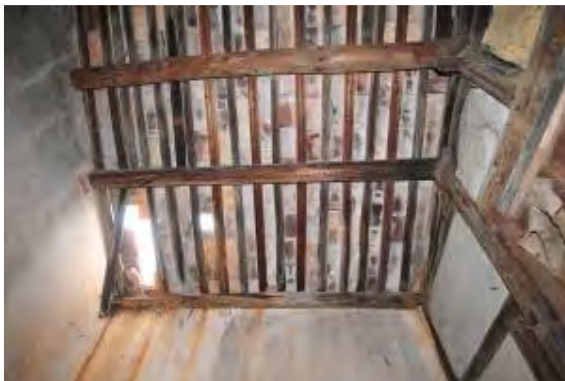
照片 5-3- 135 右房後側屋面破損漏水木構件腐朽
