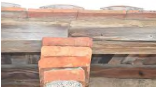
照片 5-3- 100 前落右次間前三架端部嚴重腐朽
