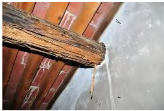
照片 5-4- 30 左房後一架右端腐朽蛀蝕
