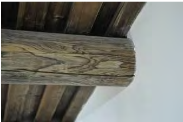
照片 4-2- 79 左後二架下緣全根劈裂
