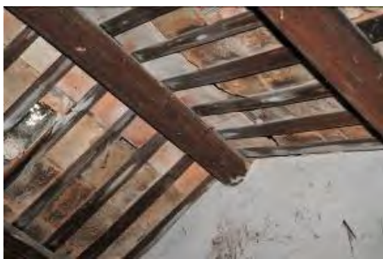
照片5-7- 65 左房中脊端部與牆體接合處腐朽
