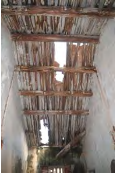
照片 5-1-78 後落右房屋頂崩塌
