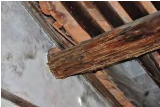
照片5-4-23 正廳後二架右端嚴重腐朽
