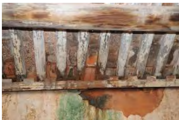
照片 5-1-24 明間後二桷筒腐朽
