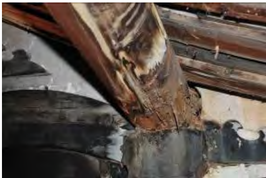
照片 5-3- 53 前一架左側端部嚴重腐朽蛀蝕
