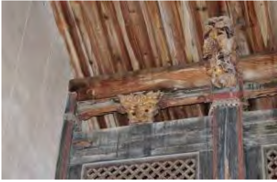
照片 5-1-272 右中脊端部輕微腐朽下緣劈裂
