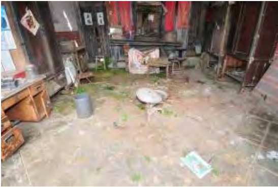
照片5-1-66 後落地坪表面龜裂損壞
