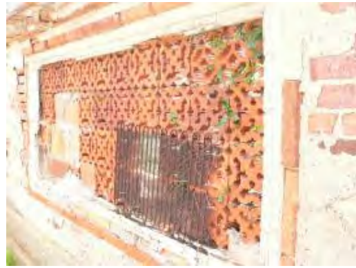
照片 5-1- 34 前埕外牆裝飾花磚部分損壞
