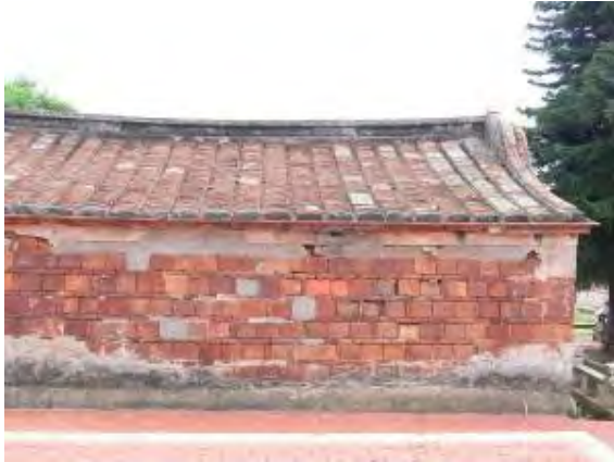
照片 5-7-13 後落後寮牆牆體灰壁崩落
