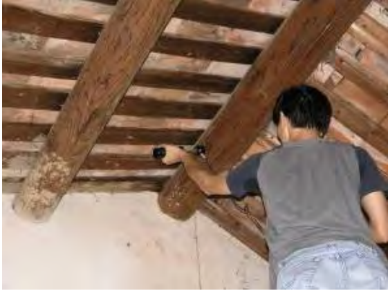
照片 5-1-264 右中脊端部輕微腐朽下緣劈裂
