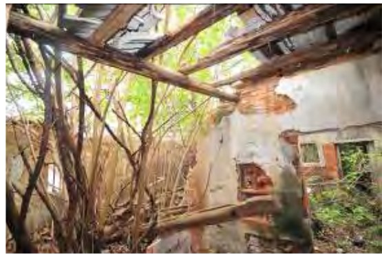
照片 5-7- 68 右前擡頭坍塌
