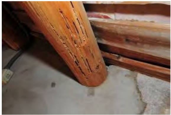
照片 4-2- 185 二樓右房後一架蛀蝕嚴重
