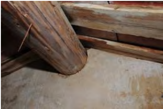
照片 4-2- 164 二樓左房中脊左端與壁體接合處腐朽與蛀蝕嚴重
