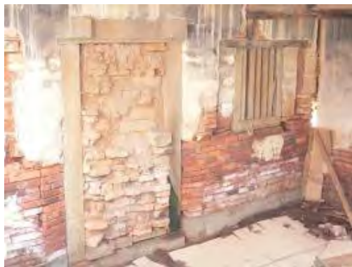
照片 5-1- 162 正門口被石砌封閉
