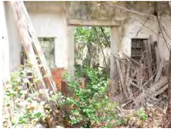
照片 5-2- 19 後廳內部堆置坍塌物及草木生長
