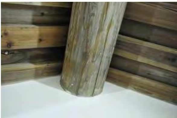
照片 4-2- 81 左中脊下緣多處裂隙
