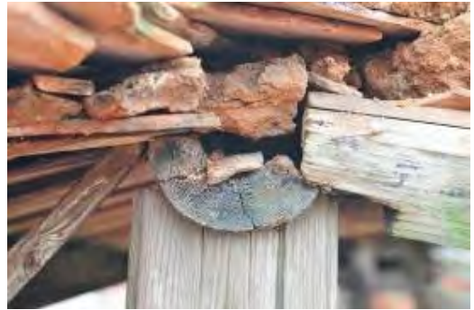
照片 5-1- 181 前二架左端部嚴重腐朽損壞
