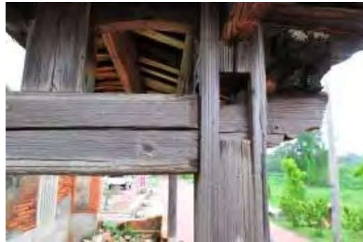
照片 5-1- 173 右大通前端輕微腐朽與風化
