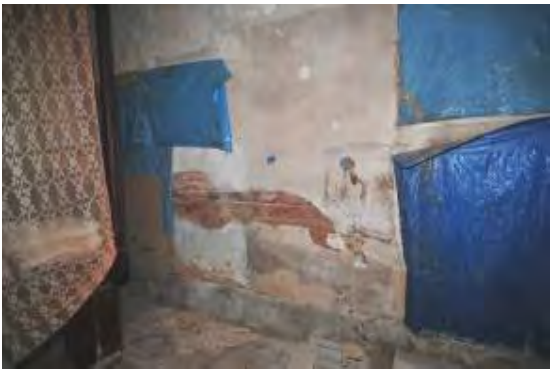
照片5-1-62 前落右房內側壁面崩落
