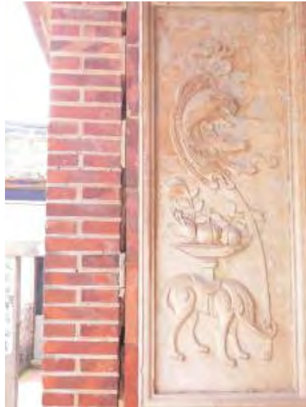
照片 5-3-10 右上房左側牆面灰縫剝落
