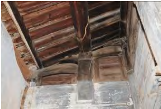
照片 5-3- 41 後四架下緣表面劈裂有明顯蟻道
