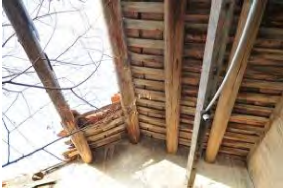
照片 5-2-24 後落正廳屋頂崩塌
