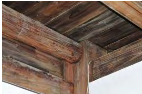
照片 4-2- 68 左擡頭左四架下緣全根劈裂
