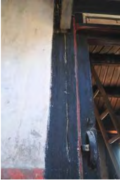
照片 5-1- 88 前落左後柱中央全根劈裂材質良好
