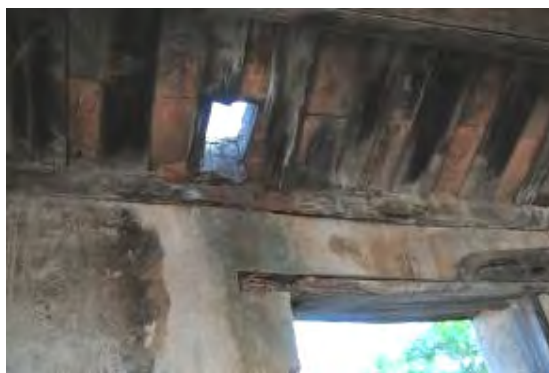
照片 5-2-35 前三柁筒嚴重腐朽
