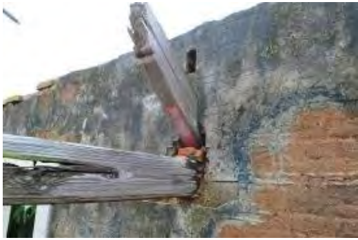
照片 5-1- 172 左大通後側埋入牆端嚴重腐朽
