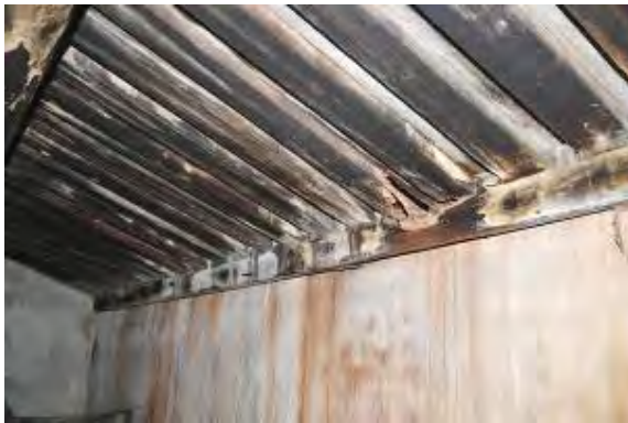
照片 5-1- 104 後落正廳後側楠筒嚴重腐朽損壞
