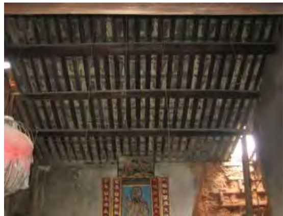
照片 5-1-290 屋內左次間後坡屋面坍塌
