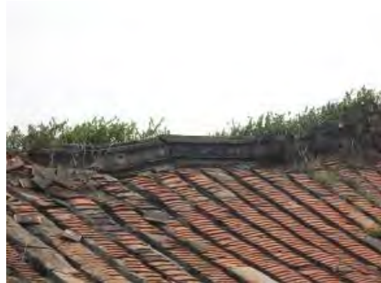
照片 5-1- 253 右側屋脊下陷斷裂
