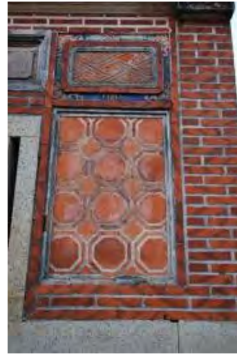
照片 5-1- 237 前落壁體有裂縫
