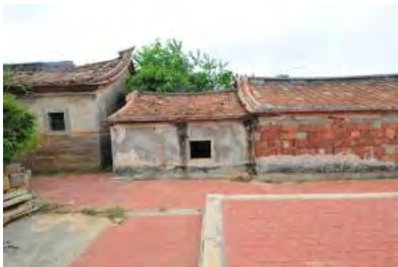
照片 5-7-17 左凸規屋頂破損牆面損壞
