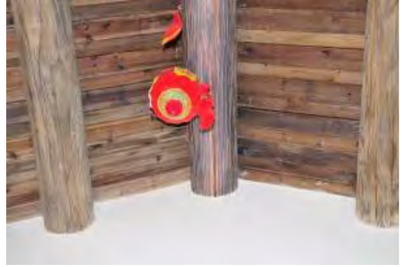
照片 4-2-191 前落中脊下緣全根乾裂
