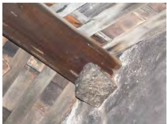
照片 5-1-320 中脊右端與牆體接合部位腐朽
