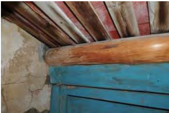
照片 4-2- 166 二樓左房前二架無明顯損壞
