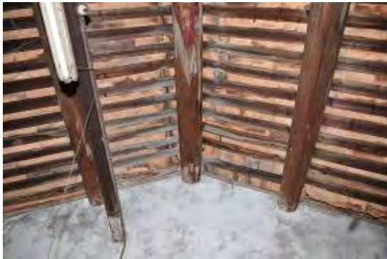
照片 5-4-25 正廳中脊與前一損壞現況
