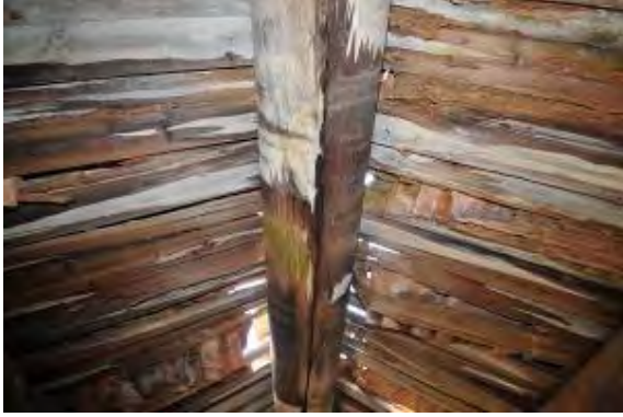
照片 5-1- 108 正廳中脊下緣劈裂材質尚可
