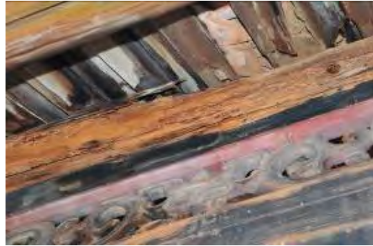
照片 5-3- 67 後二架中央嚴重腐朽、蛀蝕
