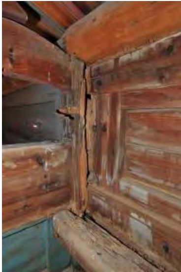
照片 4-2- 178 二樓右構架前柱柱頭嚴重蛀蝕
