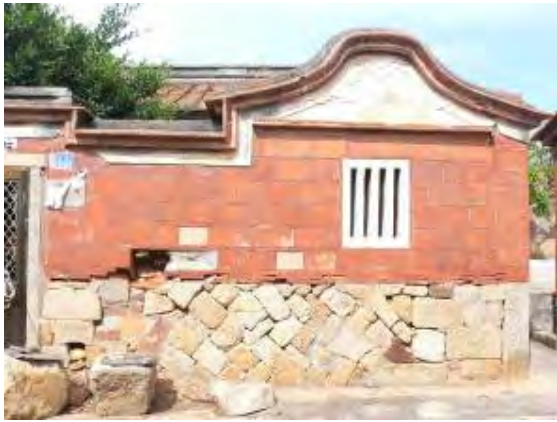
照片 5-4-15 左擗頭外牆磚面破損、灰縫剝落
