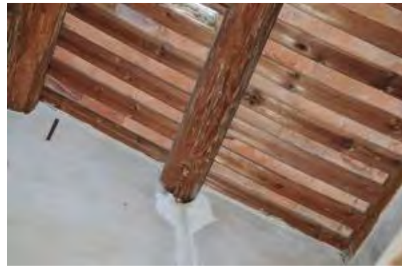
照片 5-3- 172 後落右房中脊白蟻蛀蝕腐朽嚴重
