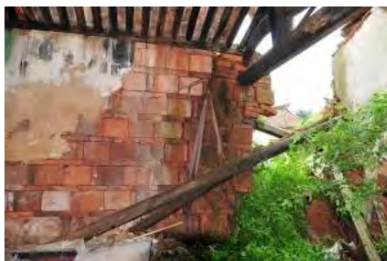
照片 5-1- 195 右次間後二架（桷筒）掉落損壞
