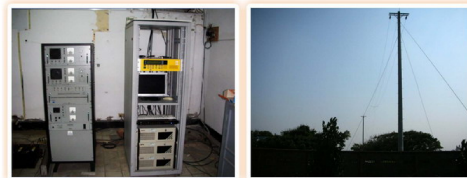
圖4-10 無線電標桿電臺機房儀器設備及NDB-T型無線電發射主天線
