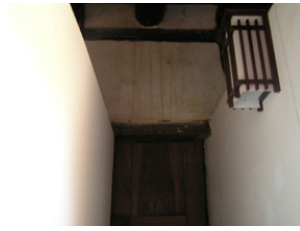
屋頂漏水狀況
