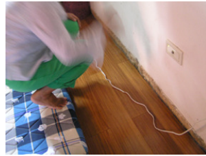
後落雅房地板滲水
