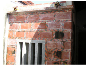
後落廁所外牆壁面毀損
