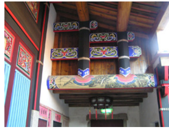
建築樑柱斗拱彩繪狀況
