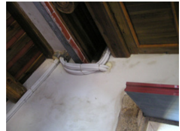
冷氣管線凌亂 1
