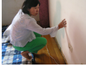
後落客房牆壁粉塵掉落
