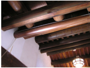
前落套房屋頂漏水臨時處理設施
