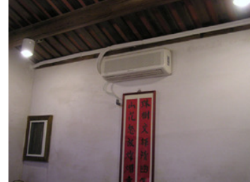
冷氣管線凌亂 2
