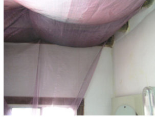
後落廁所屋頂漏水
