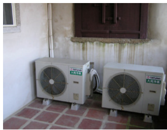
二樓陽台冷氣設備
