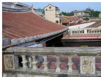
屋頂曬物平台被封死
