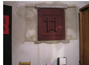
木窗旁牆壁漏水狀態
