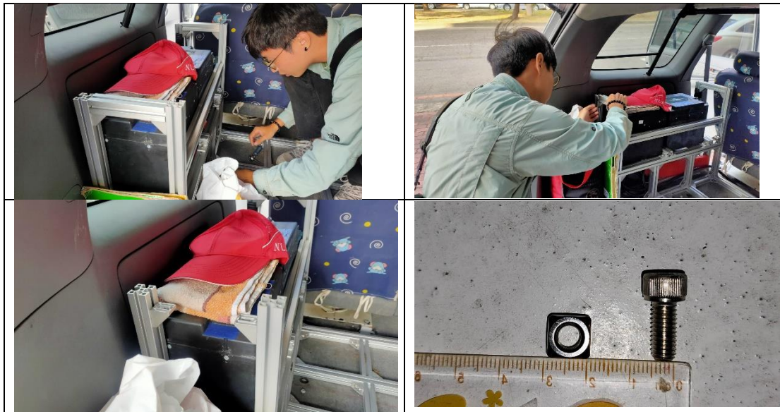
圖3-5 電池架螺絲檢修情況
