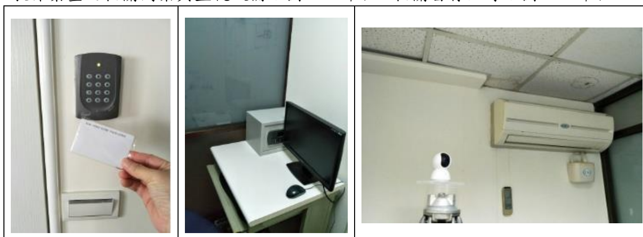
圖 3-3、機敏作業室之相關門禁與監視設備及監視器影像存檔紀錄
