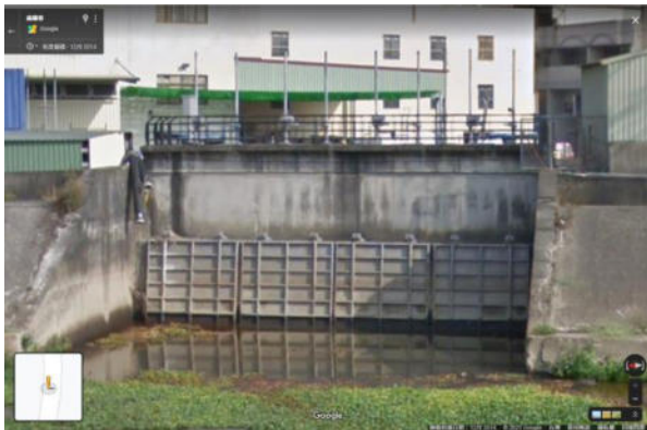
(a)中大型閘門
