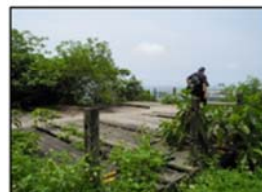
腐朽的瞭望台
