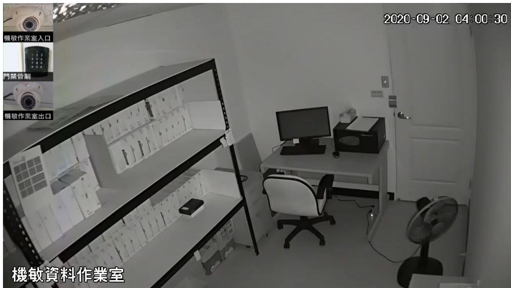
圖 1-2、機敏資料作業室門禁管制和監視器設備
