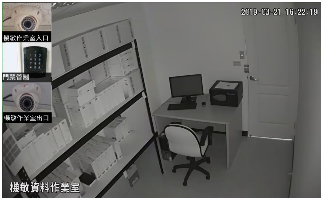
圖 1-2、機敏資料作業室門禁管制和監視器設備
