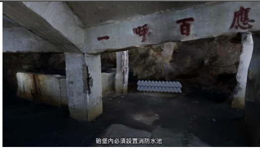
砲室內必須設置消防水池
