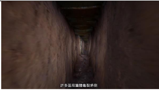
許多區段牆體龜裂坍塌
