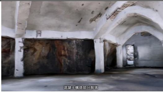
混凝土構造部分脫落
