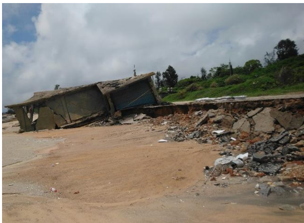
(a) 建築地基掏空倒塌
