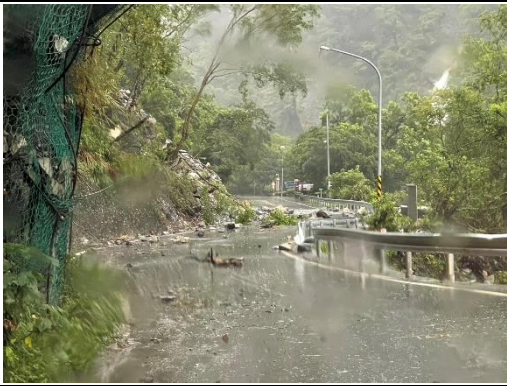
1.綠水步道合流端崩壁落石(工務段提供)
