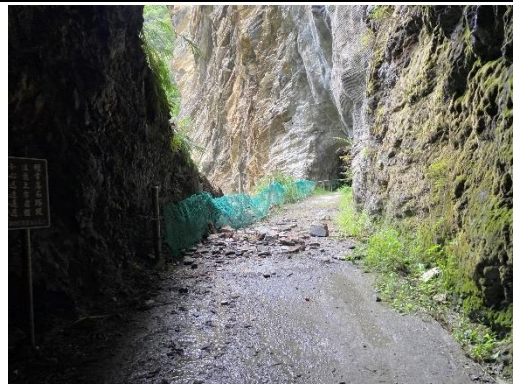
8.白楊步道第二隧道出口落石
