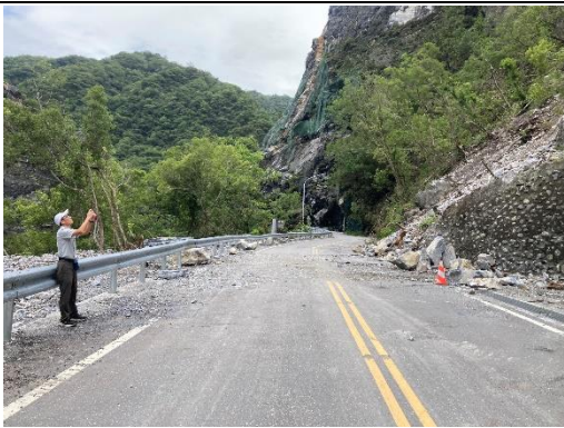
3.工務段已清除合流端落石恢復道路通行
