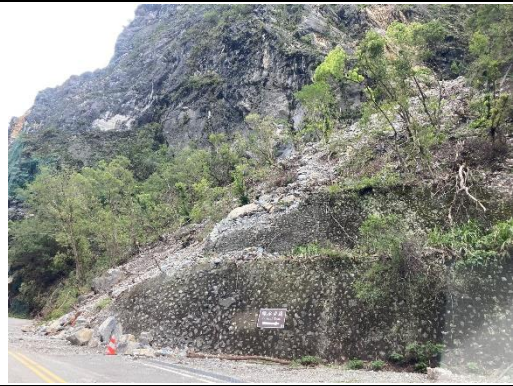
2.綠水步道 0.7-0.8K 坍方處颱風後現況
