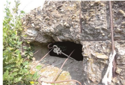
觀測所Rc結構風化嚴重
