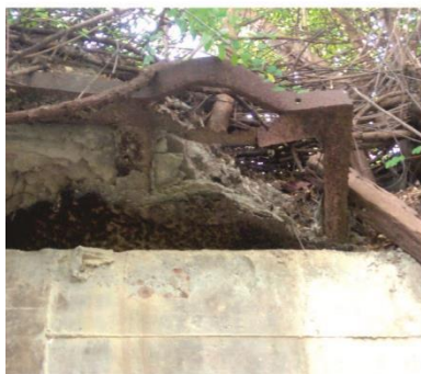
固定水管的鐵鈎
