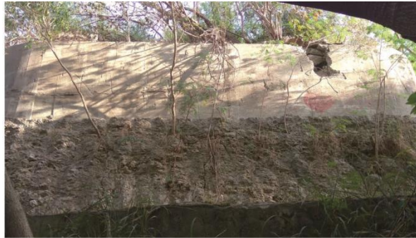
戰備水池RC版築痕跡與外露鋼筋
