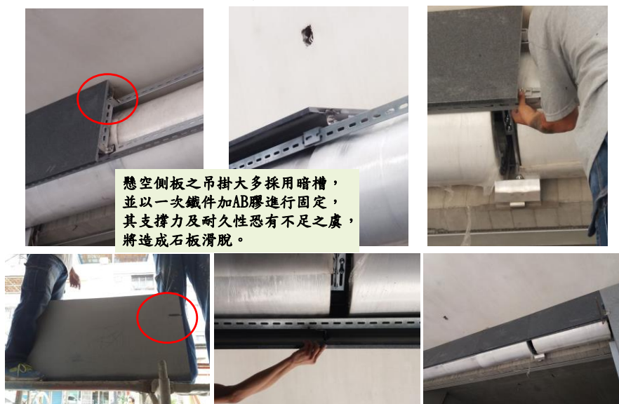
圖 3-16 B3 案吊掛懸空側板照片
