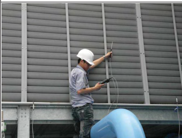
【冷卻水塔入風風速量測】
