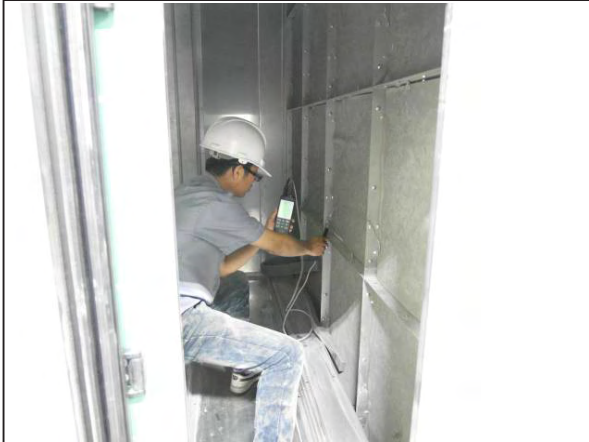
【空調箱盤管入風風速量測】
