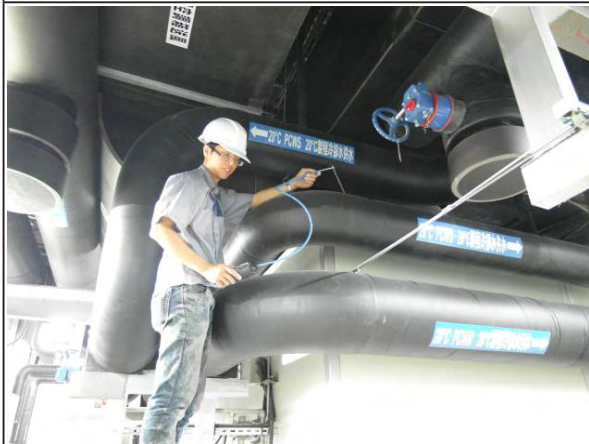
【空調箱出風風管靜壓量測】
