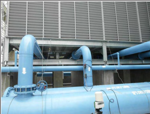
【冷卻水塔出水端溫度計安裝】
