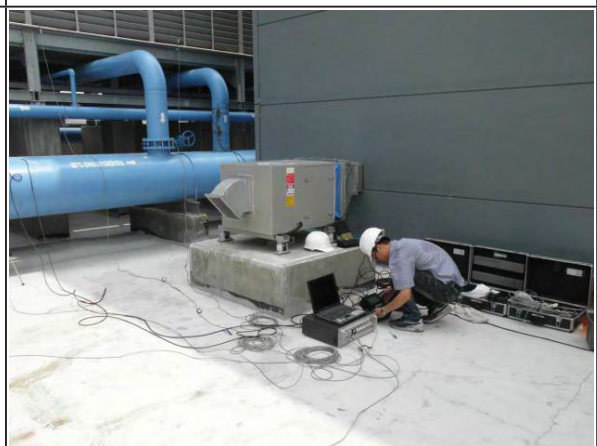
【冷卻水塔測試分析儀安裝】
