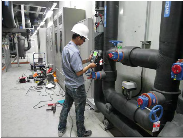
【空調箱出入端溫度計量測】
