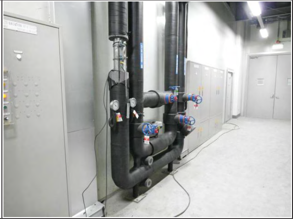
【空調箱超音波流量計安裝】
