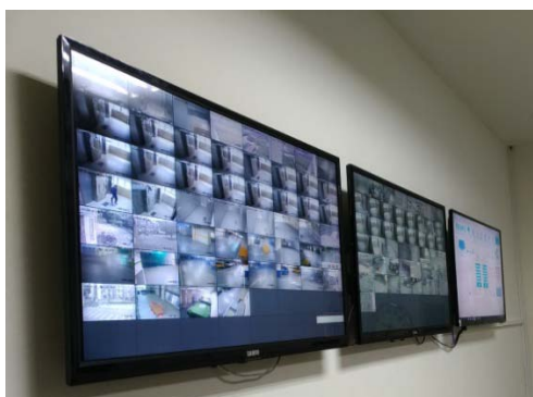
設置監控設備
