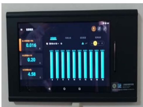
室內環境監控設備
