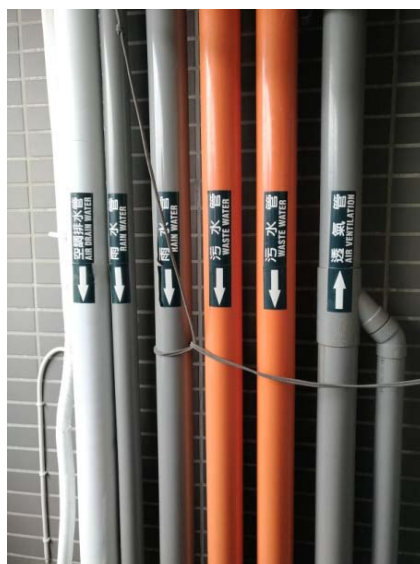
住戶陽台各類管道明管配置
