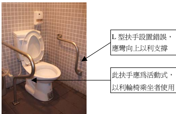
圖 2-2.3 廁所扶手設置不當例
