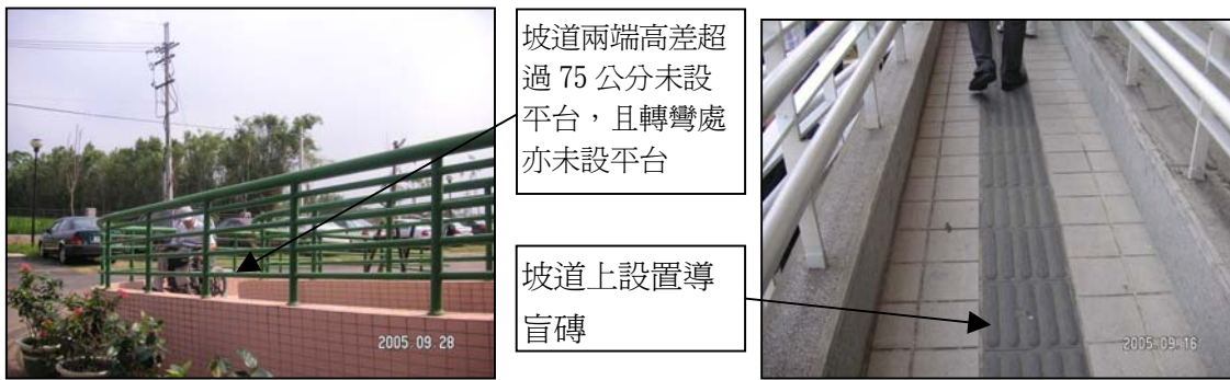
圖 2-2.1 坡道設置不當圖例之一
