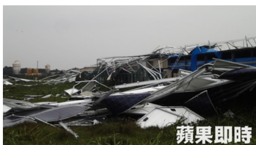
養鴨場屋頂的太陽能板慘遭摧毀。
