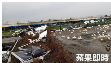
太陽能板飛到另處養鴨場水池。
