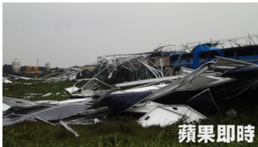
養鴨場屋頂的太陽能板慘遭摧毀。
