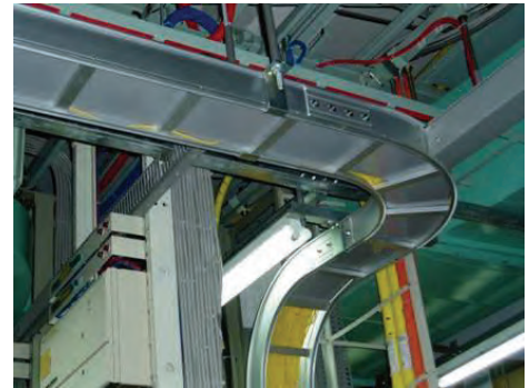
圖 1-4-1 綜合佈線設備室配線設施
