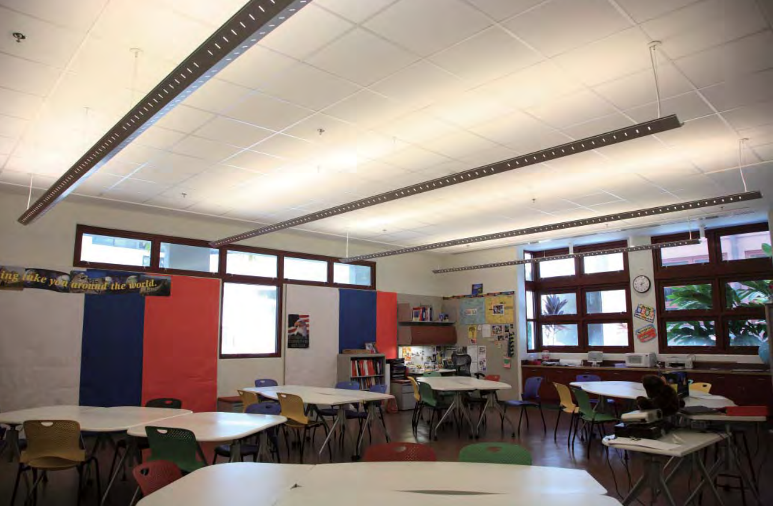
燈具全面裝設電子式安定器，並有感光裝置配合無段控制開關使用
