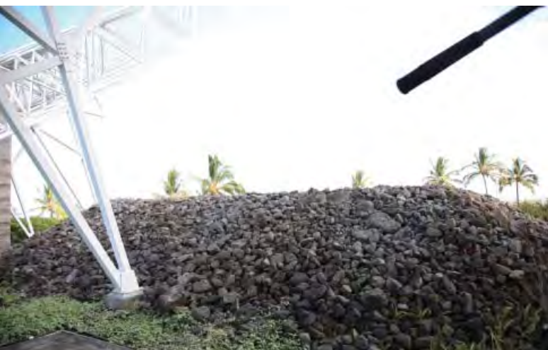
將冰冷海水送到本棟建築外的一處換氣口進行熱交換
