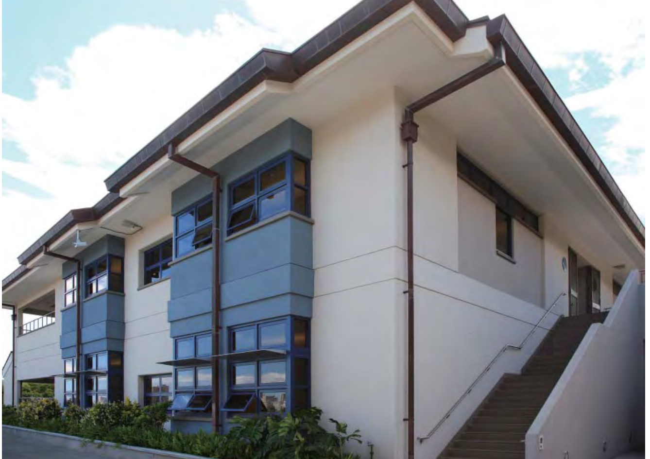
每棟建築物外均可見到外露的雨水回收管
