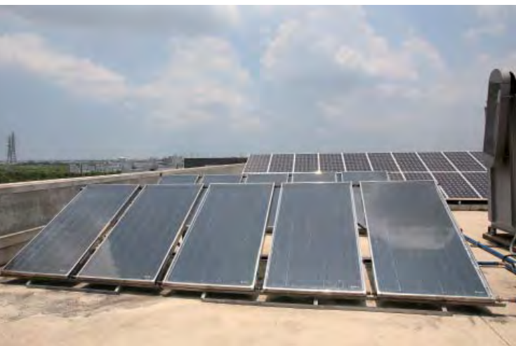
位於屋頂之太陽能光電板與熱水器，採用明管設計並設置於可拆卸固定架上，將來維修時無須傷及結構體
