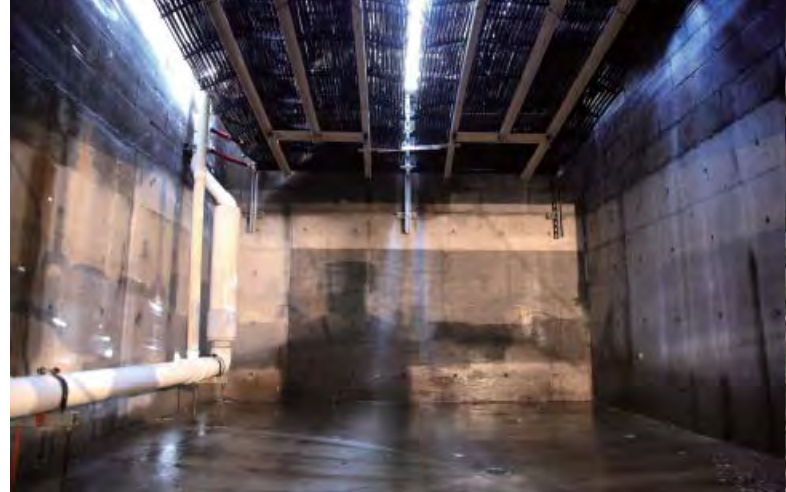
從換氣口下方處觀察，可看見管壁間滴下的冷凝水
