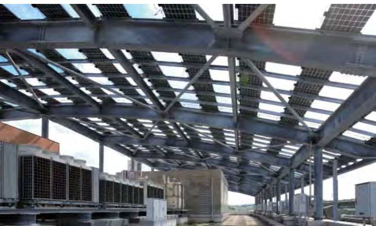
為了避免颱風季節強烈的風壓造成發電板損壞，光電板採取間隔的方式架設減少強風的威脅，並依據太陽移動的軌跡採弧形配置，以求最佳的發電效率
