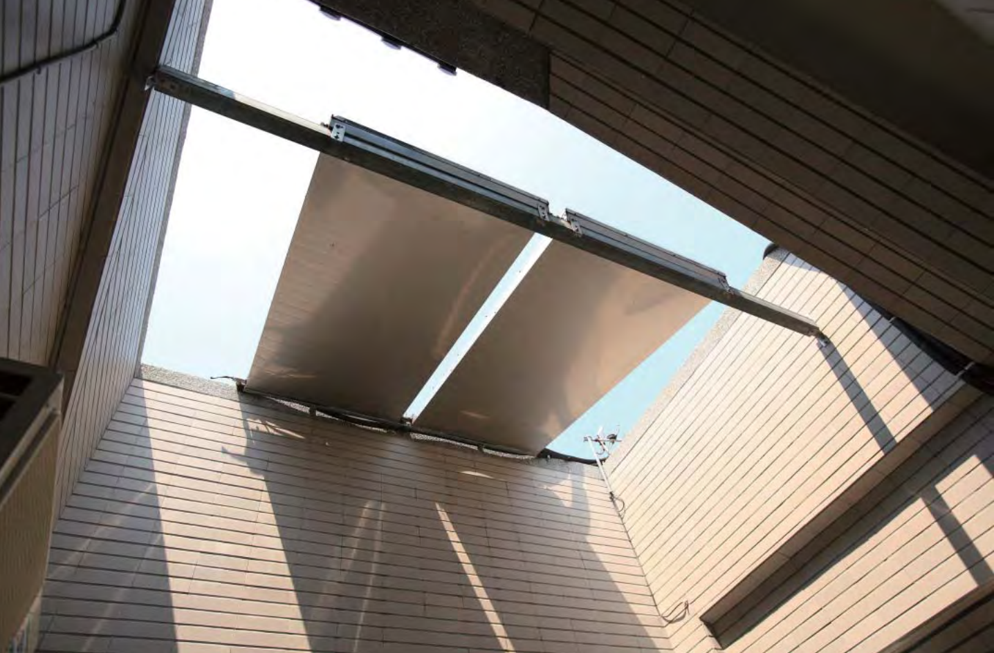
每一棟住宅的屋頂處設置太陽能集熱板，產生的熱水可供浴室與廚房使用
