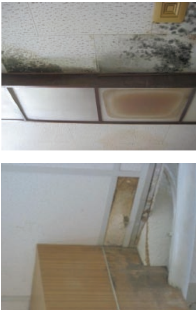
圖 2-20 因滲水導致室內牆面滋生霉斑及有明顯的滲水痕跡 (圖片來源：蘇慧貞教授提供)
