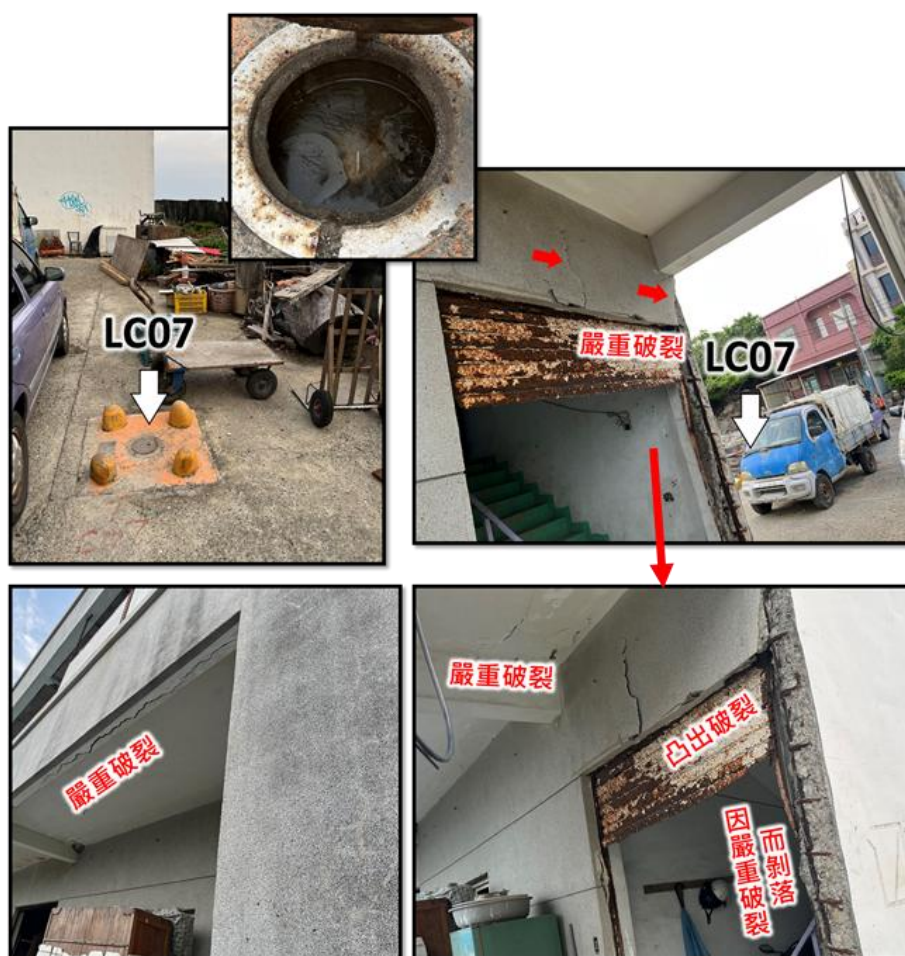
圖 11 點位 LC07 點位狀況與周圍環境。紅色箭頭指向裂隙的位置。
