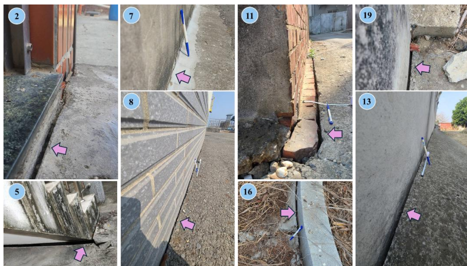
圖 2 嘉義縣義竹鄉北華村結構物破裂照片 (112/03/22 拍攝)。
