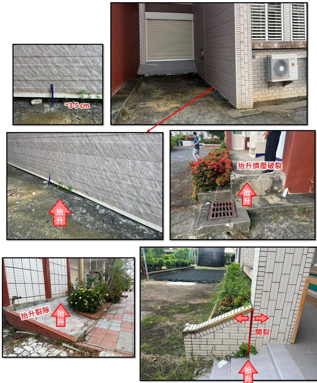
圖 7 點位 LC03 與 T293 周圍可能因泥體構造活動造成的破壞。
