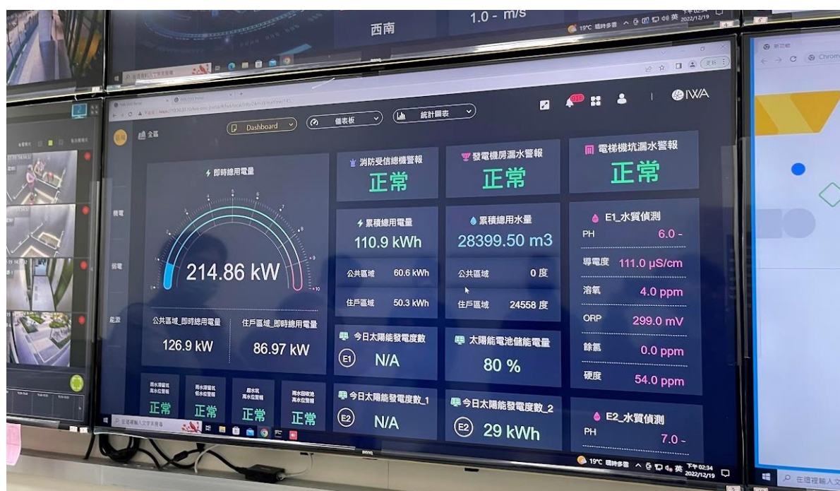
圖 5 廣慈公宅 E 區中控室顯示即時資訊與控制畫面
