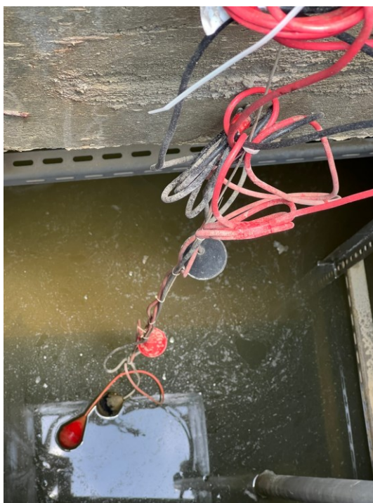
圖 3-13 臺北市信義區○○○○園區滯洪 C 池泵浦電纜浮球液位開關
