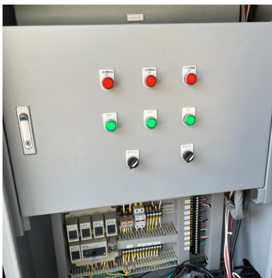
圖 3-12 臺北市信義區○○○○園區滯洪 C 池泵浦手動控制顯示盤
